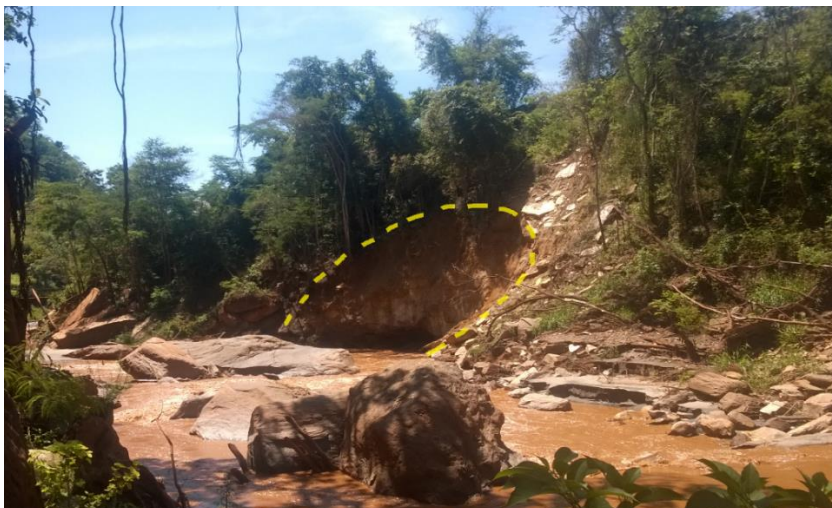
Figura 1: Ruptura circular ocorrida no talude da seção de projeto especial E-A24-01, vista de montante para jusante
