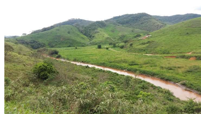
Serviços de bioengenharia executados na área prioritária 06- Barra Longa (MG) / (Crédito: Divulgação Fundação Renova).
