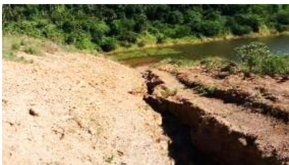
Processo erosivo instalado em canaleta não revestida.
