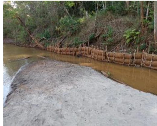
Contenção com o uso de biorretentores
