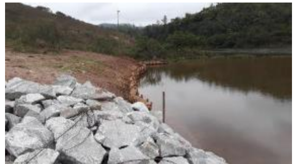
Local após limpeza do espelho d'água e conclusão do ponto de desague e instalação de biorretentores.
