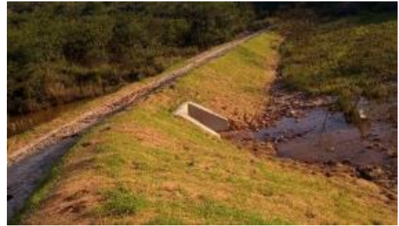
Visão de jusante do bueiro concluído e revegetação executada nos taludes e área marginal.
