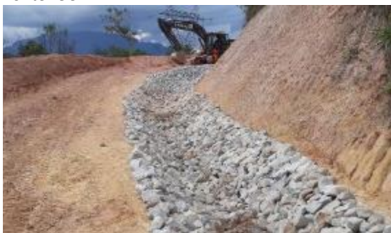
Visão parcial do local após a reconformação do acesso e instalação da canaleta.
