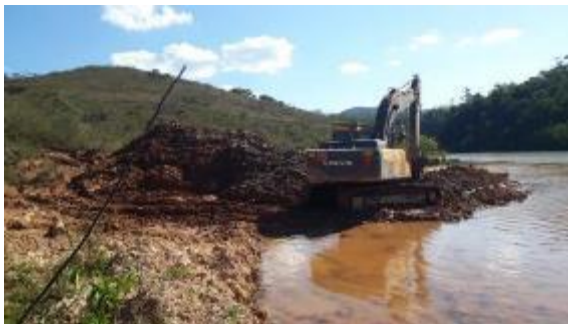
Remoção de sedimentos aportados no lago provenientes do acesso e da canaleta inacabada.
