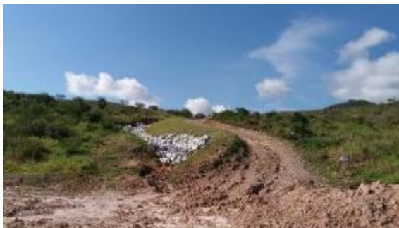
Canal de drenagem inacabado e acesso erodido (antes das intervenções). Fonte: GOLDER
