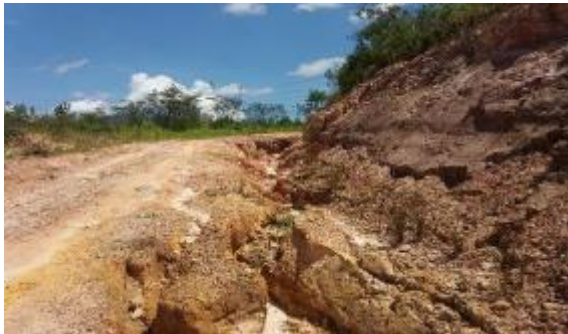
Visão do processo erosivo na base do talude antes das intervenções.
