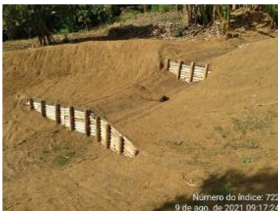
Revestimento de canaleta de drenagem em planície com biomantas e instalação de paliçadas
