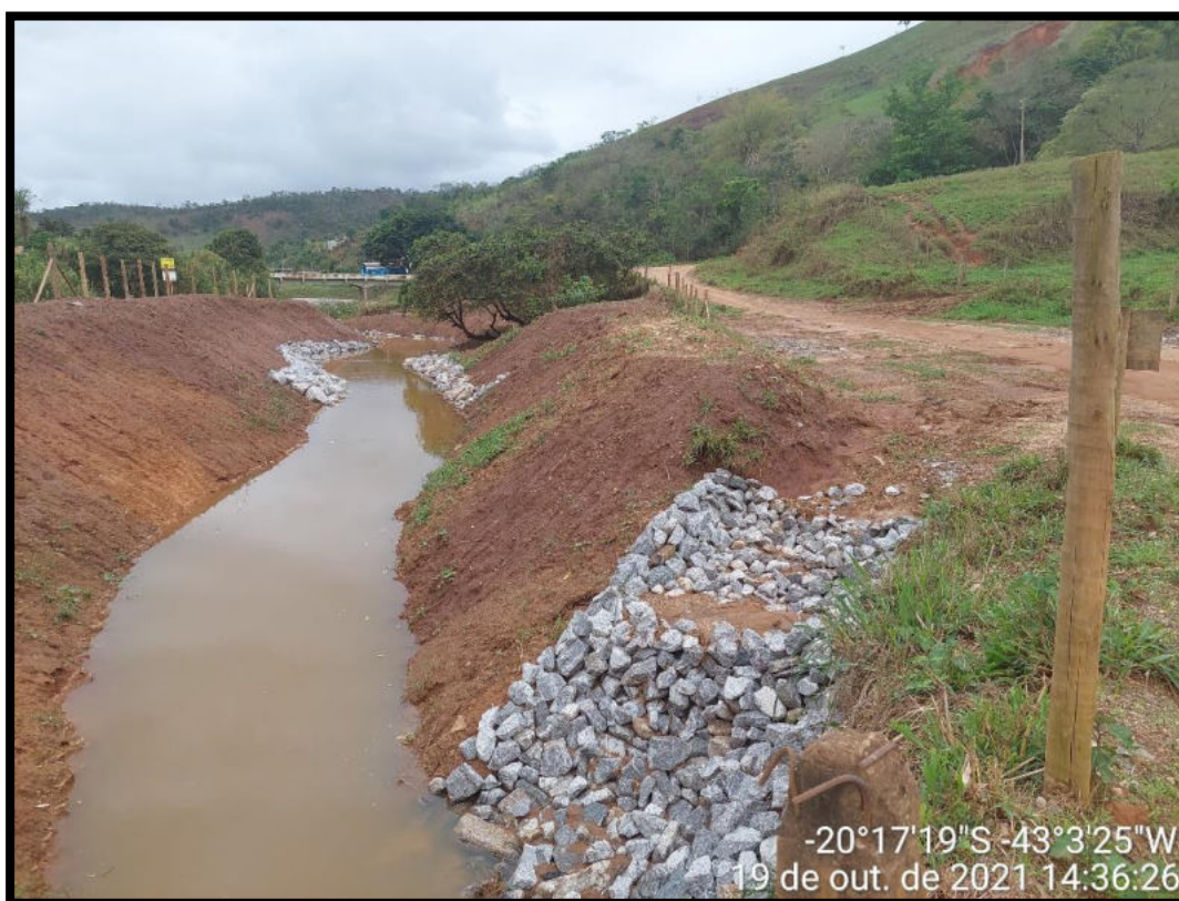
Figura 06: a) e b) obras de engenharia (enrocamento e conformação de leito de rio) em construção nas áreas no momento das vistorias.
