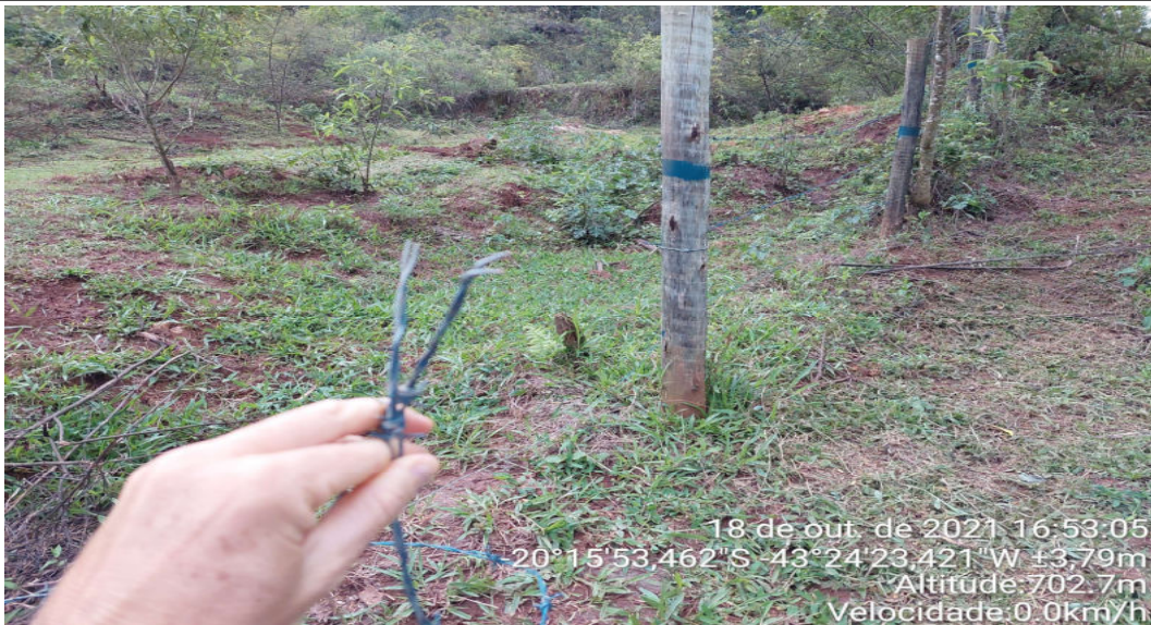
05. Cercamento rompido na área.
