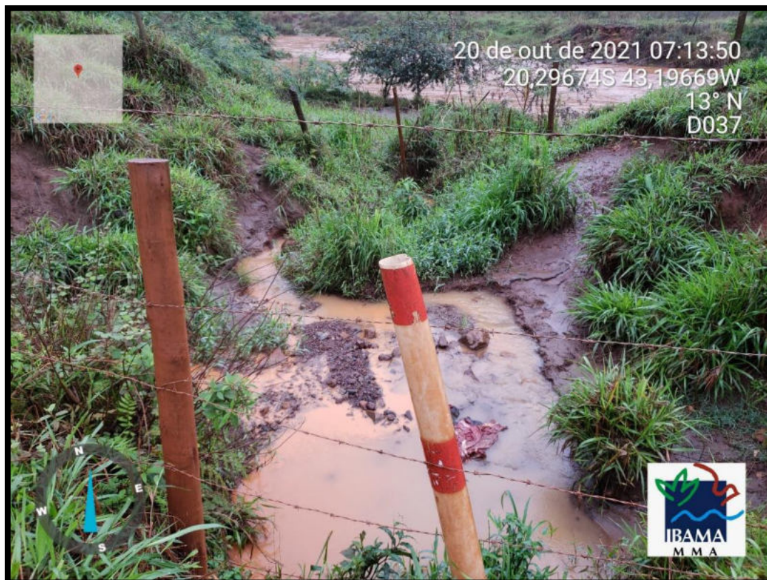
Figura 03: a) e b) Registros fotográficos com exemplos de áreas com processos erosivos.
