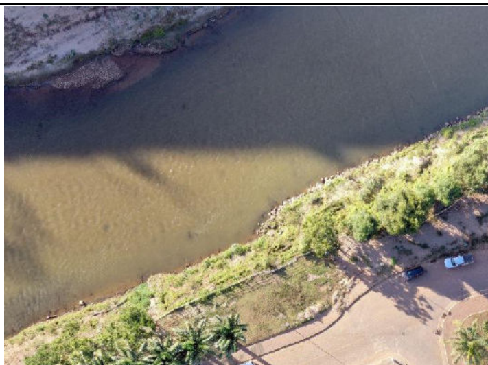
02. Imagem da área vitoriada. Necessidade de reparação da orla.
