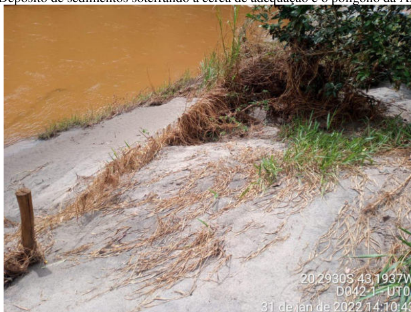
Figura 8 Depósito de sedimentos soterrando a cerca de adequação e o polígono da APP.
