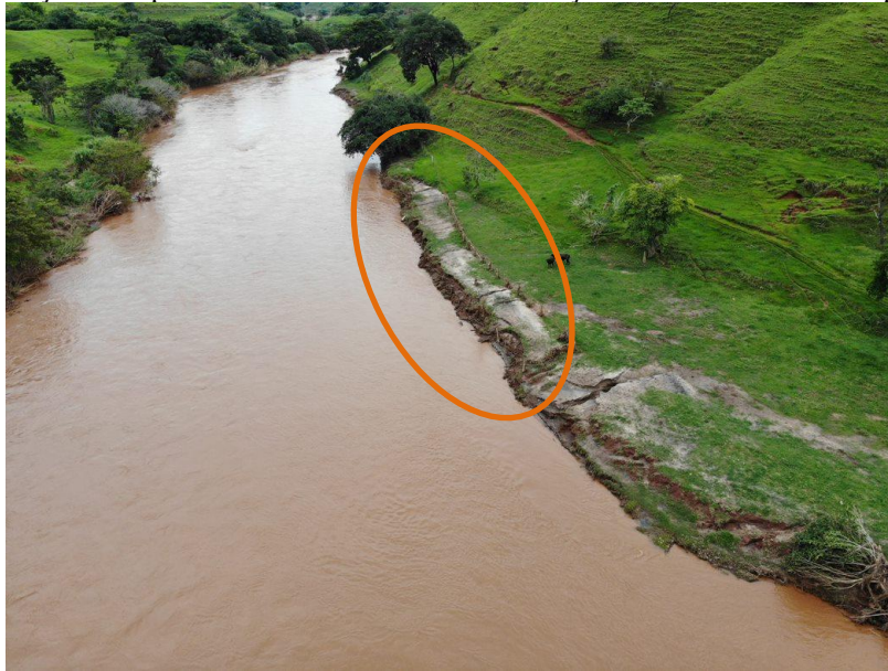
Figura 10 Indicação do depósito de sedimentos na UT e remoção de toda a cerca de adequação.
