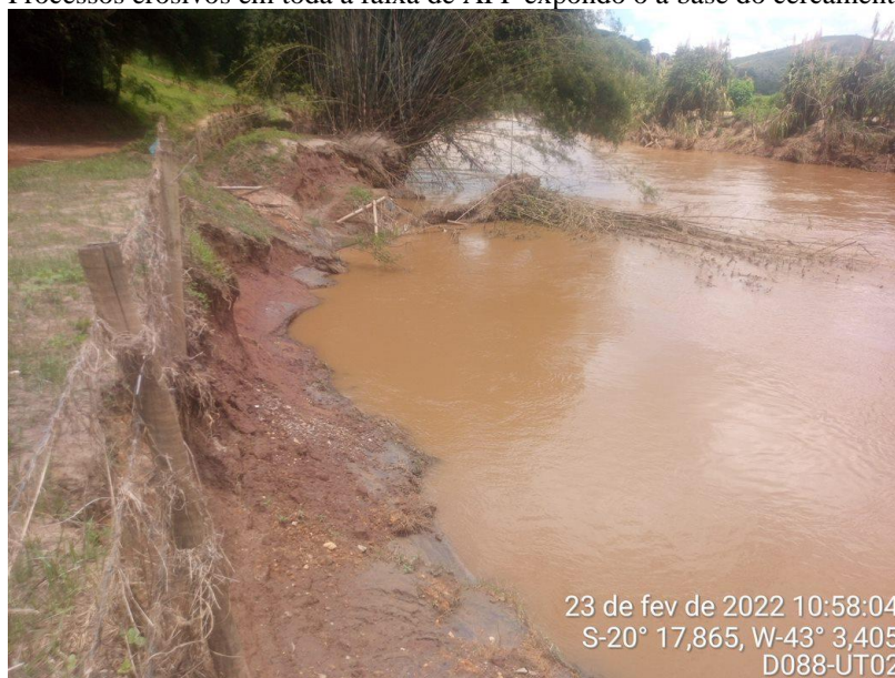
Figura 9 Processos erosivos em toda a faixa de APP expondo o a base do cercamento.
