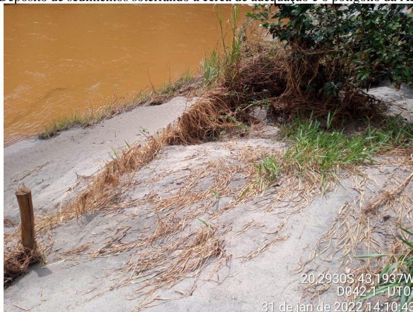
Figura 8 Depósito de sedimentos soterrando a cerca de adequação e o polígono da APP.
