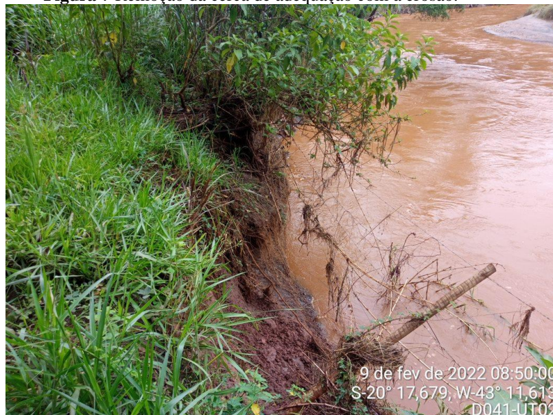
Figura 7 Remoção da cerca de adequação com a erosão.
