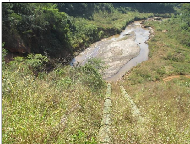
Foto 133: Detalhe do enroncamento e banco de rejeito
