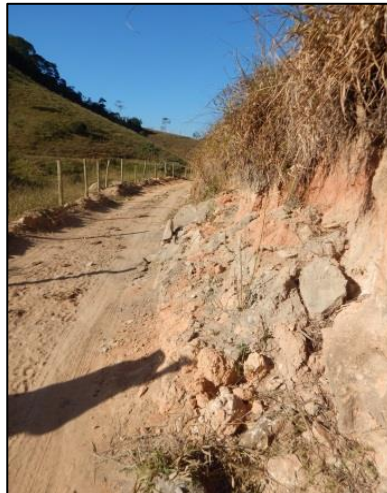
Foto 93: Desmoronamento do talude da estrada
