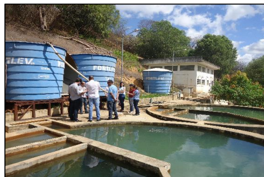
Foto 69: ETA de Itueta. Vista do Floculador, Decantador e Casa de Química.
