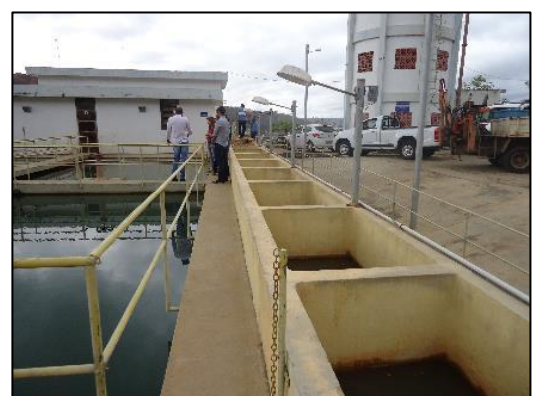
Foto 61: ETA de Resplendor. Detalhe do floculador e decantador.
