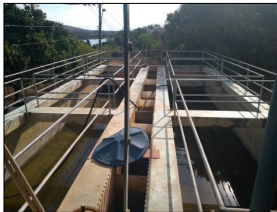
Foto 79: Vista parcial da ETA Mascarenhas, paralisada após o desastre ambiental.
