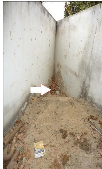
Foto 50: Poço Tubular construído emergencialmente e fora de operação.
