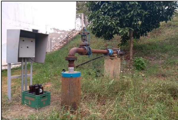
Foto 88: Poço tubular perfurado em caráter emergencial e interligado da captação de água no rio Doce para a ETA I.
