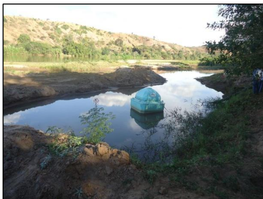
Foto 23: Captação de água por meio de flutuador no rio Doce.
