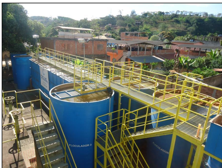
Foto 25: Vista da ETA Perpétuo Socorro/ Cachoeira Escura.
