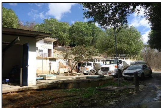
Foto 68: ETA sendo abastecida por caminhão-pipa com água bruta do Rio Manhuaçu.
