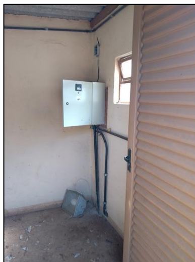
Foto 15: Abrigo do quadro de comando do poço.
