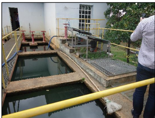
Foto 45: Floculador Mecanizado e Decantador.
