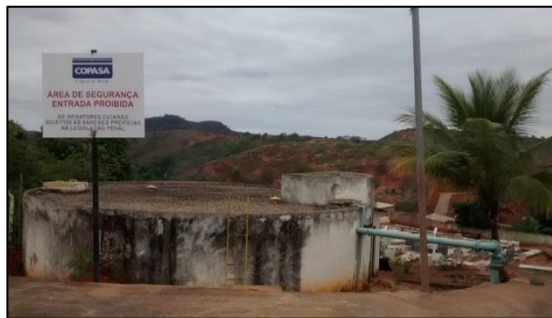
Foto 36: Reservatório localizado na área da ETA.
