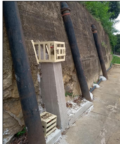
Foto 89: Detalhe da interligação da captação de água no rio Doce para a ETA I.
