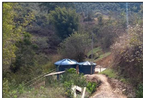
Foto 8: Reservatório intermediário de água bruta, em 2018.
