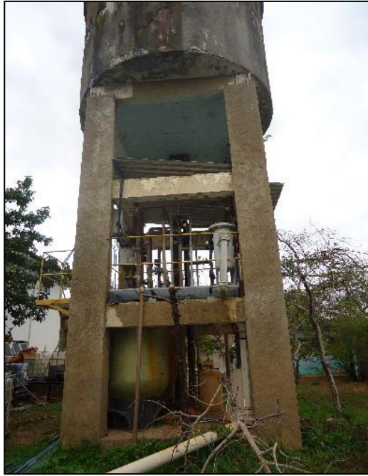
Foto 47: Reservatório Elevado para lavagem dos filtros da ETA. Sob a estrutura uma unidade de tratamento (Filtro) para poço tubular.
