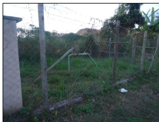
Foto 28: Poço tubular profundo - captação alternativa.
