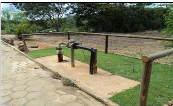
Foto 80: Poço profundo perfurado pela SAMARCO em 2015 e tamponado pela Fundação Renova em 2018.
