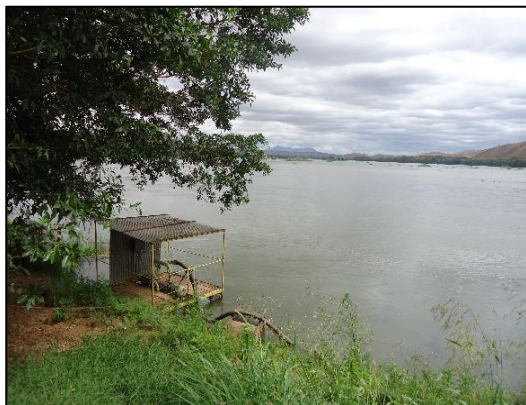
Foto 51: Captação e estação elevatória de água bruta flutuante no Rio Doce em operação.
