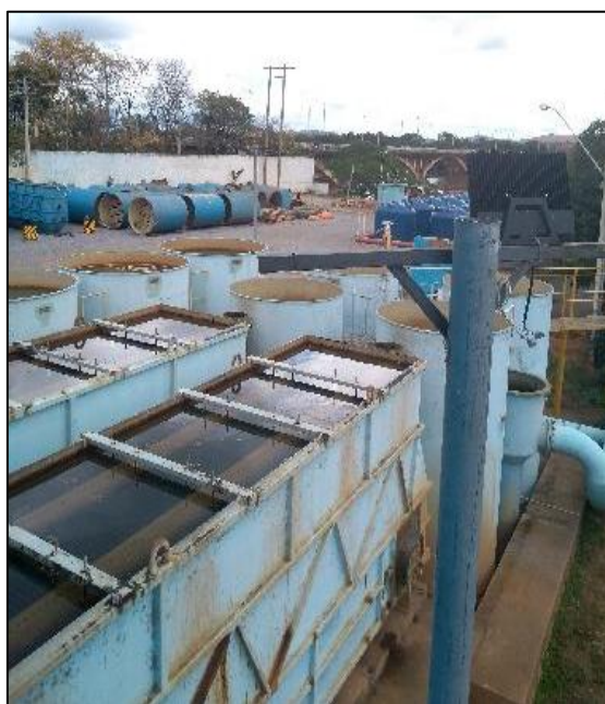
Foto 40: Vista da ETA Vila Isa em Governador Valadares.
