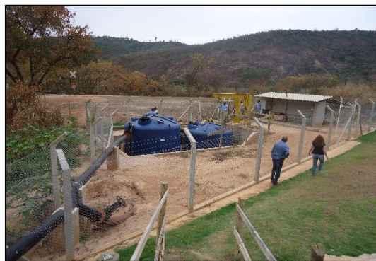
Foto 58: Reservatórios de água bruta que funcionam como poço de sucção.
