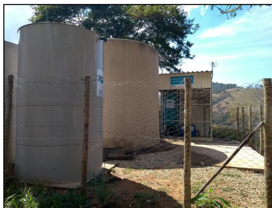
Foto 17: Sistema de tratamento de água instalado da localidade de Gesteira.
