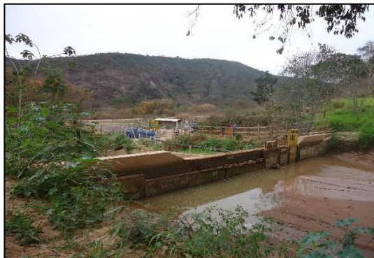
Foto 57: Captação no Córrego Barroso - Barragem de nível.
