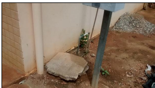
Foto 33: Grande parte das residências possuem cavaletes instalados, porém sem hidrômetros.
