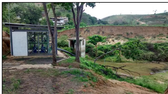
Foto 84: Captação alternativa. Adutora a partir do rio Santa Maria do Doce, entregue em novembro de 2017.
