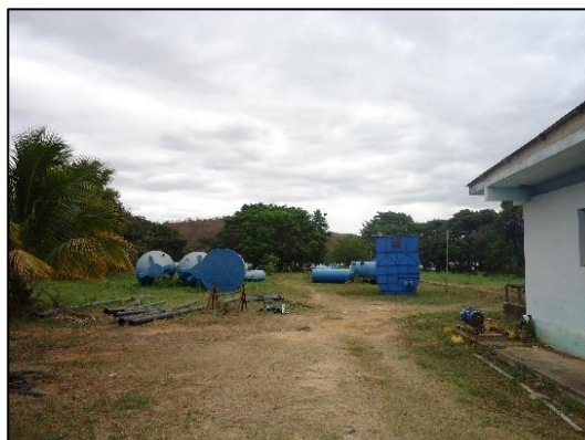
Foto 46: ETA Modular desmontada, aguardando a instalação.
