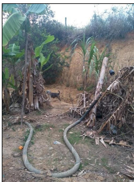
Foto 98: Entrada (desprotegida) da mangueira usada para transferir a água tratada dos caminhões-pipa até os reservatórios que abastecem a localidade de Boninsegna.
