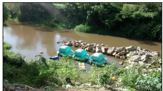
Foto 91: Detalhe dos flutuadores na captação alternativa.
