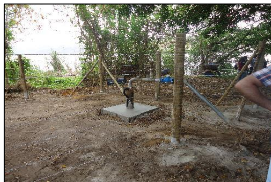
Foto 71: Poço Tubular construído como sistema alternativo para Itueta (fora de operação).
