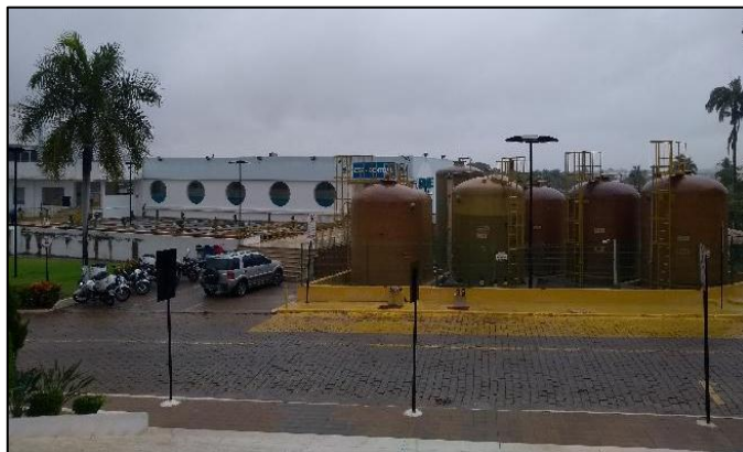
Foto 39: Vista da ETA Central de Governador Valadares.
