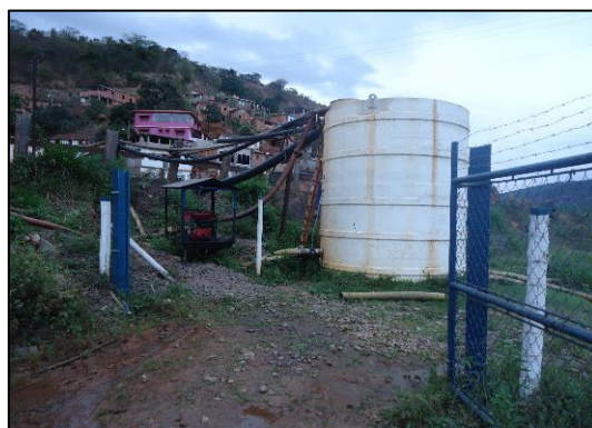
Foto 60: Reservatório de água bruta - Bombeamento alternativo para alimentar a ETA.
