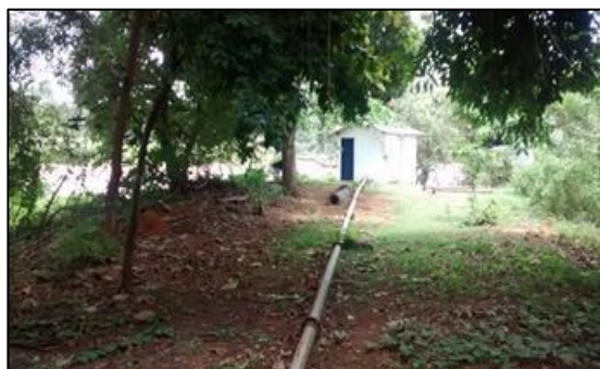
Foto 83: Caminhamento inicial da adutora de água bruta próximo à captação no rio Doce.
