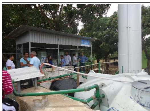
Foto 56: Estação de Tratamento de Água – Filtro de zeólitos e abrandador em operação.
