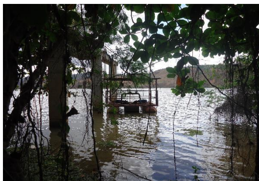
Foto 66: Captação no flutuante sobre o rio Doce fora de operação.
