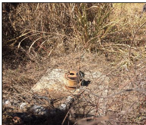
Foto 73: Poço Tubular perfurado como opção de captação alternativa e fora de operação devido depredação.
