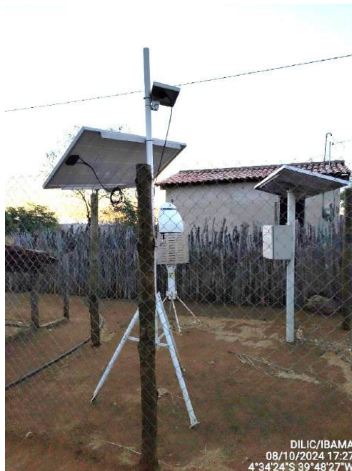
PMS 03-2 – Equipamentos instalados na Comunidade Cantina.
