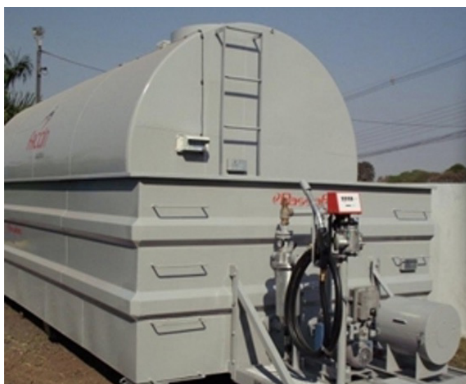
Bacia de contenção de vazamentos em tanque aéreo de combustível. Fonte: Lovatel (2014)
