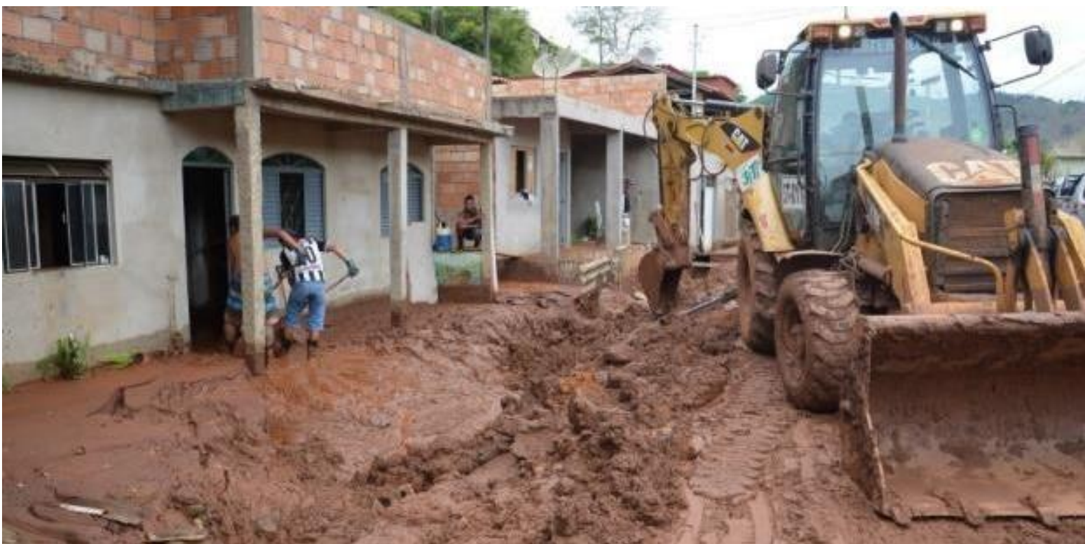
Foto 18 - Limpeza da Lama de Rejeito realizada por moradores (com ferramenta manual) e pela responsável pelo rompimento (com maquinário) na via pública em Barra Longa/MG Fonte: http://agenciabrasil.ebc.com.br
