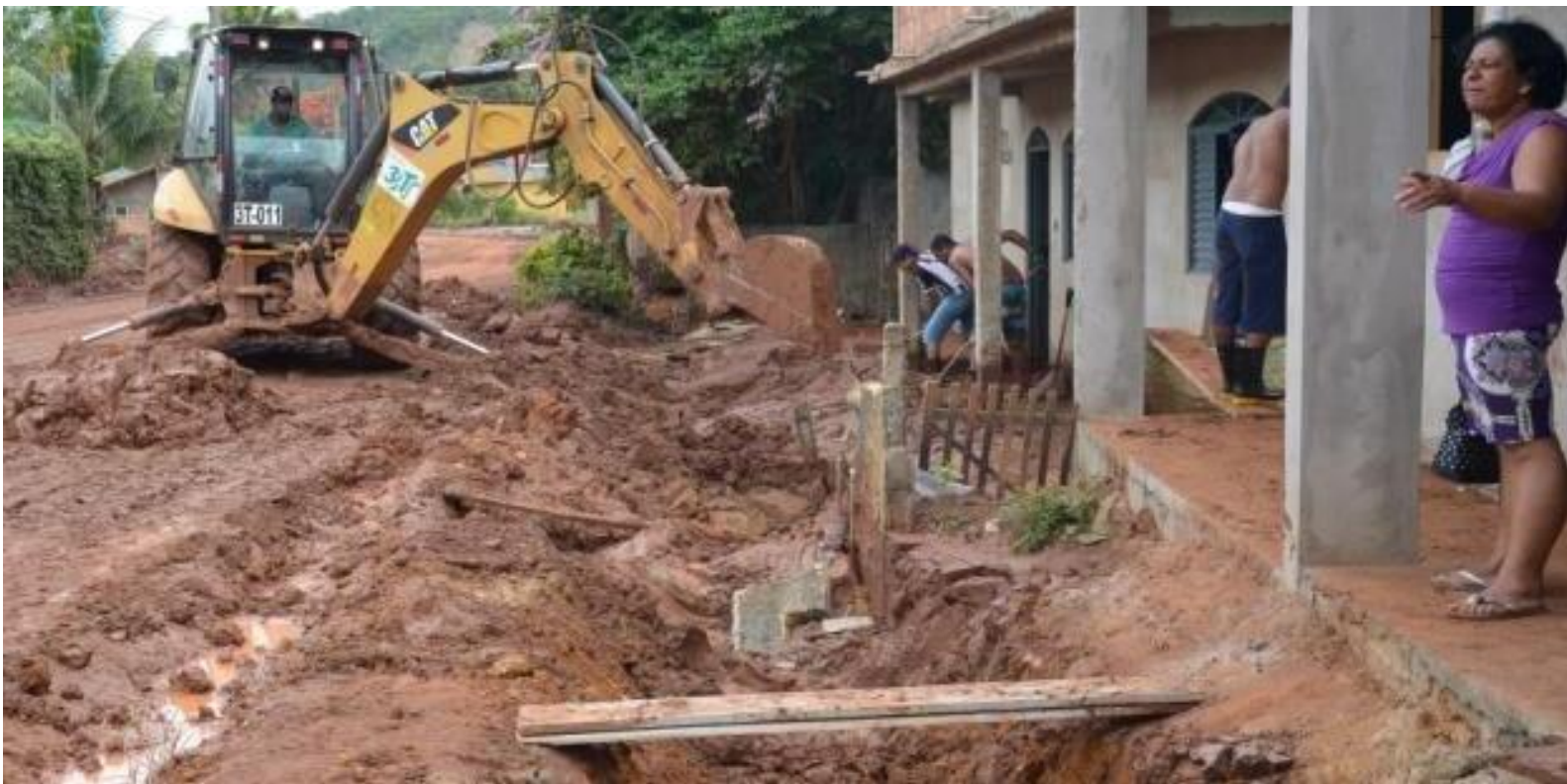
Foto 17 - Limpeza da Lama de Rejeito realizada por moradores (com ferramenta manual) e pela responsável pelo rompimento (com maquinário) na via pública em Barra Longa/MG Fonte: http://agenciabrasil.ebc.com.br
