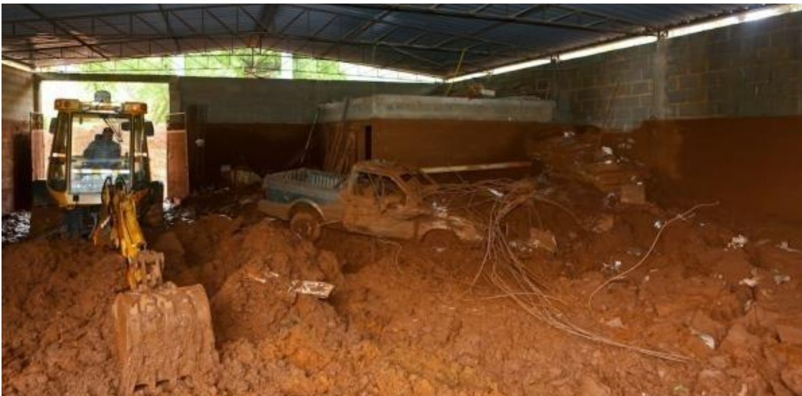
Foto 22 - Limpeza da Lama de Rejeito pela responsável pelo rompimento (com maquinário) no interior de um imóvel em Barra Longa/MG http://www.otempo.com.br
