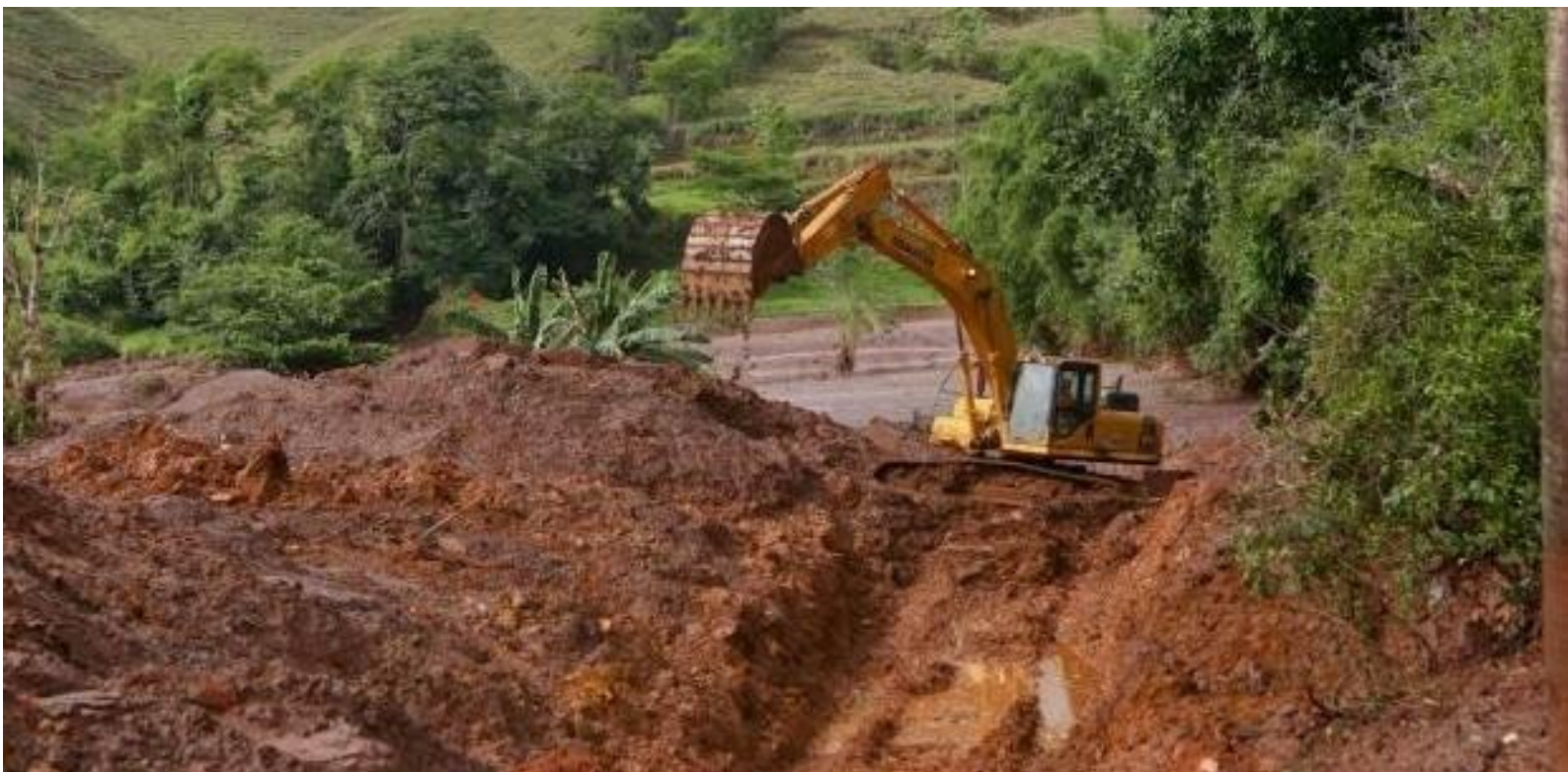
Foto 20 - Limpeza da Lama de Rejeito realizada pela responsável pelo rompimento (com maquinário) nas proximidades do Rio do Carmo em Barra Longa/MG http://www.otempo.com.br
