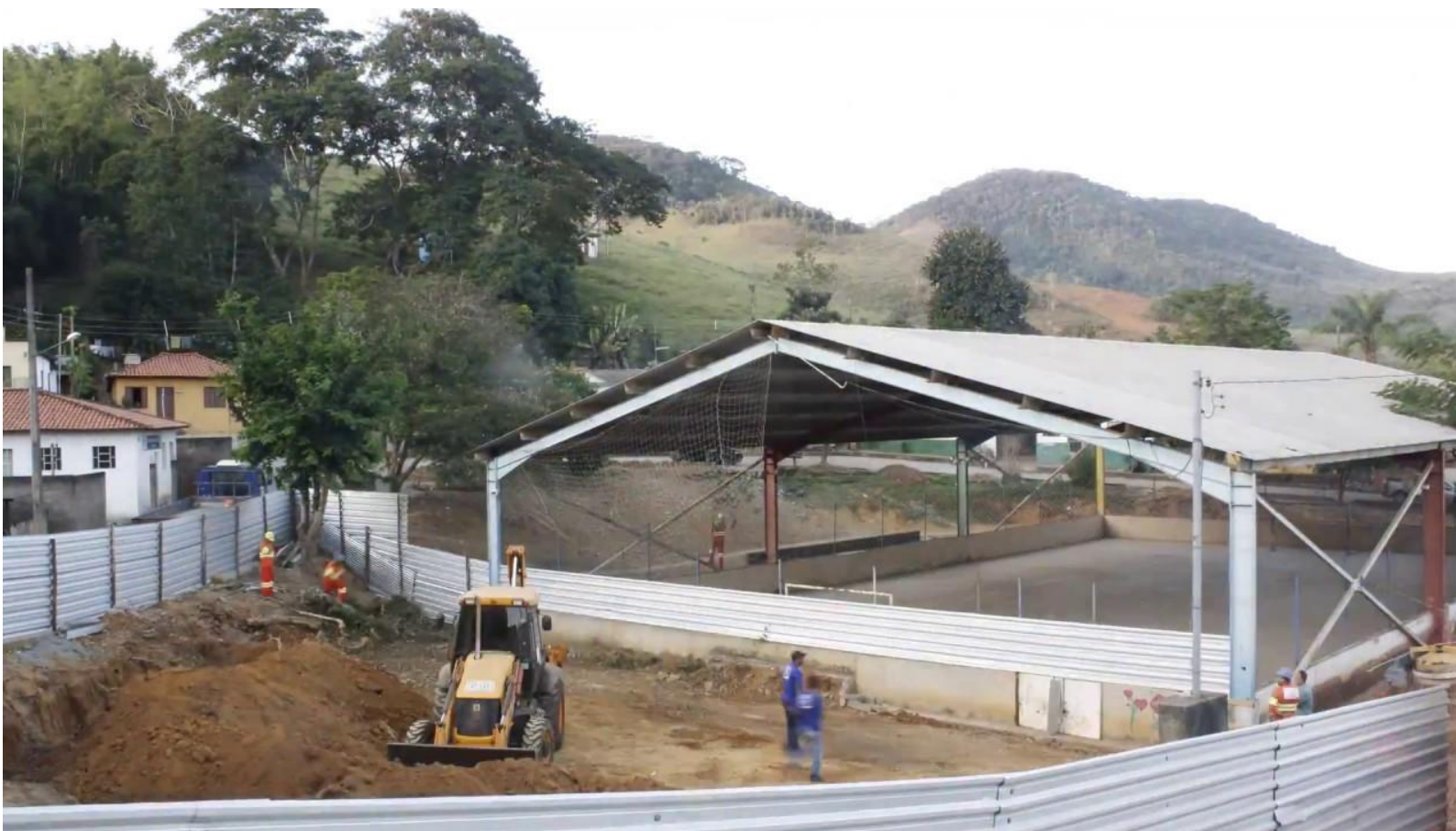
Foto 24 – Construção da escola no distrito de Gesteira pertencente ao município de Barra Longa/MG.
