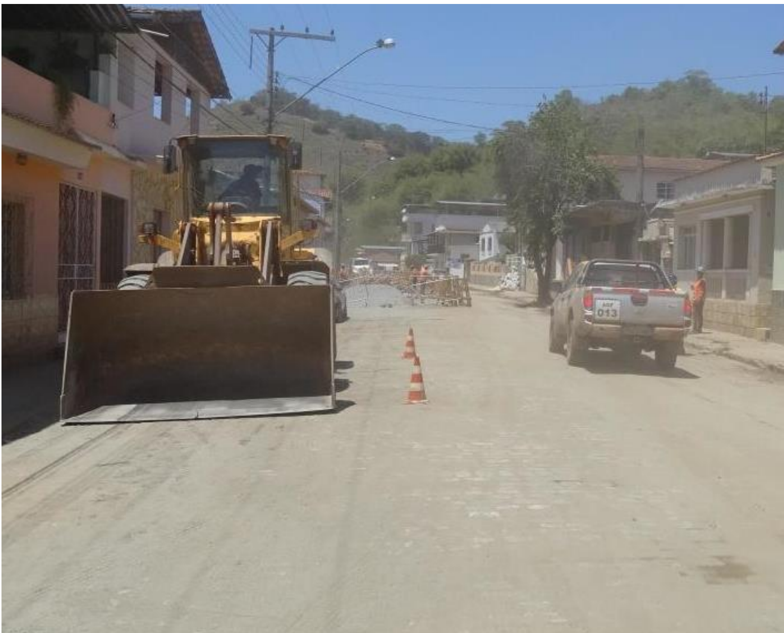
Foto 35 - Maquinário e caminhonetes de firmas contratadas para reparação da cidade de Barra Longa/MG
