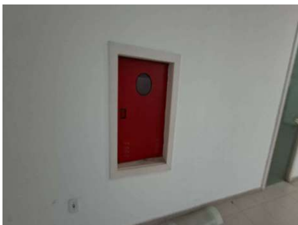
Figura 12 - Instalações de incêndio
