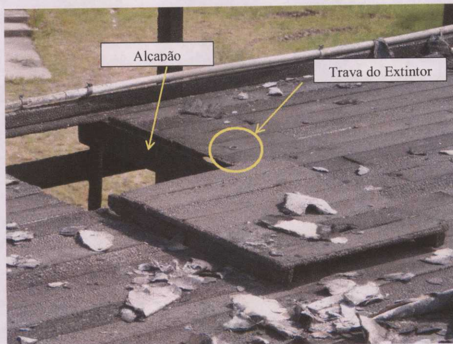
Figura 13. Alçapão de acesso ao redutor da célula 8. Ao lado pode ser visualizada a trava do extintor deixada pelos funcionários da RVT. Foto do dia 23/10/14, Perícia IGP.
