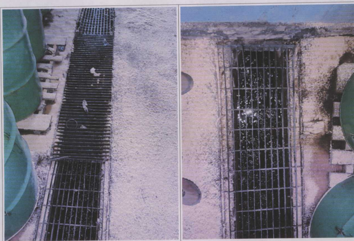
Figura 8B – Seção Interna – Resíduos Classe I – Compostos Orgânicos. Identificada contaminação por óleo do piso e canaleta de drenagem.
