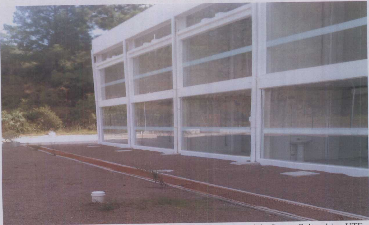
Presença de outro poço de monitoramento, com vista para a lateral do Centro Cultural (ex-UTE Candiota I).
