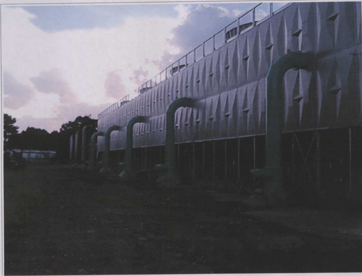
Figura 7 – Nova Torre de Refrigeração a Úmido do Vapor das Fases A e B.
