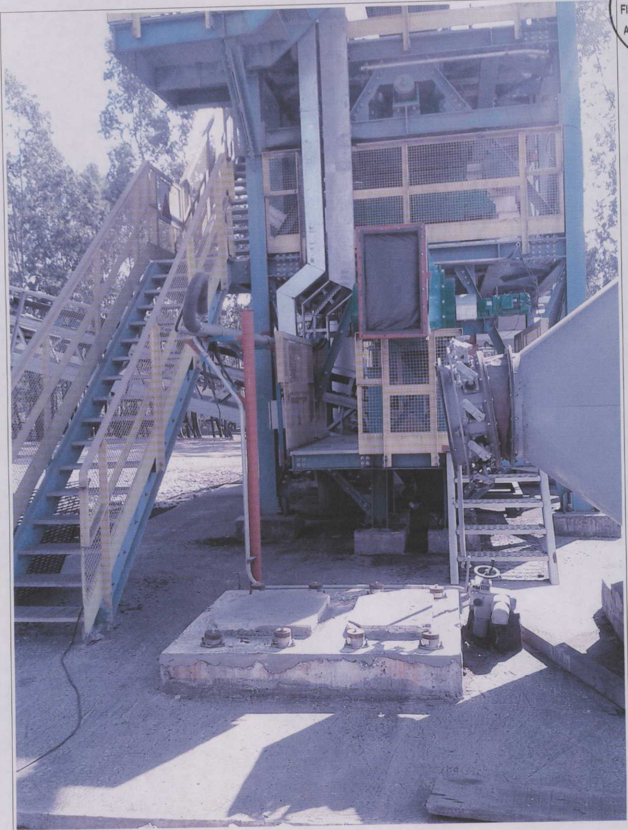
Figura 1B - Ventilador do Processo de Jigagem a seco de carvão temporariamente fora de operação, aguardando adequações de projeto.
