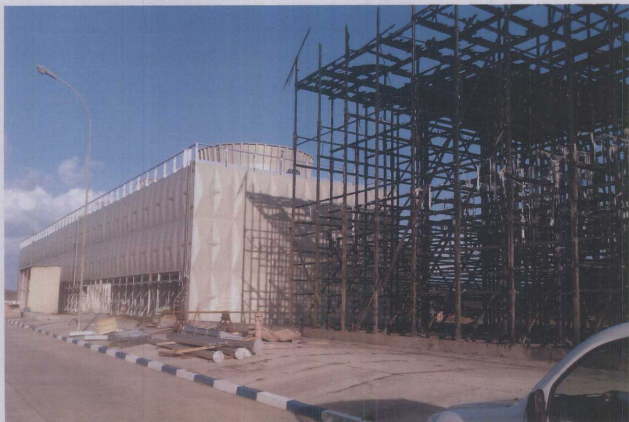
Torre reconstruída da Fase A, ao lado da torre destruída pelo fogo.
