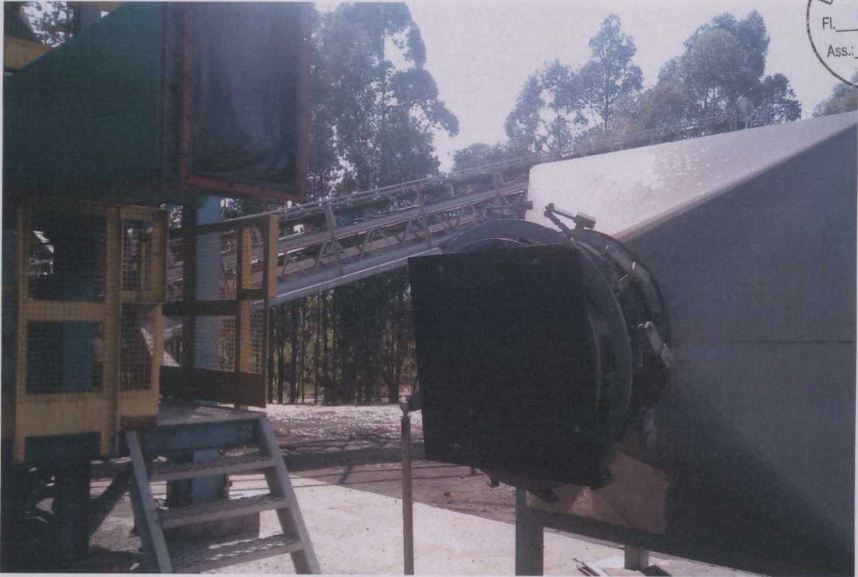
Problemas com o soprador do Processo de Jigagem a seco de carvão temporariamente fora de operação, aguardando adequações de projeto.
