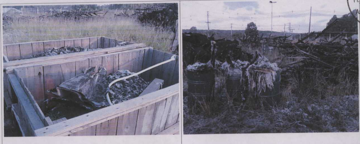
Figura 6C – Entulho de recheio e fibra de vidro gerado no acidente com a Torre de Refrigeração
