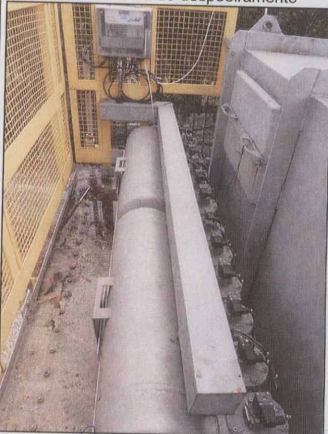
Válvulas do sistema de despoeiramento
