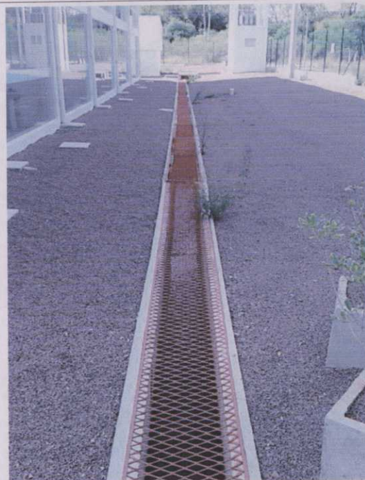
Figuras 4A – Ponto de lançamento de provável contribuição de efluentes domésticos da Vila Residencial na canaleta de drenagem do Centro Cultural Candiota I.
