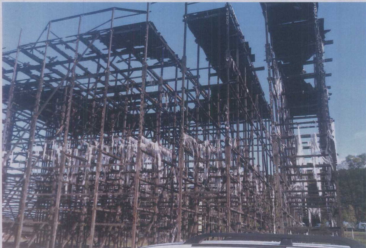
Resultado do incêndio na Torre de resfriamento da Fase A, ocorrido no dia 20 de outubro de 2014.
