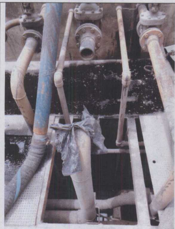
A.2. Rompimento de Válvula de transferência. Contaminação de pavimento e dispositivo de coleta de drenagem superficial.
