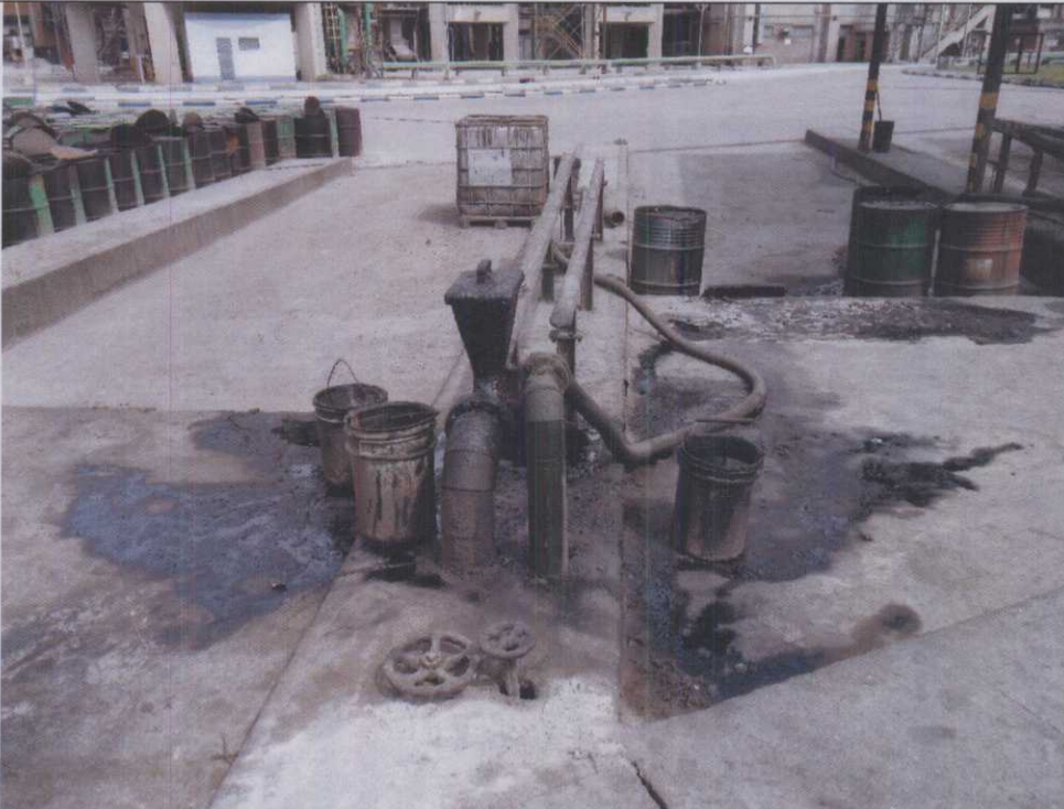
A.7. Vazamento em Válvula de Transferência da Estação de Abastecimento da Tancagem de Óleo Combustível. Contaminação da pavimentação e dispositivo de coleta de drenagem superficial.
