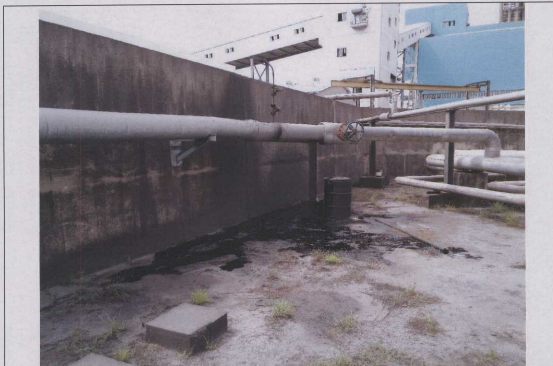
A.5. Vazamento em Válvula de Transferência no interior da Bacia de Contenção do Tanque Primário de Óleo Combustível.
