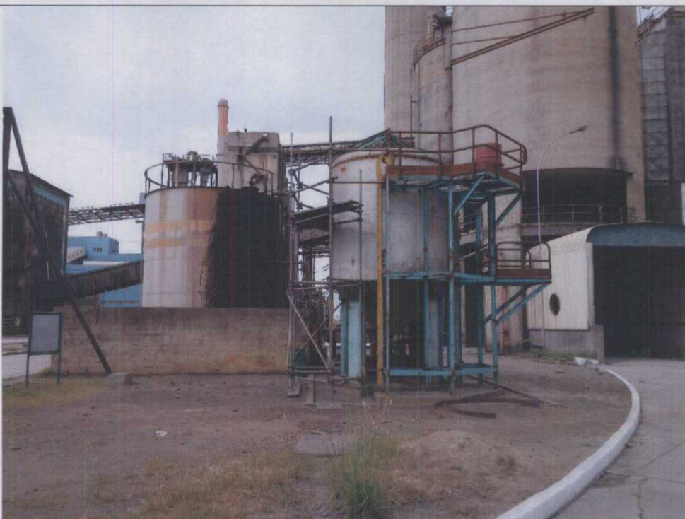
A.11. Inoperabilidade do Sistema de Recuperação de Óleo Combustível.
