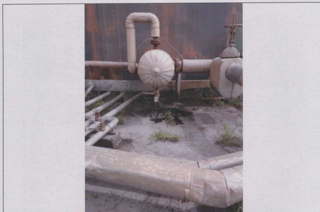
A.6. Vazamento em Válvula de Transferência do Tanque Primário de Óleo Combustível. Contaminação da Bacia de Contenção.
