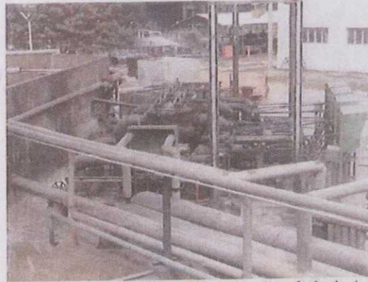
Figura 04 – Bombas de recebimento e transferência de F.O.
