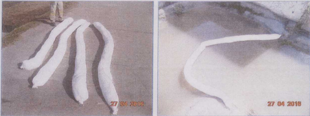
Figura 24. Barreiras absorventes instaladas junto as Bacias de Sedimentação.
