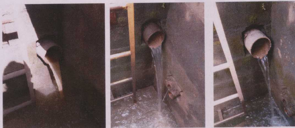
Figura 8: Evolução do efluente oriundo do pré-tratamento da água após remoção do lodo no decantador centrífugo.
