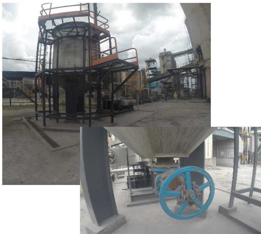
Figura 1. Tanque construído para operação do sistema de reaproveitamento de óleo sem bacia de contenção. Destaque para corrente instalada pela CGTEE que evidencia o lacre à sua operação.
