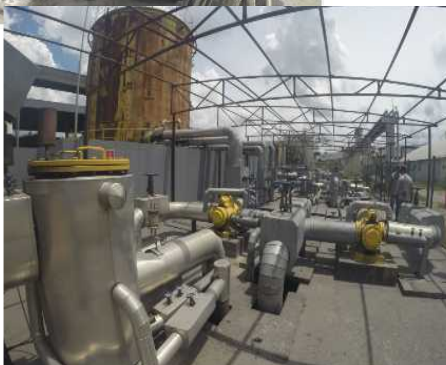
Figura 8. Evidências de troca de equipamentos, limpeza e construção de bacia de contenção e telhados em áreas de recebimento e transferência de óleo
