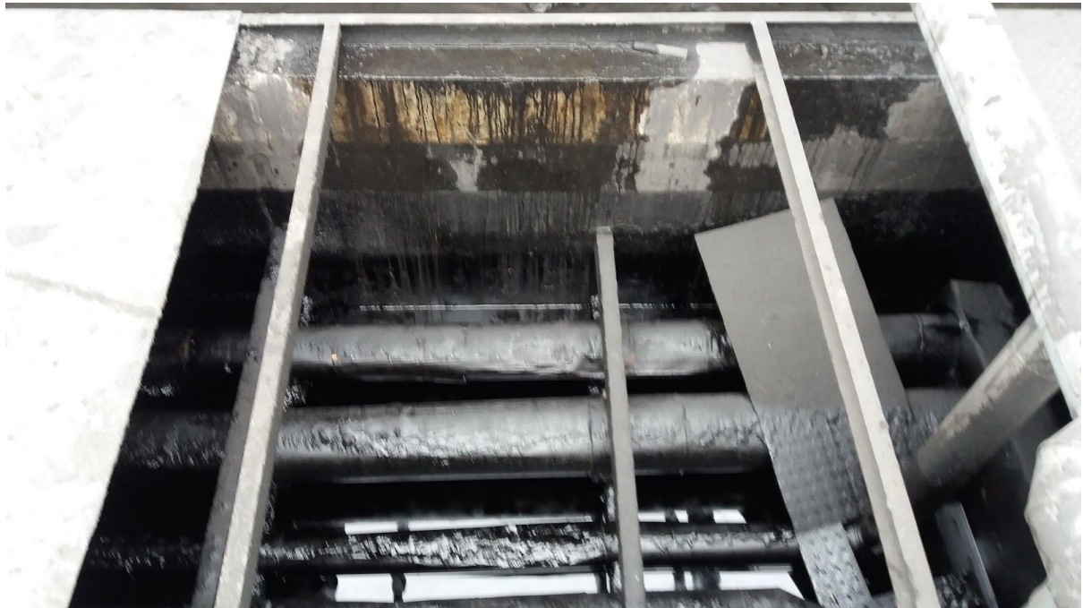
Figura 73: Ponto 4 da figura 56 – Registro óleo na drenagem localizada no sistema de armazenamento e bombeamento de óleo da fase C
