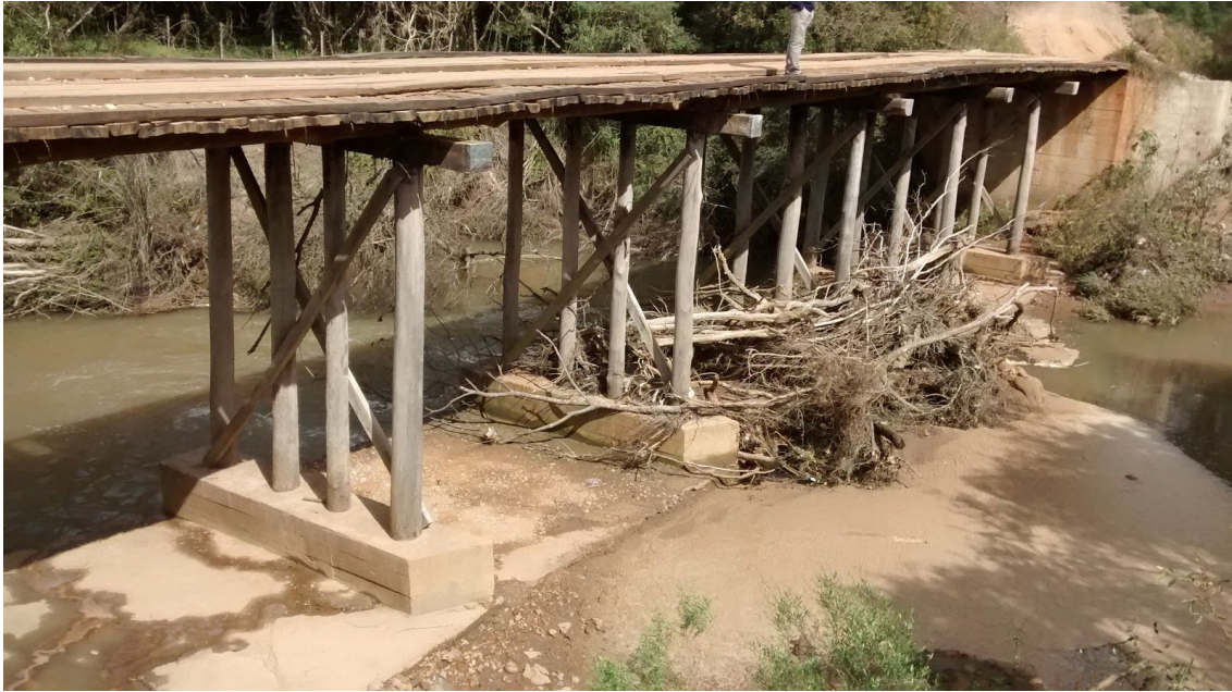
Figura 80. Ponto de Monitoramento 6 (PM6); Destaque para o acúmulo de galhos e espuma marrom.
