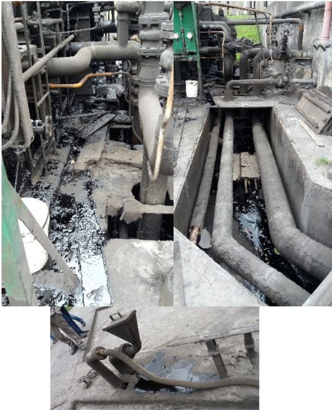
Figura 68: Ponto 4 da figura 56 – Registro de vazamentos de óleo e presença de óleo na drenagem da área de recebimento e transferência de óleo
