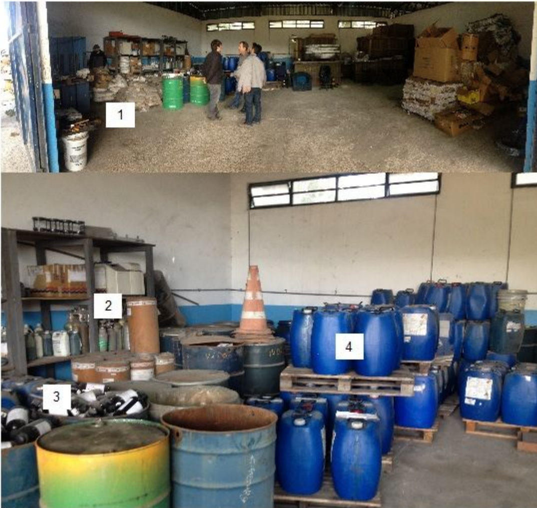
Figura 46 - Vista do primeiro compartimento da Central, não destinada aos resíduos Classe I, com destaques de acondicionamento inadequado de resíduos perigosos, conforme detalhado nas próximas fotos
