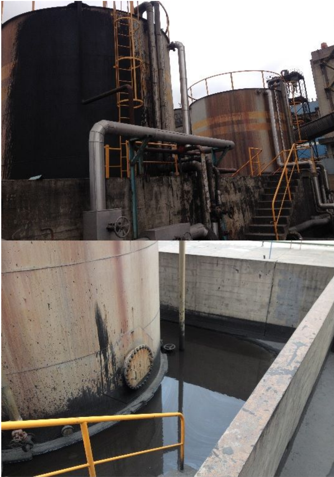
Figura 67: Ponto 3 da figura 56 – Registro de iridescências de óleo na de bacia de contenção no tanque de fuel oil
