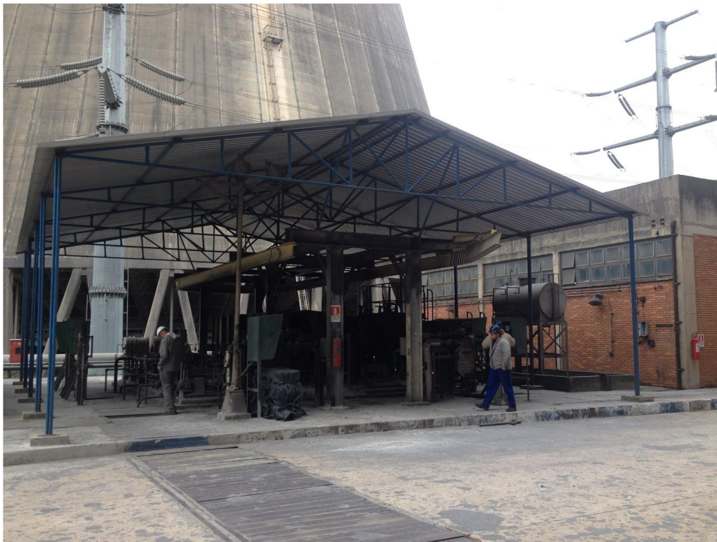
Figura 62: Ponto 2 da figura 56 – Caldeira da fase A onde, segundo informado pelos funcionários da empresa, há a contaminação de óleo na drenagem de fundo devido ao mau funcionamento da tremoia quando do acendimento da fase A.
