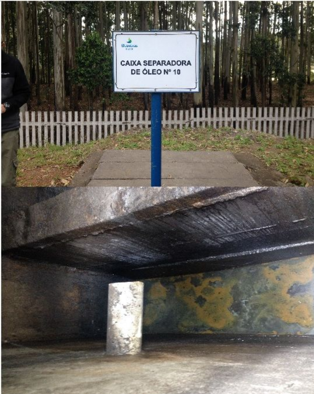
Figura 54: Evidência de presença de óleo no último compartimento da Caixa separadora de água e óleo que coleta efluentes da área da central destinada para o acondicionamento de resíduos classe I. Não foi identificado para onde a tubulação de saída em destaque na foto descarrega o efluente após sua passagem pela caixa.
