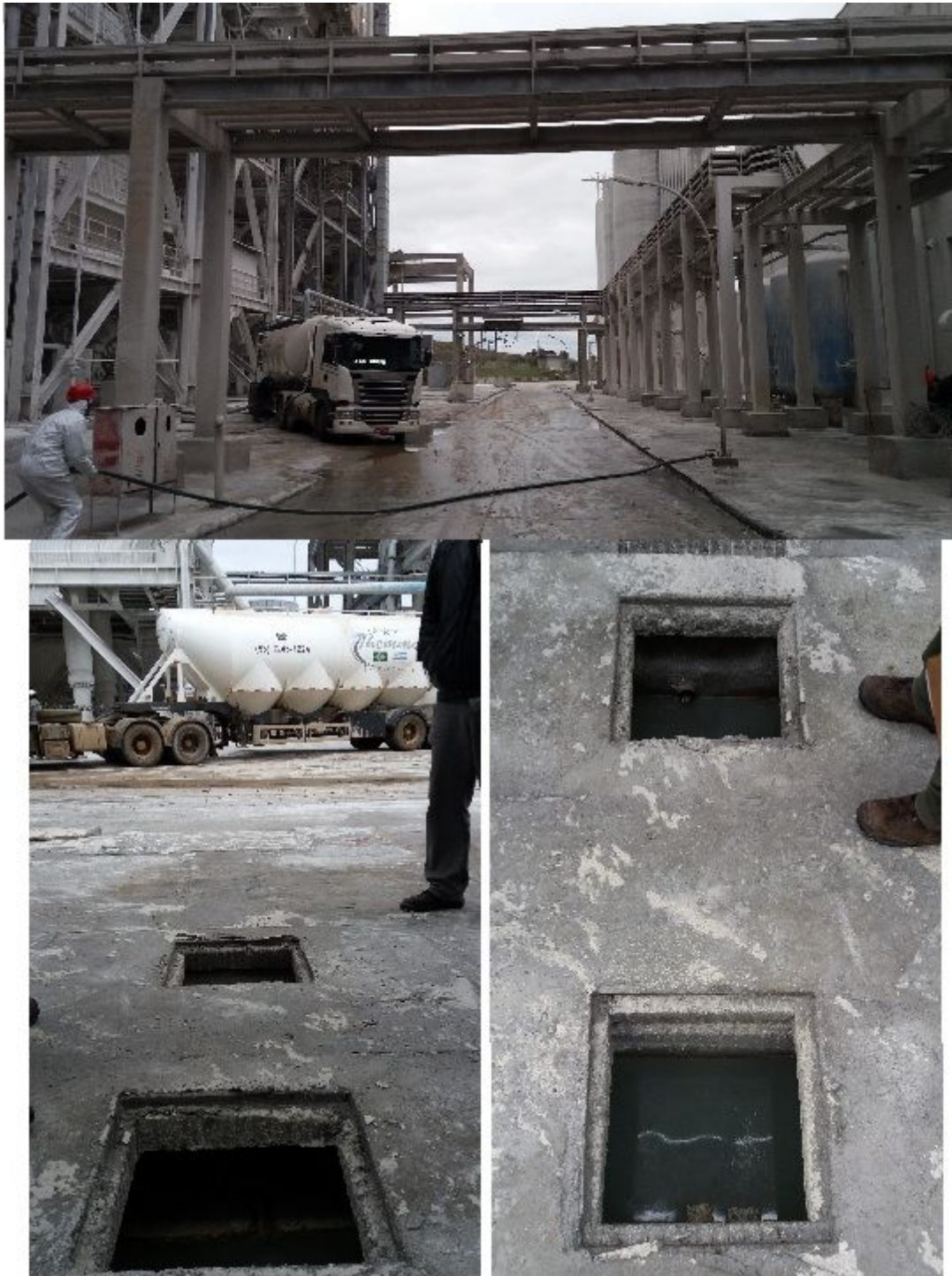
Figura 74: Ponto 5 da figura 56 – Caixa SAO localizada na fase C sem indícios de óleo
