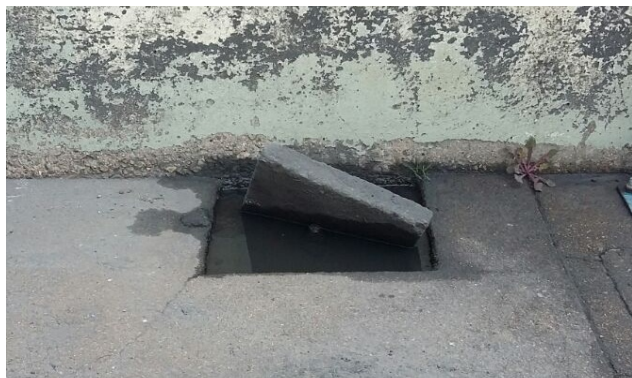
Foto 11. Válvula da caixa estanque do reservatório de óleo diesel afogada, junto às CSAOs 1, 2 e 4.
