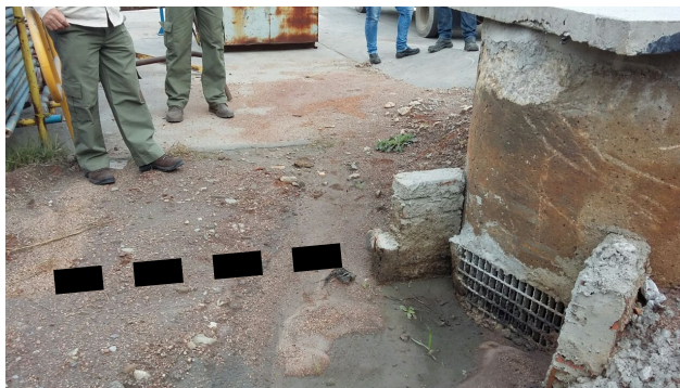
Foto 12. Boca de lobo recebe drenagem pluvial que anteriormente atingia a CSAO 06. Recomenda-se manutenção da vala de drenagem e instalação de barreira para retenção de sedimentos (linha tracejada).
