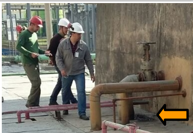
Foto 15. Pequeno vazamento de óleo junto à válvula de entrada do tanque de óleo diário da Fase B.
