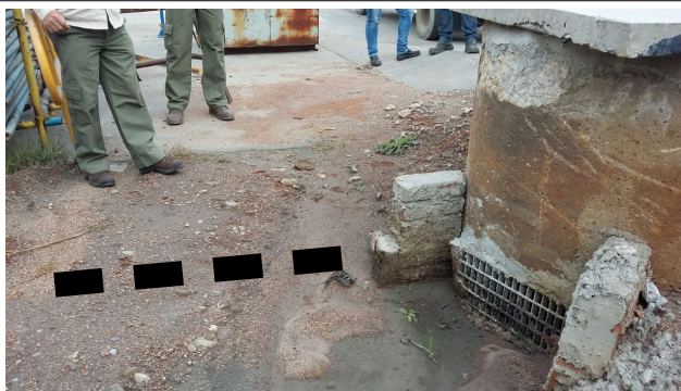
Foto 12. Boca de lobo recebe drenagem pluvial que anteriormente atingia a CSAO 06. Recomenda-se manutenção da vala de drenagem e instalação de barreira para retenção de sedimentos (linha tracejada).
