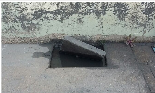
Foto 11. Válvula da caixa estanque do reservatório de óleo diesel afogada, junto às CSAOs 1, 2 e 4.
