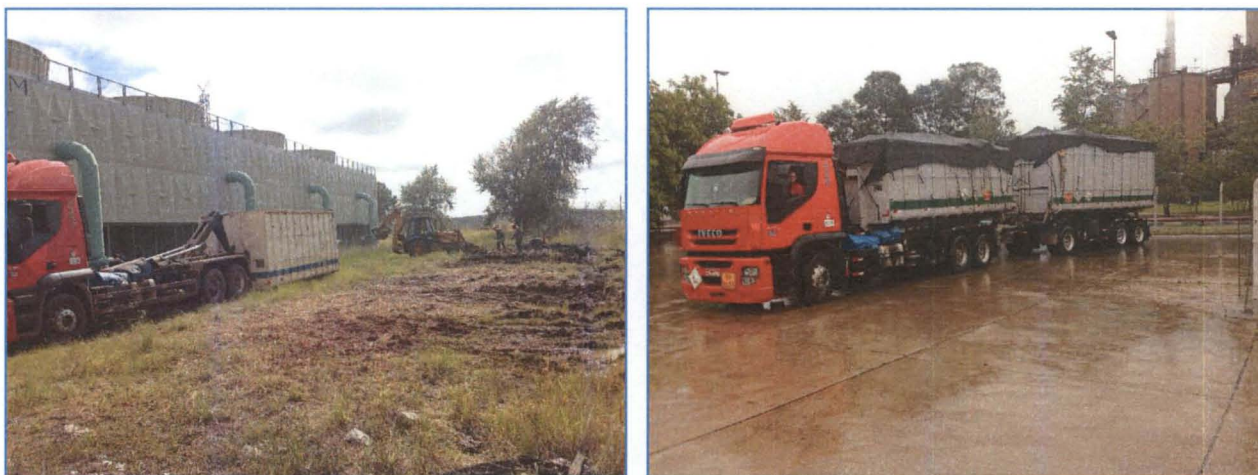
Figura 18. Carregamento e Transporte de Resíduos do Sinistro na Torre de Refrigeração da Fase A.
