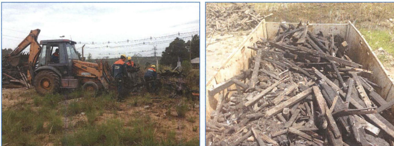
Figura 17. Carregamento de Resíduos de Madeira do Sinistro na Torre de Refrigeração da Fase A.
