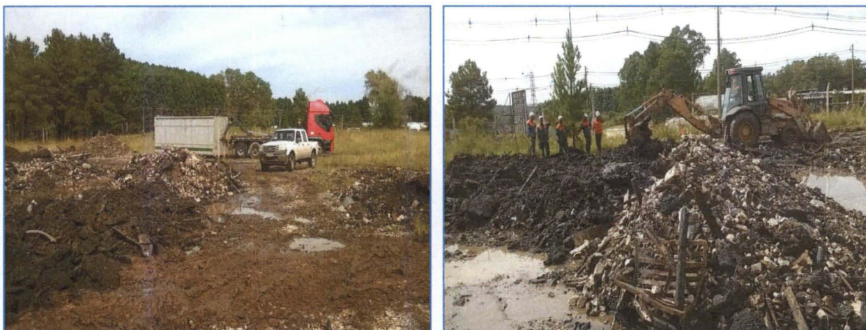
Figura 12. Carregamento de Resíduos do Sinistro na Torre de Refrigeração da Fase A.
