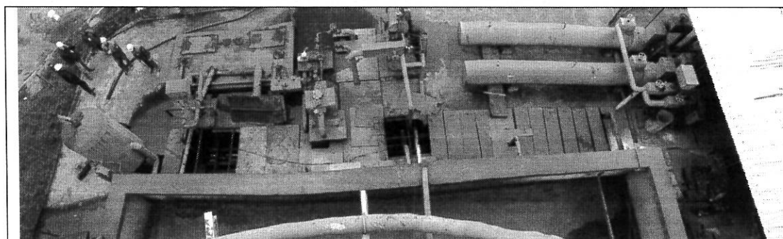
E2. Sistema de armazenamento e bombeamento de Óleo Combustível de alimentação da Fase C – 5EGH
