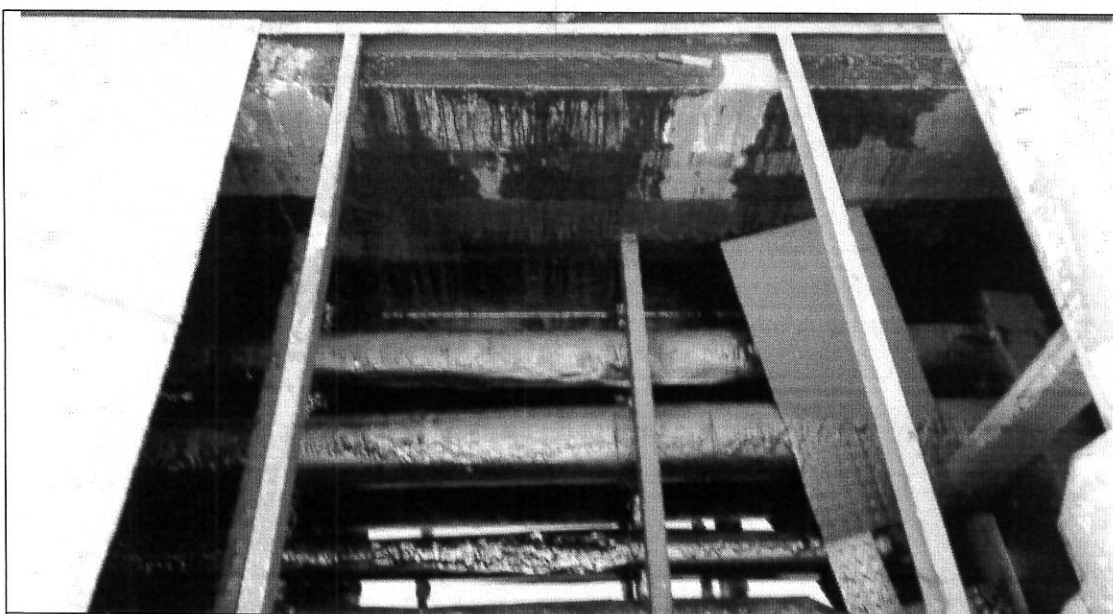
E4. Vazamento do sistema de bombeamento. Drenagem com destinação desconhecida.
