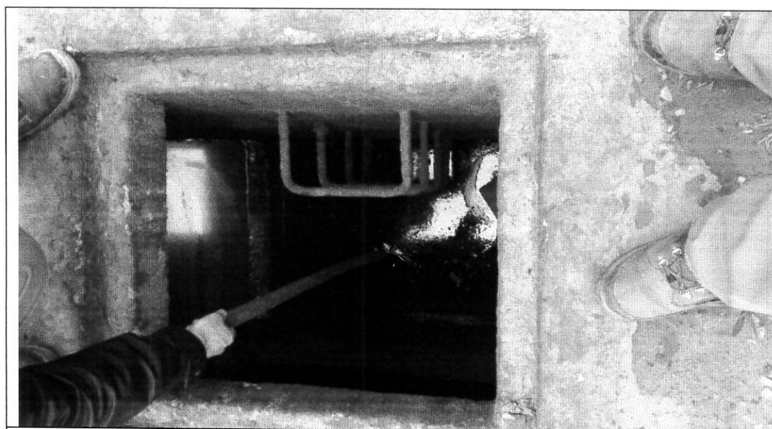
B4. CSO05 com presença de camada sobrenadante de Óleo no primeiro estágio, comprometendo a eficiência do dispositivo.
