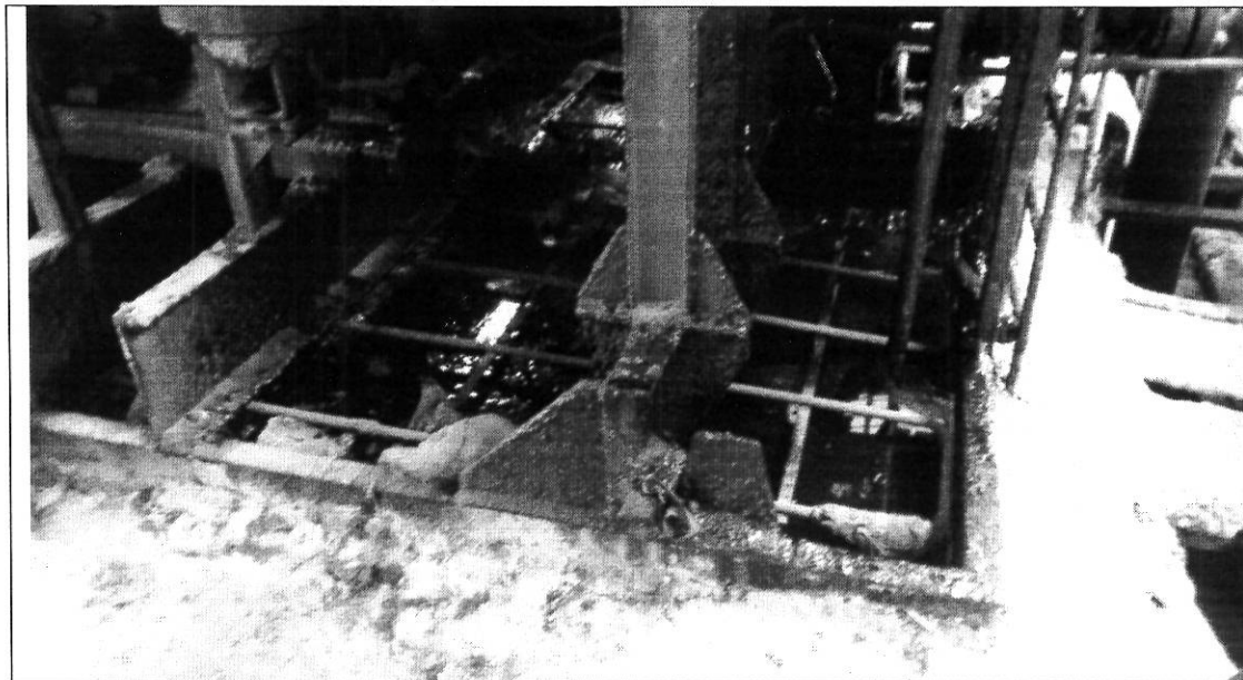
D2. Vazamento de Óleo no sistema de bombeamento.
