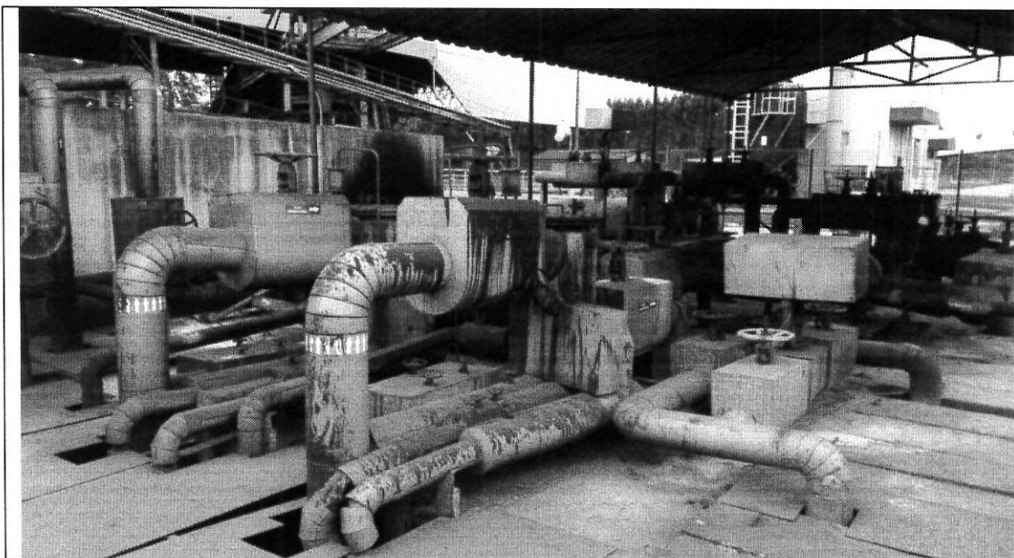
E1. Sistema de armazenamento e bombeamento de Óleo Combustível de alimentação da Fase C – 5EGH
