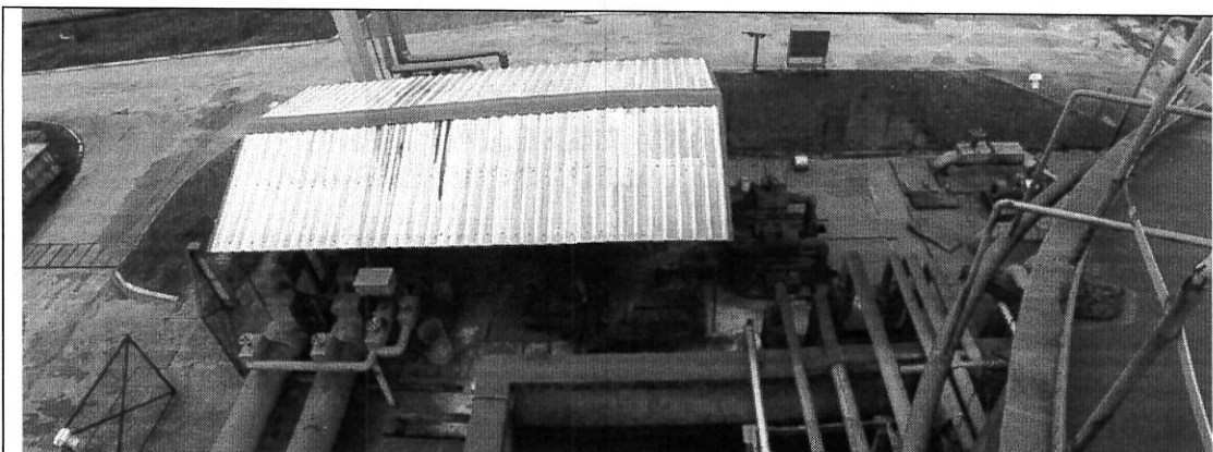
E.3 Sistema de armazenamento e bombeamento de Óleo Combustível de alimentação da Fase C – 5EGH
