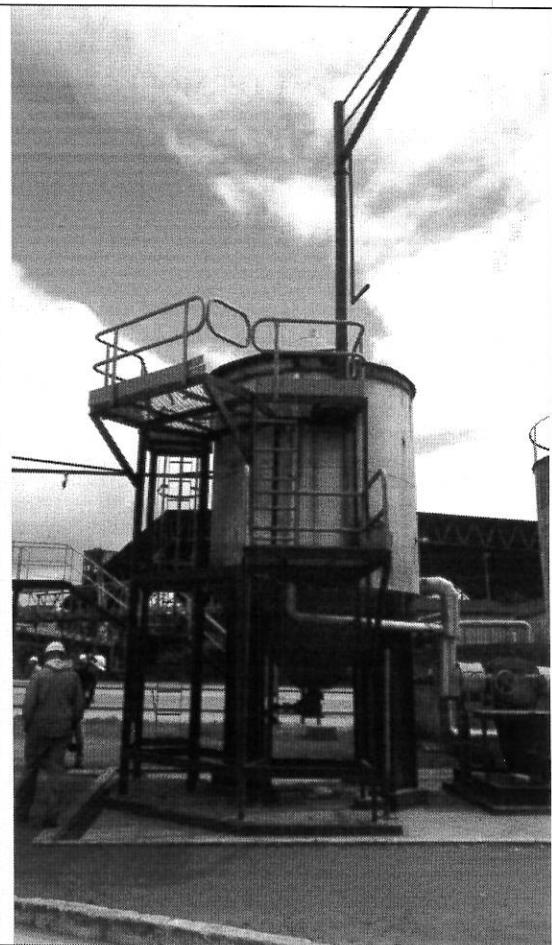
C3. Tanque de recuperação de Óleo combustível. Indisponibilidade operacional.
