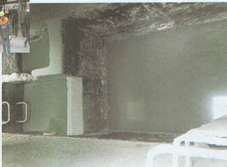
Figura 64: Ponto 2 da figura 56 - Registro de caixa SAO nº 3 sem indícios de óleo (referente ao sistema de bombeamento de óleo da fase B)
