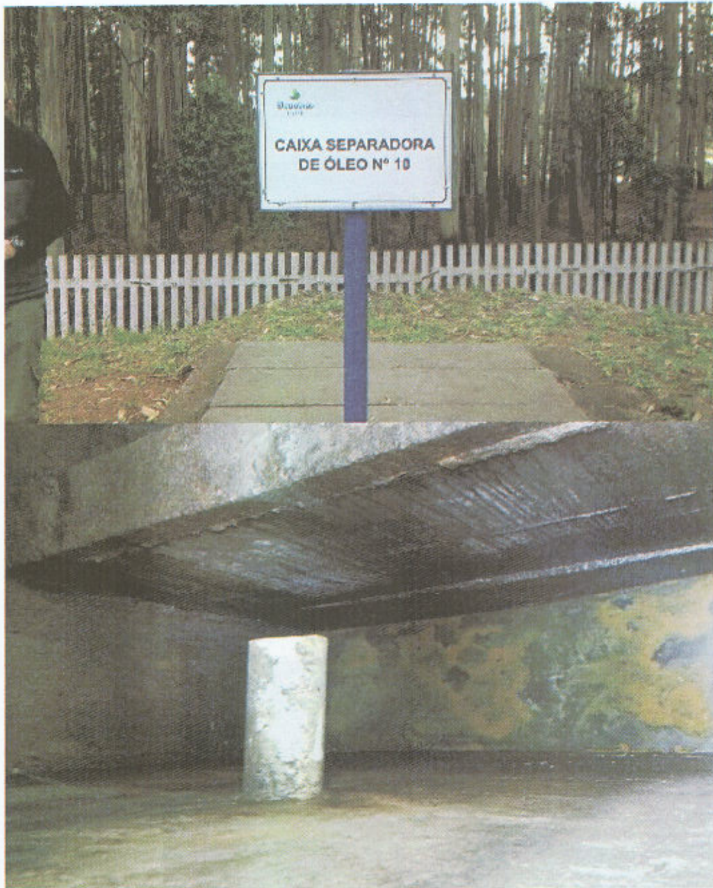
Figura 54: Evidência de presença de óleo no último compartimento da Caixa separadora de água e óleo que coleta efluentes da área da central destinada para o acondicionamento de resíduos classe I. Não foi identificado para onde a tubulação de saída em destaque na foto descarrega o efluente após sua passagem pela caixa.
