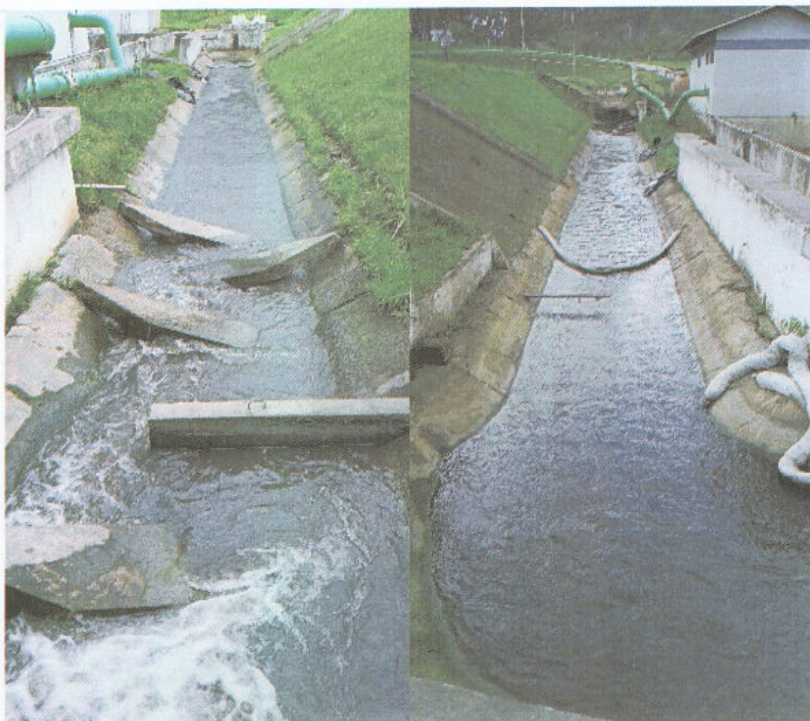
Figura 8. Ponto 3 da figura 1 – Canal de descarte dos efluentes líquidos: Presença de barreiras absorventes de óleo
