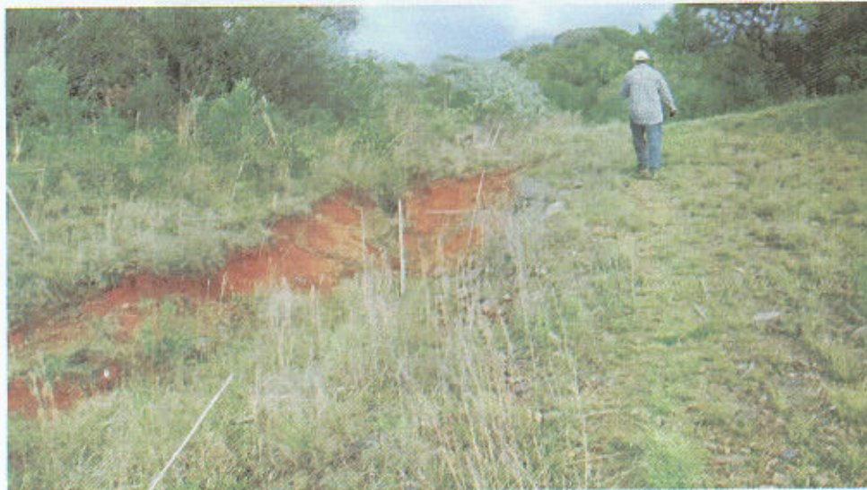
Figura 28. Área 11- Erosão do talude
