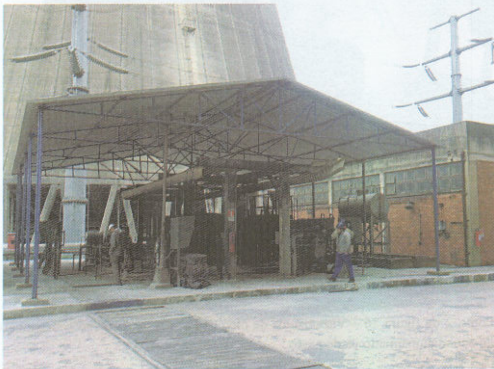
Figura 62: Ponto 2 da figura 56 – Caldeira da fase A onde, segundo informado pelos funcionários da empresa, há a contaminação de óleo na drenagem de fundo devido ao mau funcionamento da tremoia quando do acendimento da fase A.
