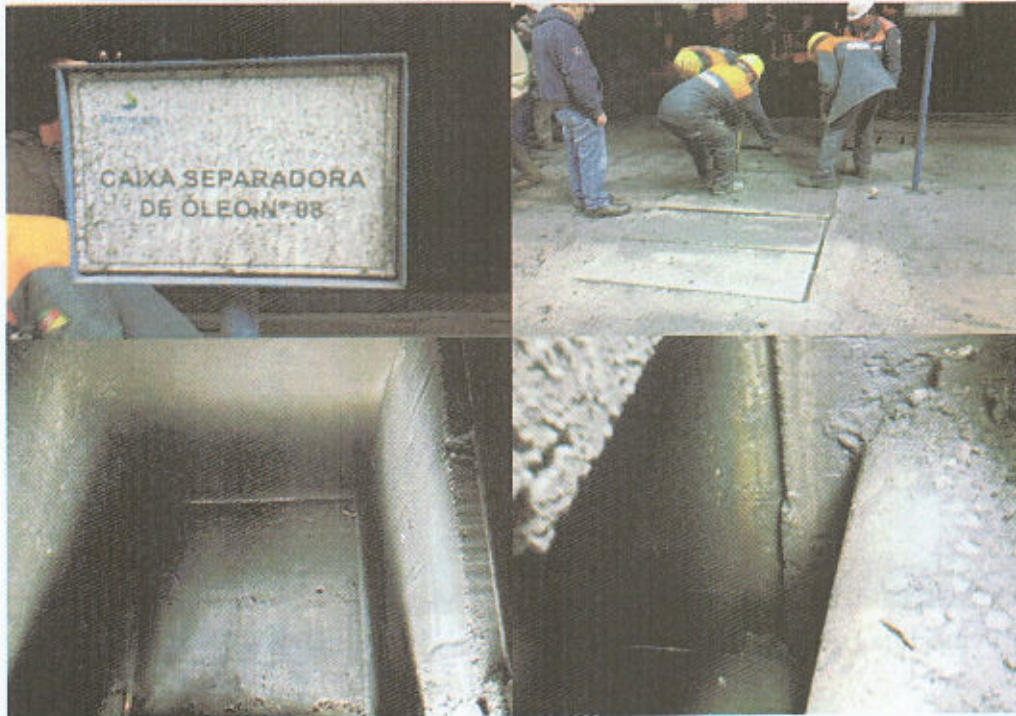
Figura 60: Ponto 2 da figura 56 – Caixa SAO nº 08 sem os compartimentos divisórios que promovem a separação água e óleo
