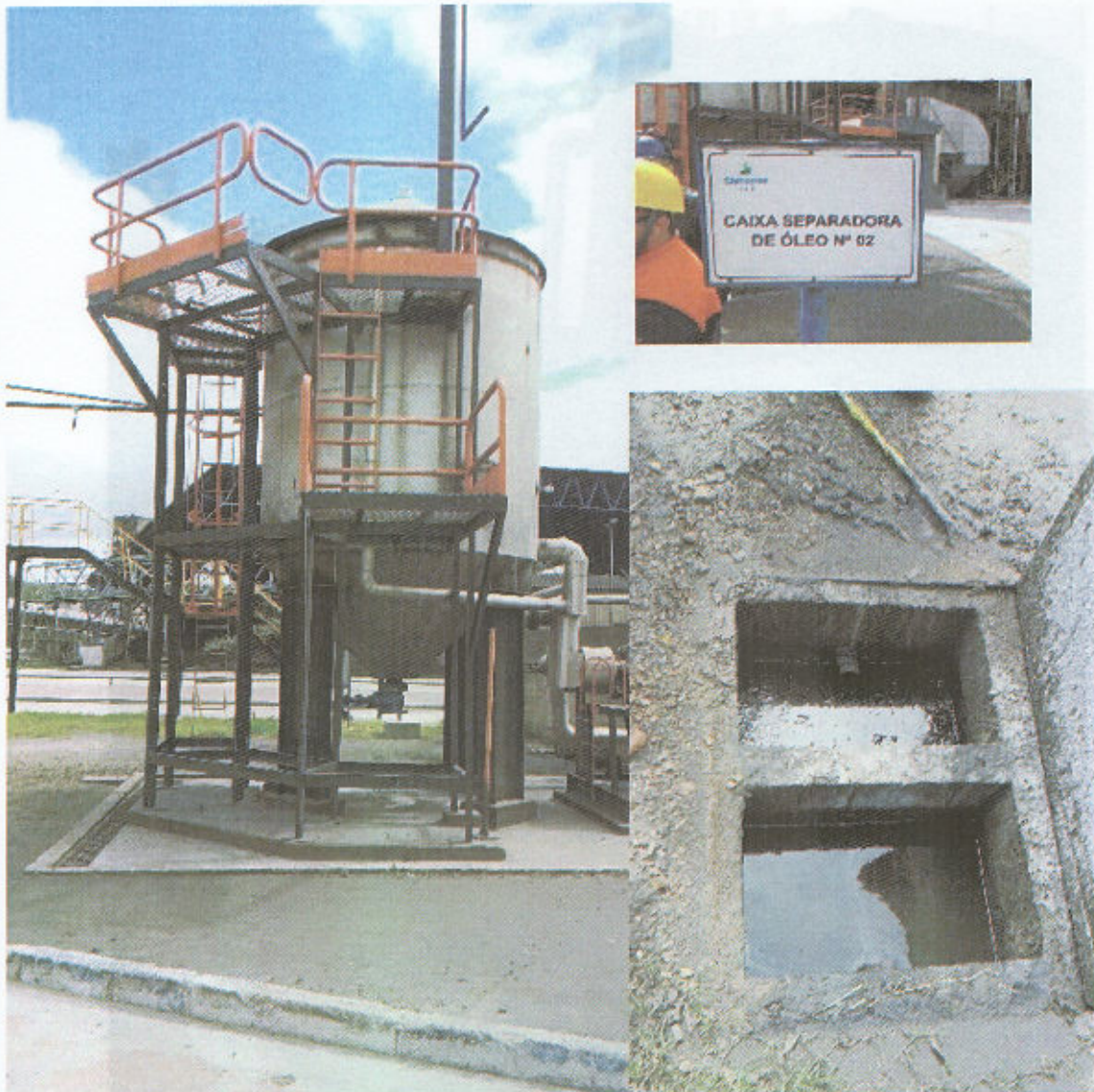
Figura 66: Ponto 3 da figura 56 – Registro de inexistência de bacia de contenção no tanque proposto para operação do sistema de reaproveitamento de óleo e de iridescências de óleo no compartimento da caixa SAO referente a este tanque.
