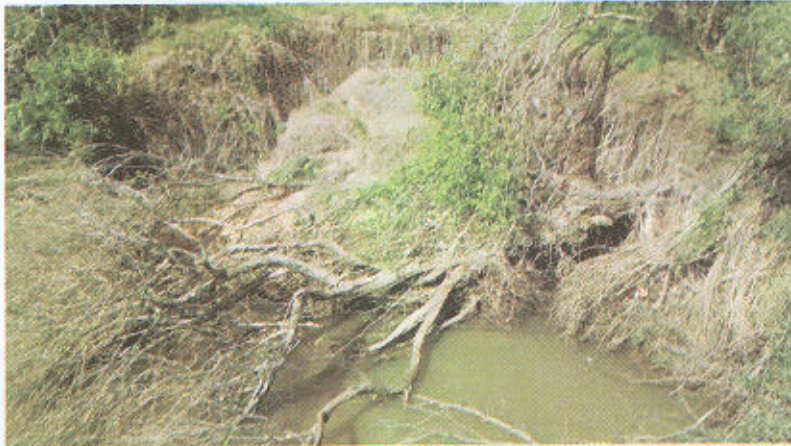
Figura 83. Erosão na margem do rio no PM6
