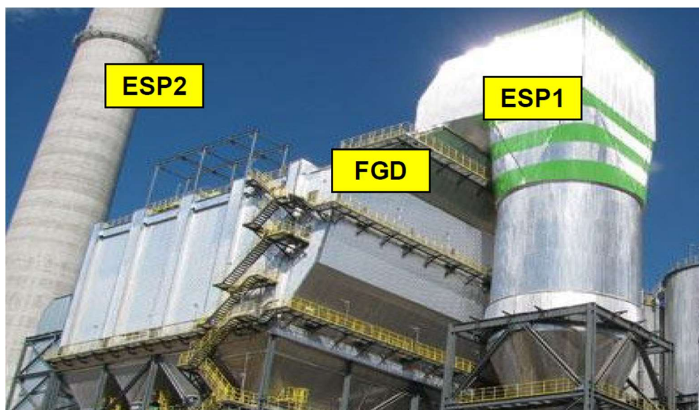
Figura 6. Sistema de tratamento de gases da UTE Candiota III Fase C.
