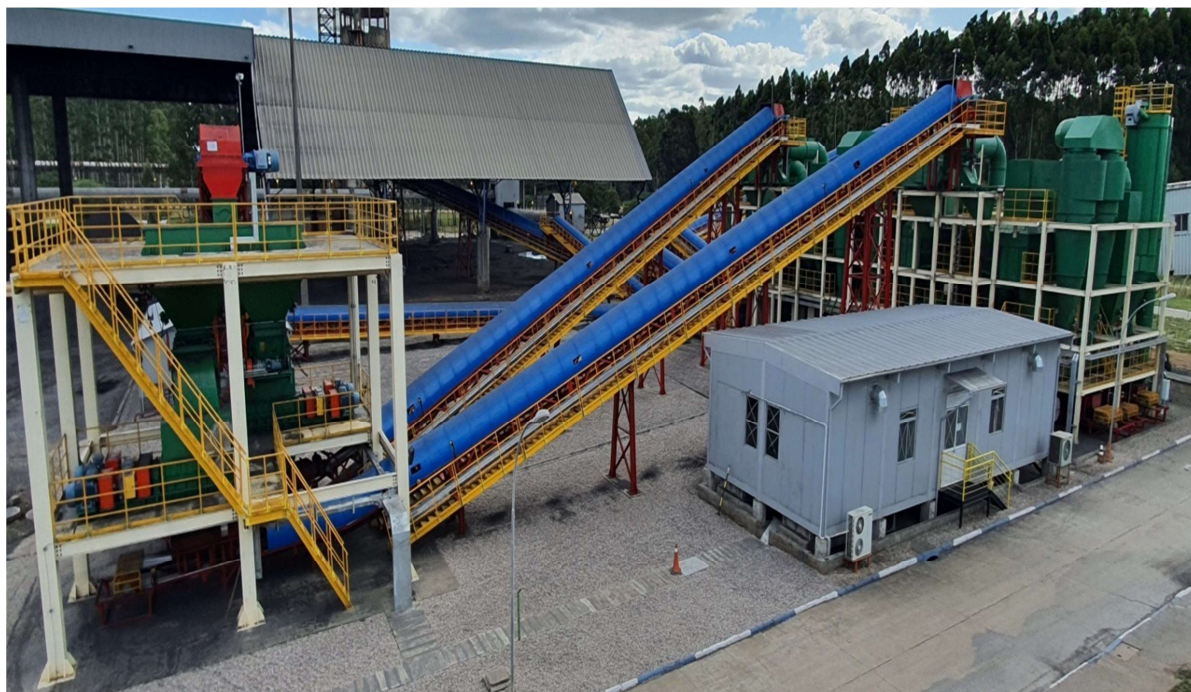
Figura 3. Britador e Correias do Beneficiamento de Carvão.
