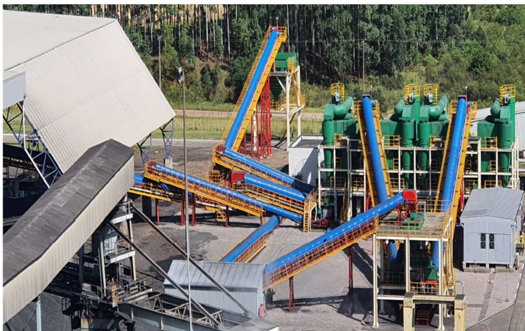
Figura 4. Sistema de Beneficiamento de Carvão Mineral a Seco.
