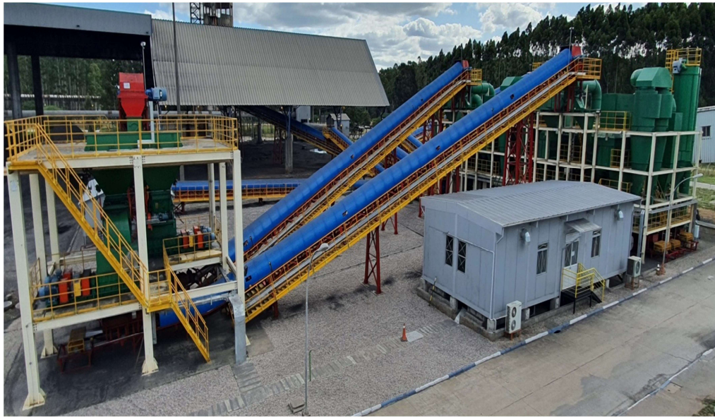
Figura 2. Britador e Correias do Beneficiamento de Carvão.
