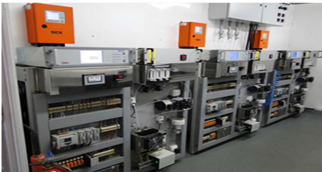
Figura 7. Monitoramento contínuo gases e vazão.
