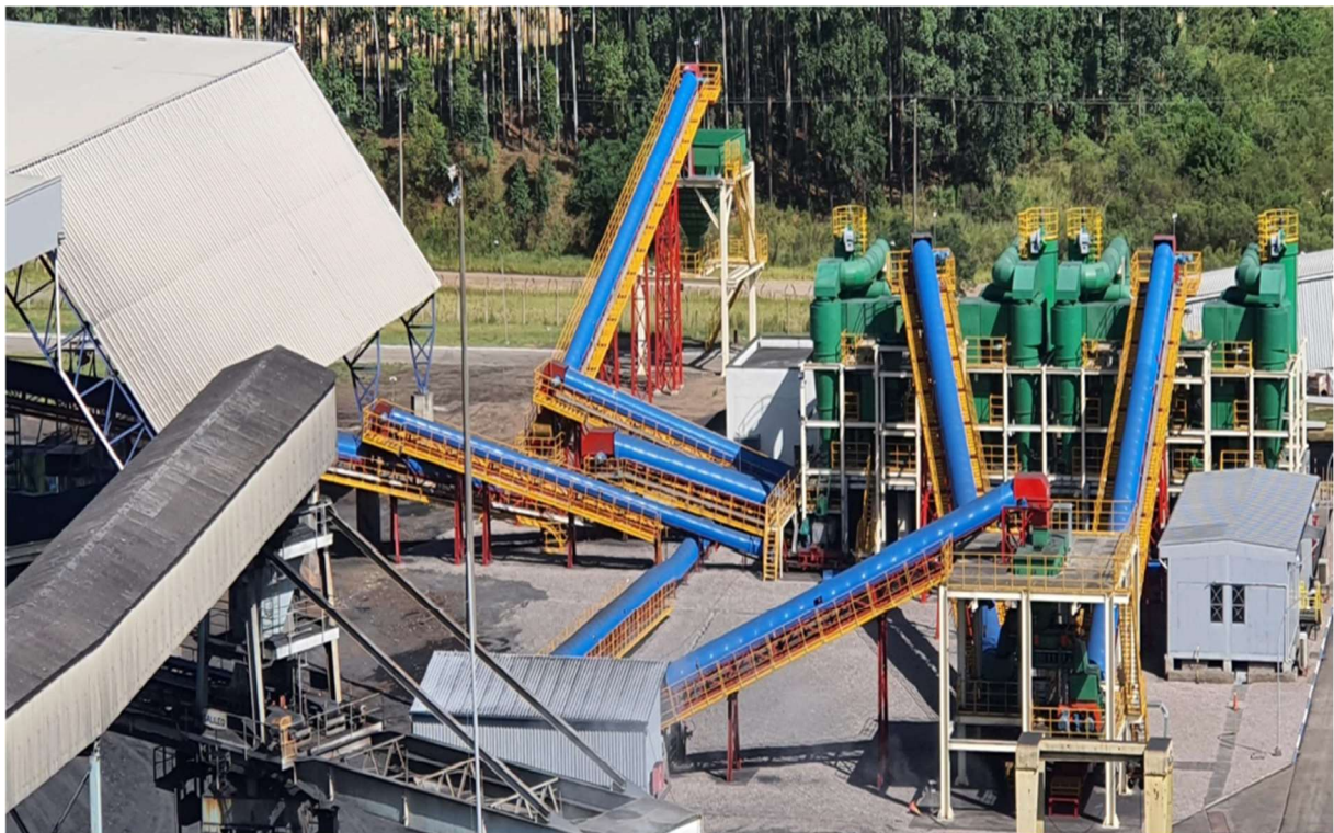
Figura 3. Sistema de Beneficiamento de Carvão Mineral a Seco.
