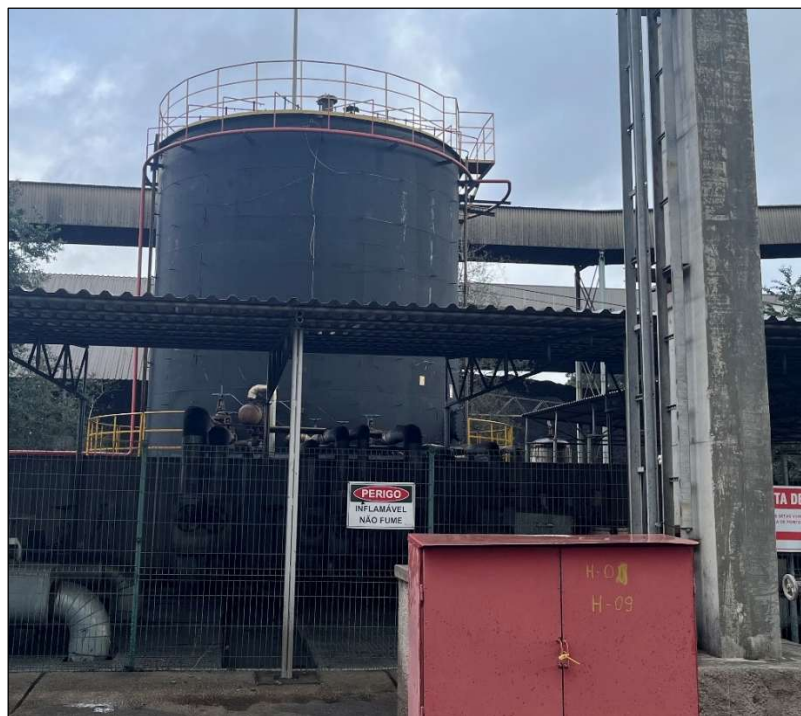
Figura 8 Tanque de óleo combustível de 300 m3
