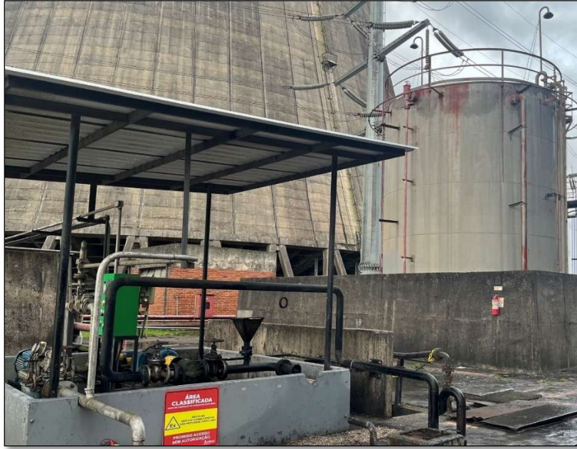
Figura 9 Tanque de Diesel 200 m3
