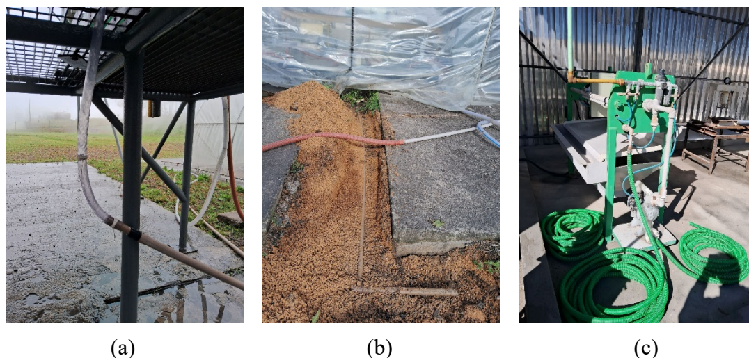
Figura 15: (a) e (b) Mangueiras antigas; (c) Conjunto de mangueiras novas.
