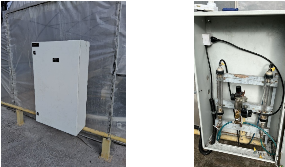
Figura 9: Painel para proteção do sistema de injeção de gás e ponto elétrico instalado.
