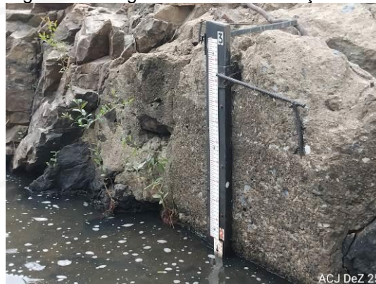
Figura 16 - Régua instalada na estação ACJ.
