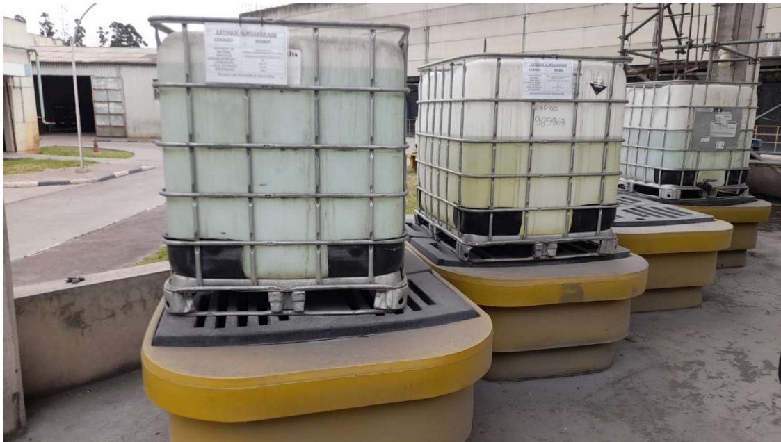
Figura 6. Sistema de Contenção para Armazenamento e Uso de Produtos Químicos.
