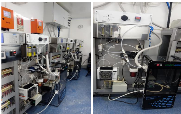
Figura 16- sistema de monitoramento contínuo de emissões atmosféricas.
