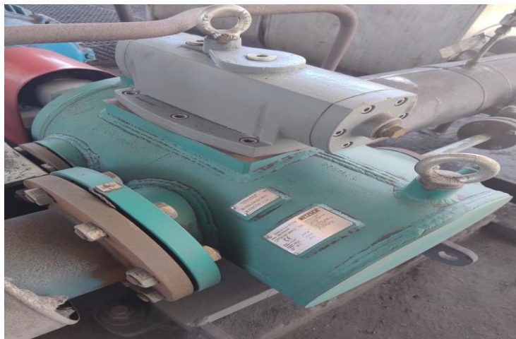
Figura 39 – Novas bombas de pressurização de óleo combustível.
