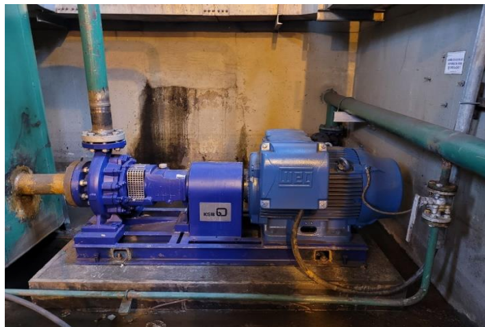
Figura 36 – novas bombas de levantamento de água da purga da torre.
