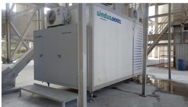
Figura 17- sistema de monitoramento contínuo de emissões atmosféricas.
