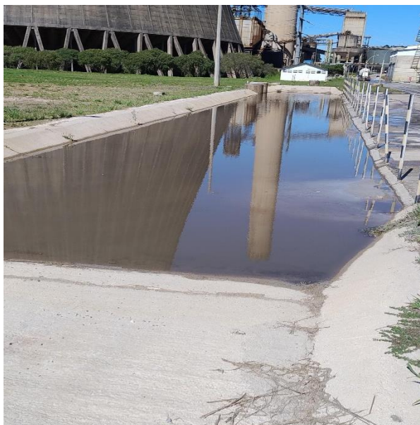
Figura 44 – Bacias de drenagem e contenção da usina.
