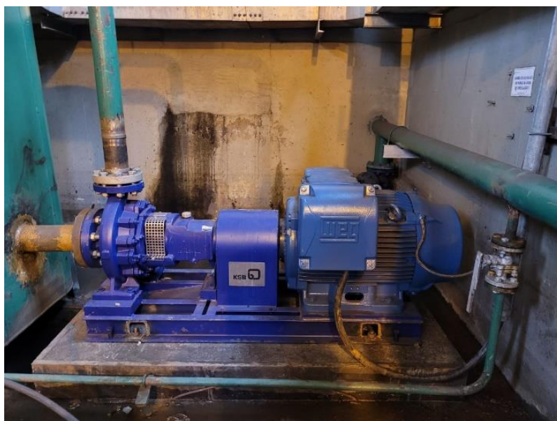
Figura 19- novas bombas de água para malaxadores.
