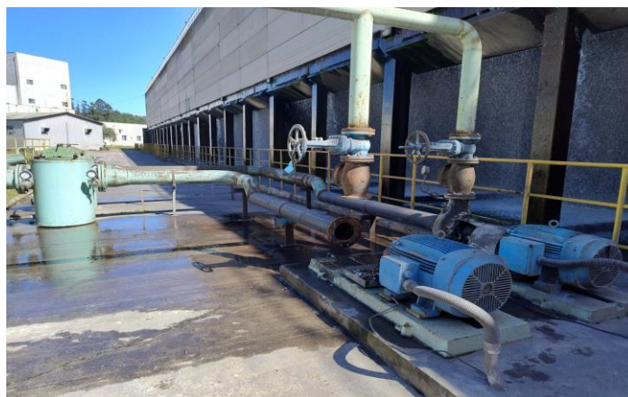
Figura 35 – novas bombas de refrigeração dos ventiladores.
