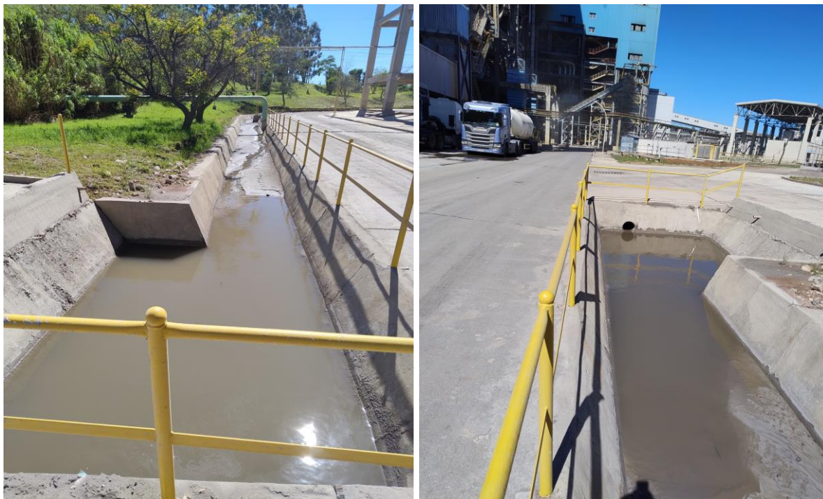
Figura 43 – Bacias de drenagem e contenção da usina.
