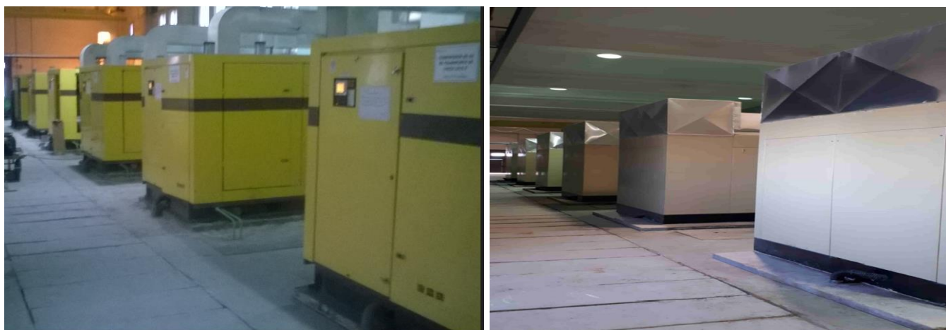
Figura 20- Compressores de ar de transporte antes e depois da substituição.
