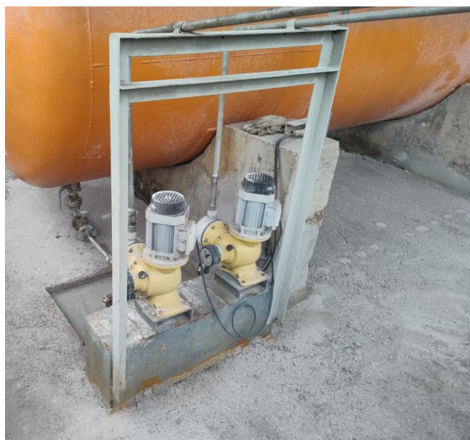
Figura 38 – Novas bombas de neutralização de efluentes.
