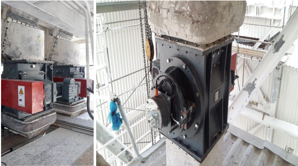
Figura 13- troca das válvulas dosadoras de cal
