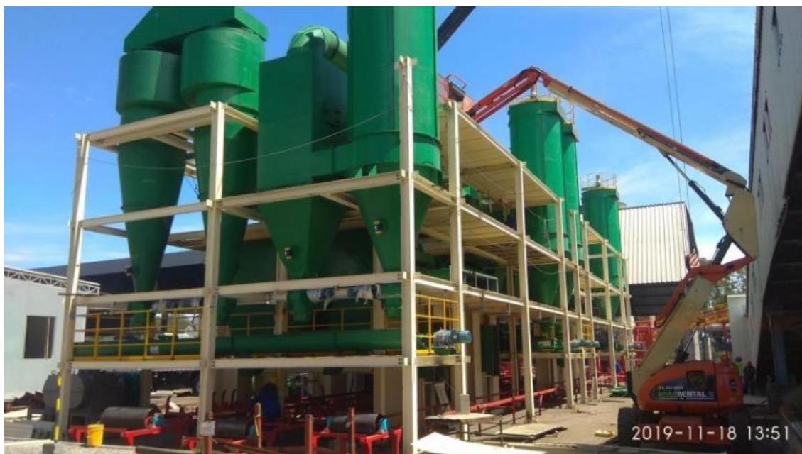
Figura 30 - Sistema de Beneficiamento de Carvão Mineral da UTE Candiota III Fase C.
