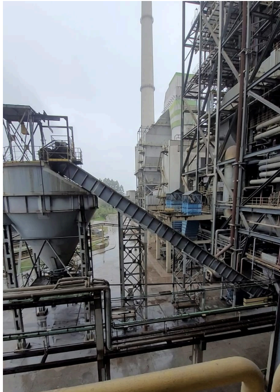
Foto 09: Silo do subproduto da queima do carvão (cinza).
