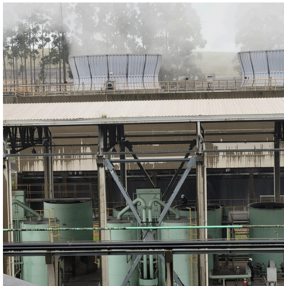
Foto 11: ETE e Torres de Resfriamento.
