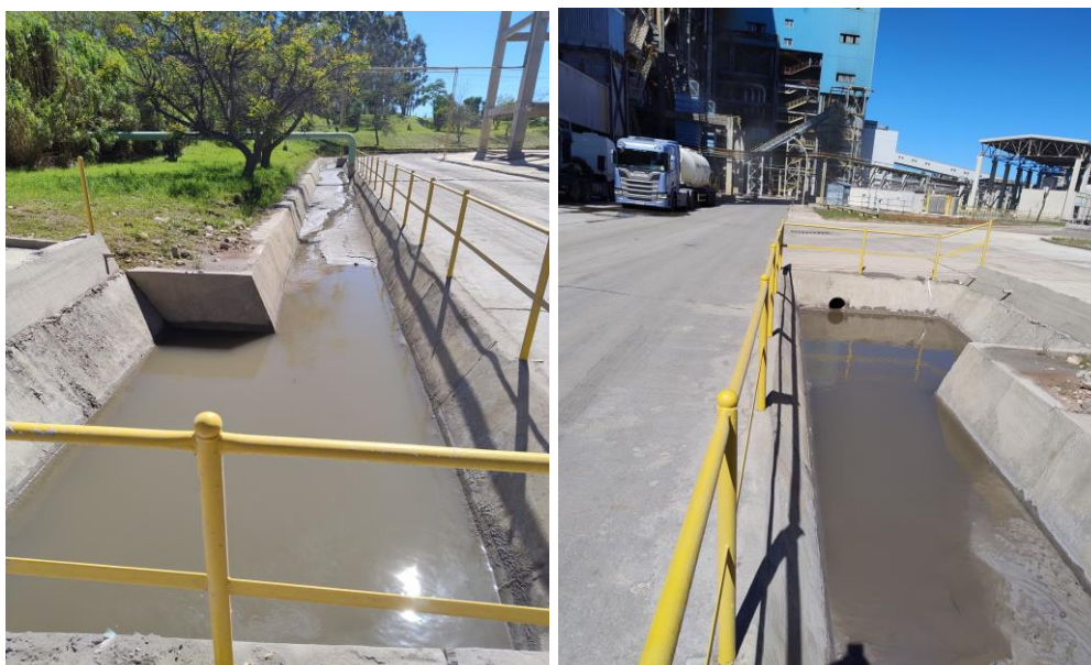
Figura 43 – Bacias de drenagem e contenção da usina.
