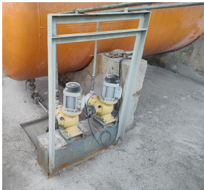
Figura 38 – Novas bombas de neutralização de efluentes.
