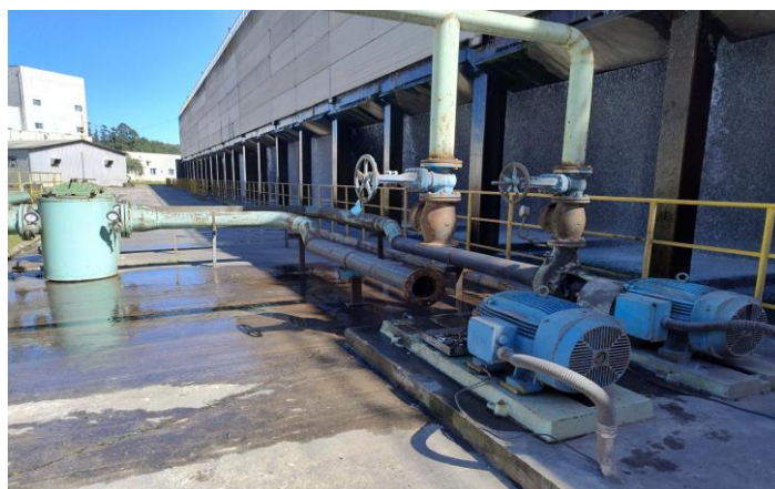
Figura 35 – novas bombas de refrigeração dos ventiladores.
