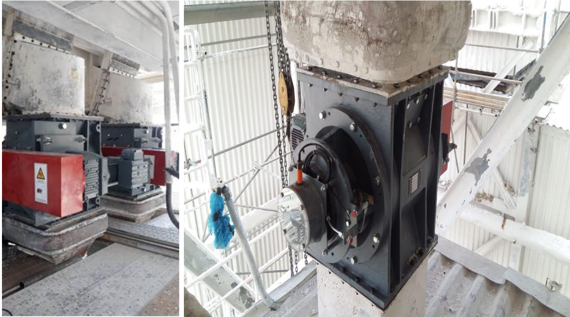
Figura 13- troca das válvulas dosadoras de cal
