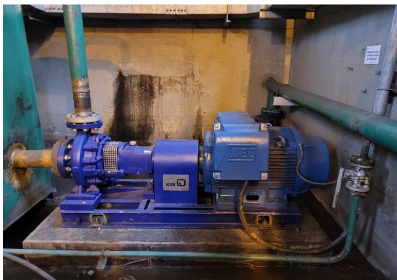
Figura 19- novas bombas de água para malaxadores.
