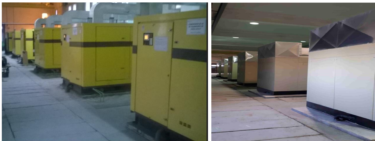
Figura 20- Compressores de ar de transporte antes e depois da substituição.
