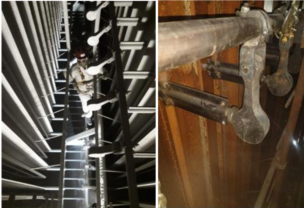
Figura 2- novos batedores de placas e de eletrodos instalados nos precipitadores.
