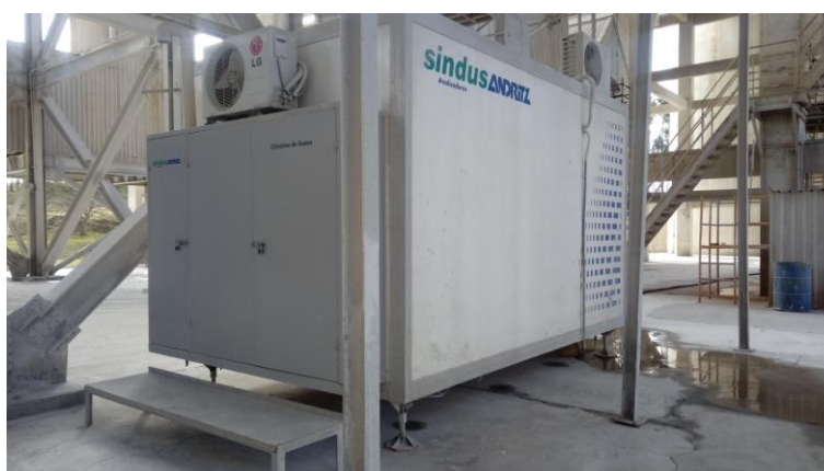
Figura 17- sistema de monitoramento contínuo de emissões atmosféricas.
