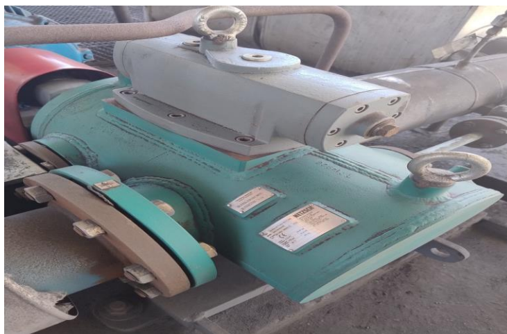
Figura 39 – Novas bombas de pressurização de óleo combustível.
