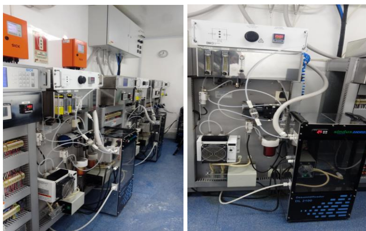
Figura 16- sistema de monitoramento contínuo de emissões atmosféricas.
