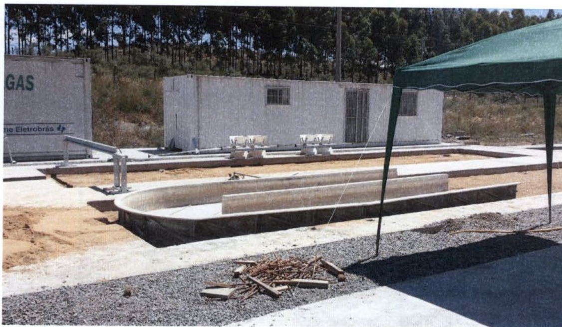
Figura 49: Instalação dos fotobiorreatores e sistema de agitação
