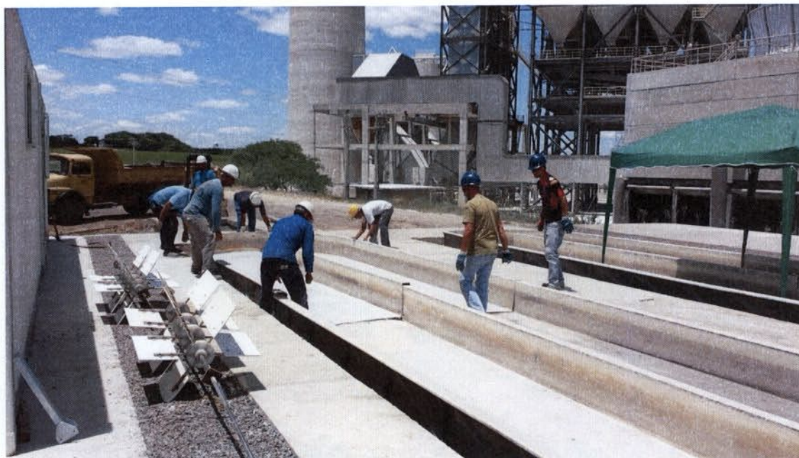
Figura 50: Instalação dos fotobiorreatores e sistema de agitação
