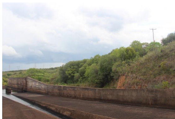
Figura 15. Vista da margem direita do canal rápido. Centro da foto mostra matinha com até 7,00 m de altura.
