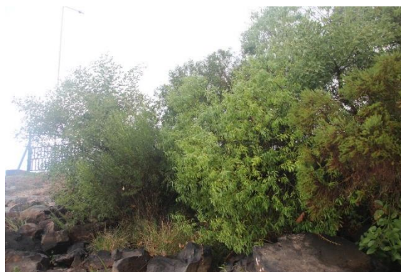
Figura 03. Árvores e arbustos crescendo em meio ao enrocamento do talude de montante.
