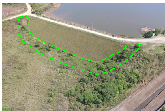
Figura 06. Imagem obtida com drone. Tracejado verde delimita Área 02 a ser manejada no talude de jusante.
