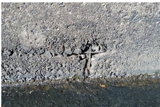
Foto 64: Muros laterais – Armação exposta.
