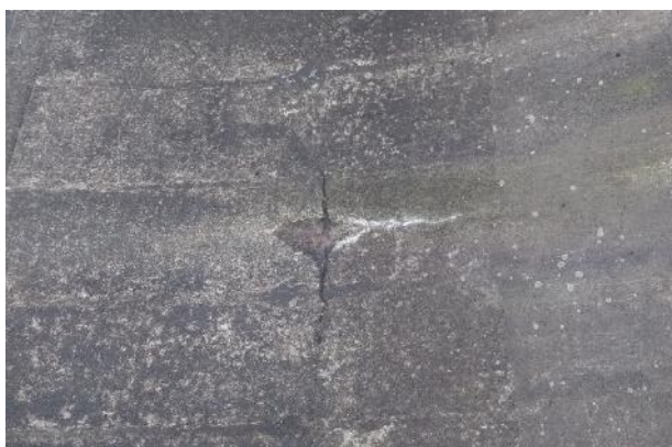
Foto 42: Soleira do vertedouro – Fissura na laje de fundo do vertedouro.
