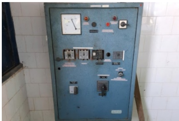
Foto 6: Estrutura – Quadro de energia de alimentação da Barragem.
