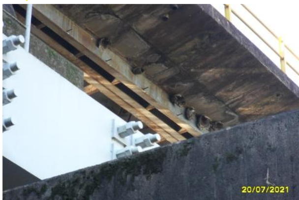
Foto 38: Bloco do vertedouro – Armadura exposta face inferior do tabuleiro, maior dano identificado..
