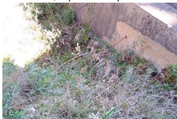
Foto 65: Muros laterais – Armaduras de amarração de formas expostas.
