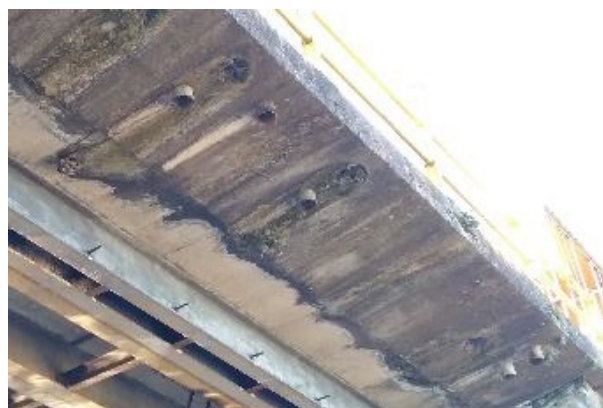
Foto 49: Bloco do vertedouro – Sistema de drenagem do tabuleiro da ponte.
