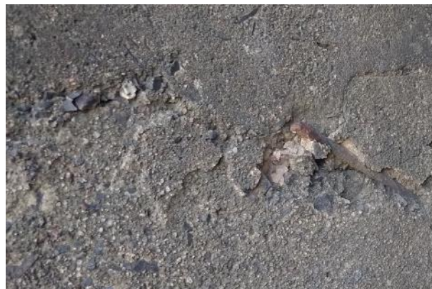
Foto 37: Paredes do Vertedouro – Armadura exposta, vista 03
