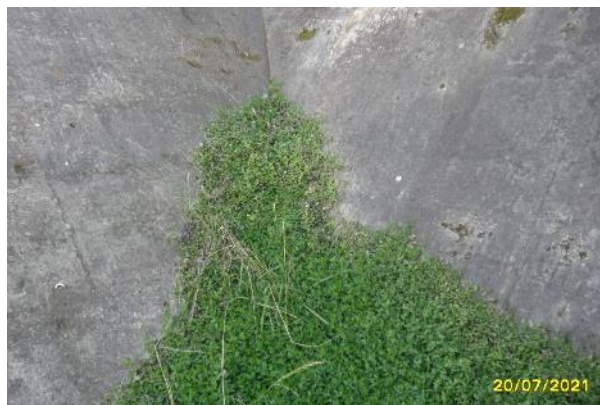
Foto 41: Bloco do vertedouro – Presença de vegetação nas paredes.
