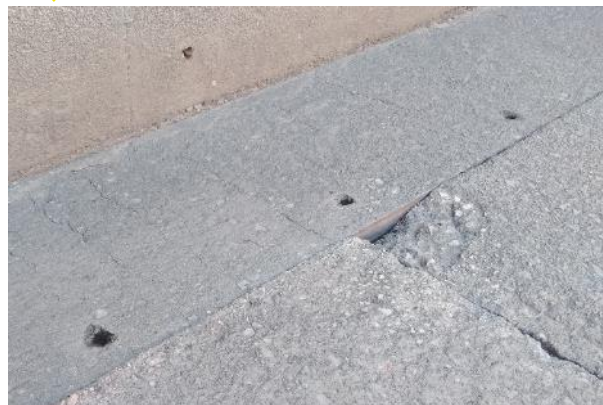
Foto 57: Canal rápido – Deslocamento do concreto na laje, no vértice da junta com os muros laterais
