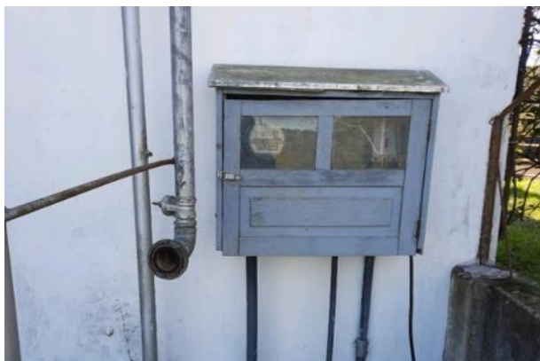
Foto 5: Estrutura – Quadro geral de distribuição cargas. Entrada de energia da companhia.
