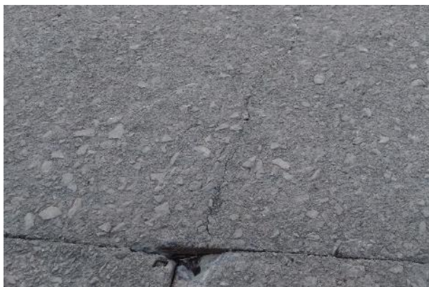
Foto 54: Canal rápido – Fissura na laje
