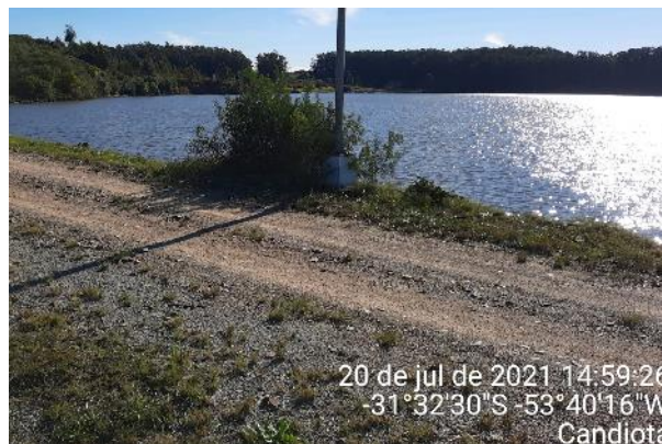
Foto 16: Coroaamento – Arbusto de maior porte junto ao poste de energia.
