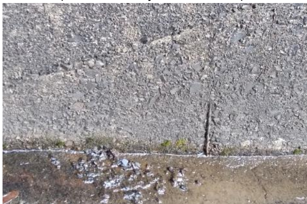
Foto 36: Paredes do vertedouro – Armadura exposta, vista 02
