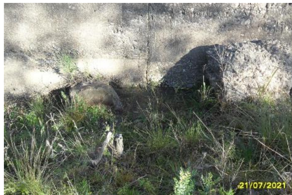
Foto 67: Muros laterais – Junta do muro lateral esquerdo, face externa, junto a bacia de dissipação energia, com vazamento.
