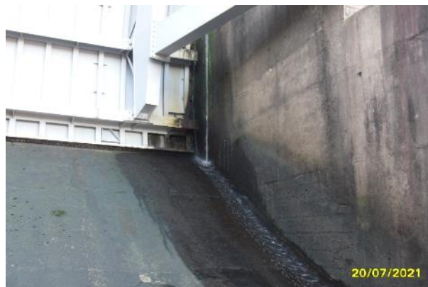
Foto 69: Comporta 1 – Área atingida pelo vazamento.
