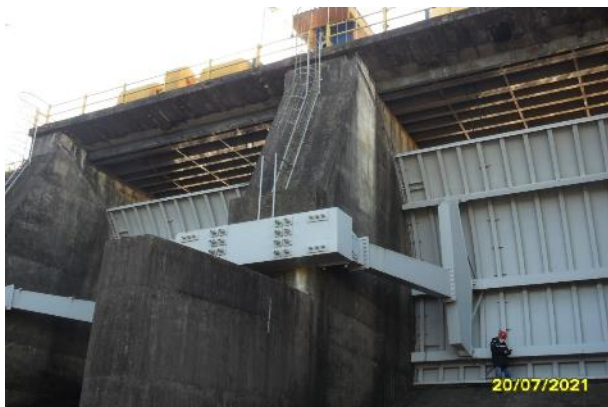
Foto 46: Ausência de proteção nos últimos degraus das escadas de acessos aos munhões metálicos.
