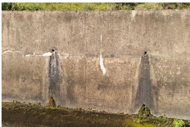
Foto 62: Muros laterais – Sinais de lixiviação do concreto.
