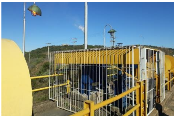
Foto 3: Sistema de acionamento das comportas – estrutura de proteção.
