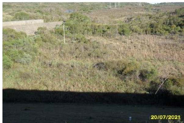
Foto 23: Talude de jusante – Região ao pé do talude com presença de muita vegetação.
