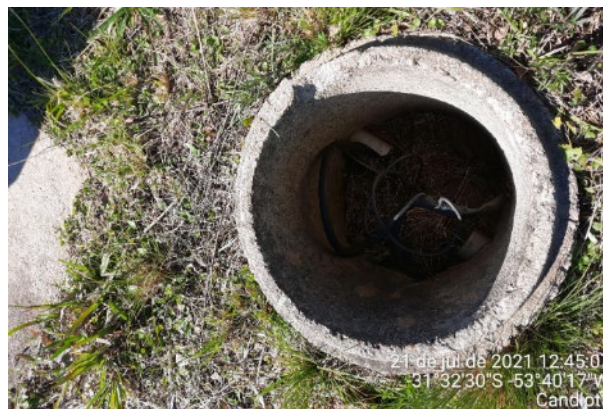
Foto 10: Caixa de passagem de instalações elétricas – fiação exposta.
