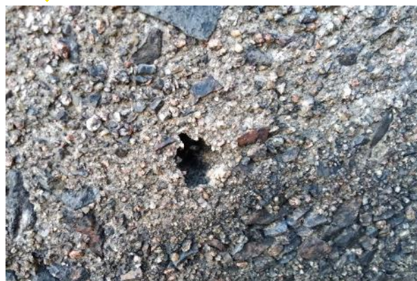
Foto 39: Bloco do vertedouro – Armadura exposta face inferior do tabuleiro, maior dano identificado..
