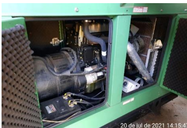
Foto 8: Gerador de energia – Situação interna, em boas condições.
