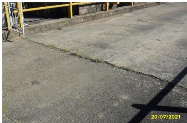
Foto 50: Bloco do vertedouro – Junta sem selamento na crista do vertedouro.
