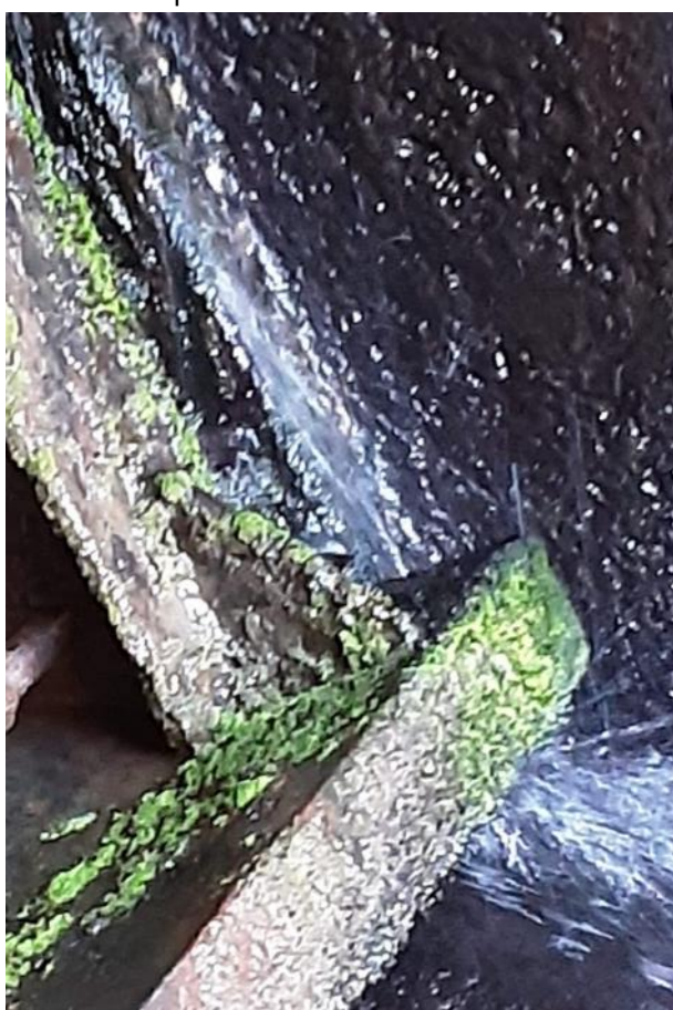
Foto 70: Comporta 1 – Canto inferior esquerdo com corrosão severa causada pelo excesso de umidade (por vazamento)
