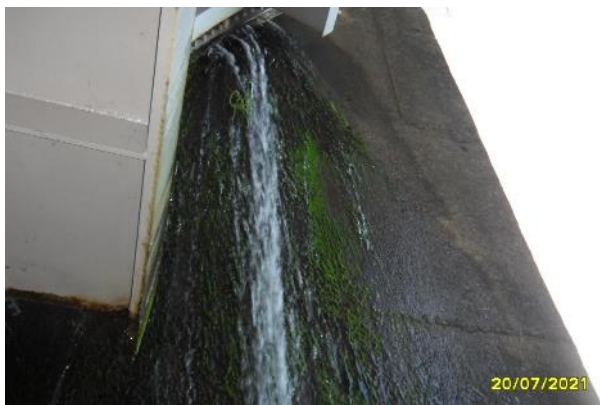
Foto 68: Comporta 1 – Detalhe do volume de vazamento e limo na parede do pilar central do bloco do vertedouro.
