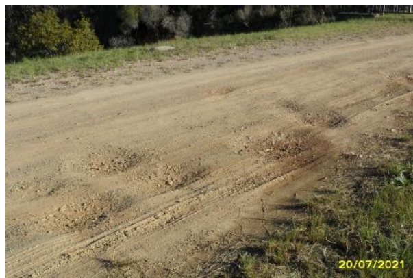
Foto 14: Coroamento – Crista com buracos na faixa transitável.
