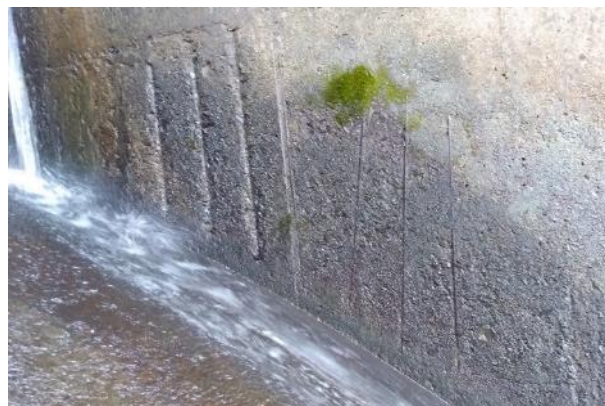
Foto 35: Parede do vertedouro – armadura exposta, vista 01
