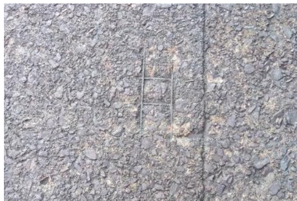
Foto 55: Canal rápido – Armadura exposta na laje
