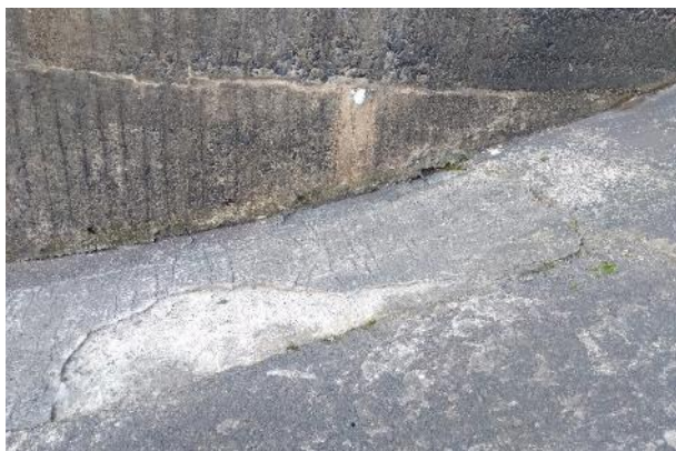
Foto 34: Soleira do vertedouro – Deslocamento na região próxima ao pilar central, à jusante da comporta 1.
