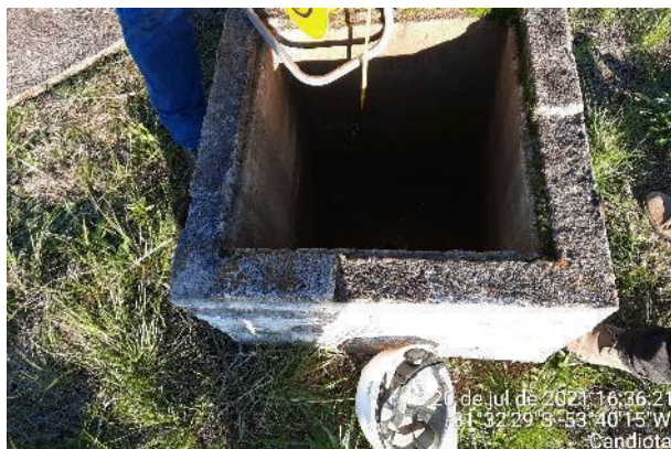
Foto 24: Piezômetro 02 – Condições externas.
