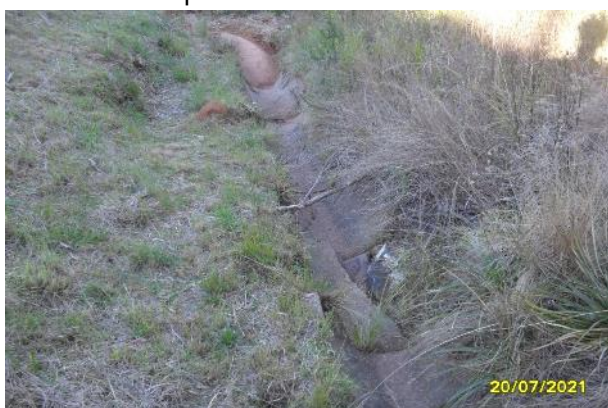
Foto 19: Talude de jusante – Canaleta de drenagem quebrada e obstruída.
