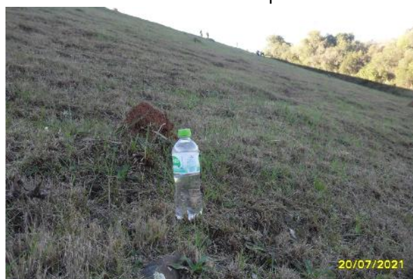
Foto 20: Talude de jusante – Formigueiros identificados na estrutura.
