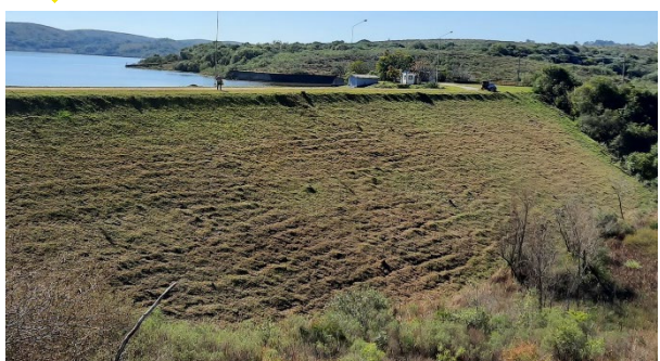
Foto 21: Talude de jusante – Sinais de movimento de rastejo
