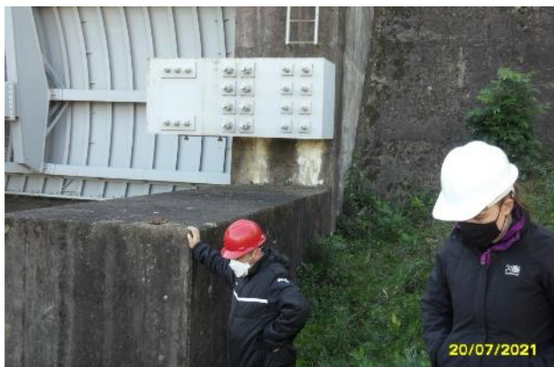
Foto 40: Bloco do vertedouro – Carbonatação junto aos munhões metálicos.
