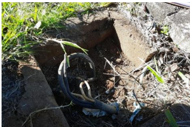
Foto 9: Caixa de passagem de instalações elétricas – fiação exposta e resíduos internos.
