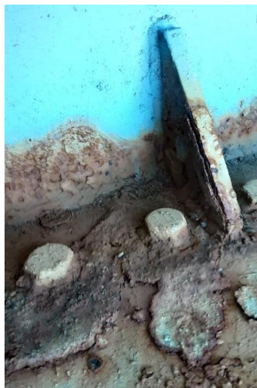
Foto 73: Comporta 1 – Canto inferior esquerdo com corrosão severa causada pelo excesso de umidade.
