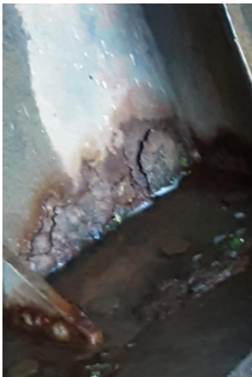
Foto 72: Comporta 1 – Umidade presente na viga de base.
