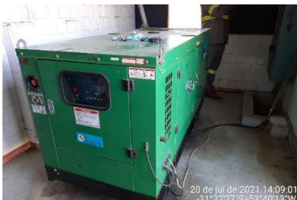
Foto 7: Gerador de energia – Situação externa, em boas condições.
