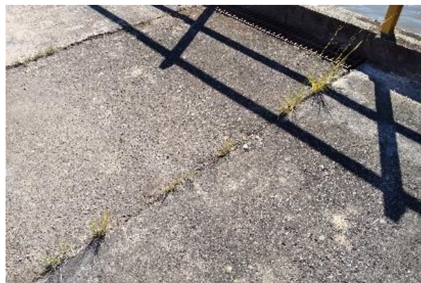
Foto 51: Bloco do vertedouro – Presença de vegetação nas juntas da crista do bloco do vertedouro.
