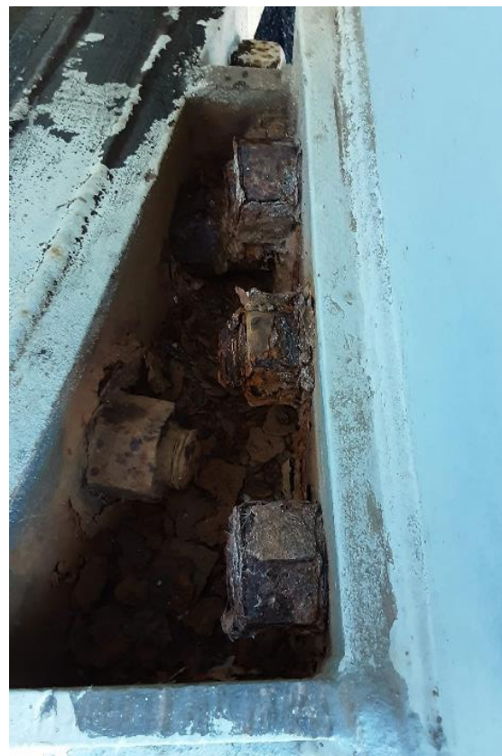
Foto 77: Comporta 1 – Detalhe da corrosão nos parafusos de sustentação.
