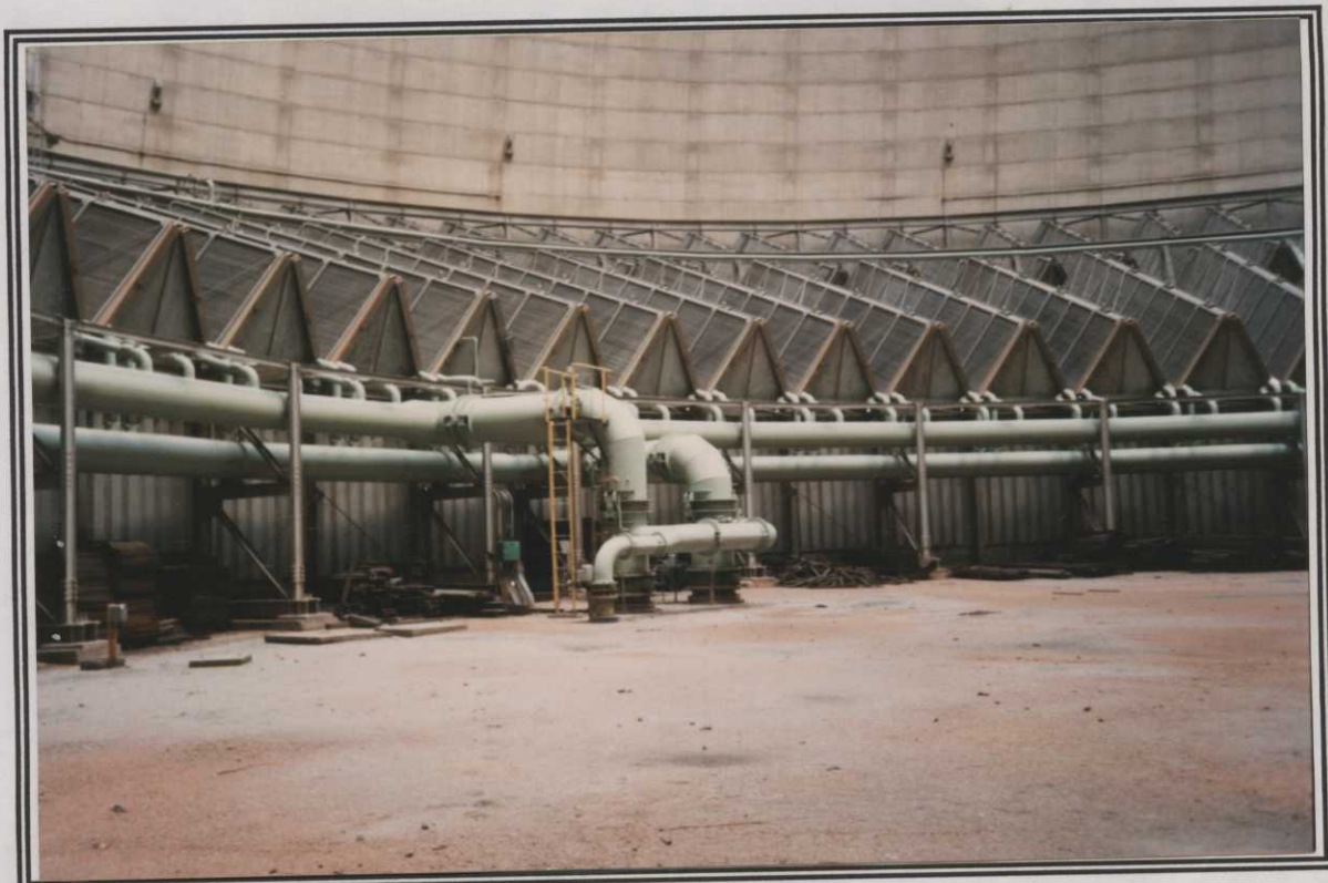
Foto 3 - Interior da torre de refrigeraçao seca.
