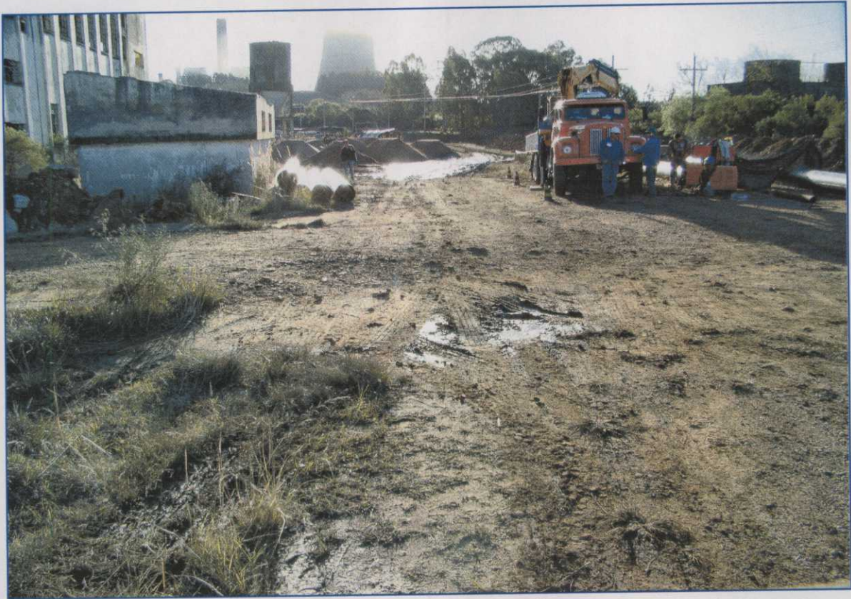
Figura 19. Vista do Acesso Principal a Tomada D'Água com Obras da Fase C.
