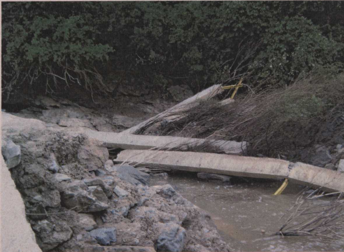
3. A mureta de contenção da ponte, arrancada pela correnteza, no ponto Arroio Candiota Jusante - ACJ.
