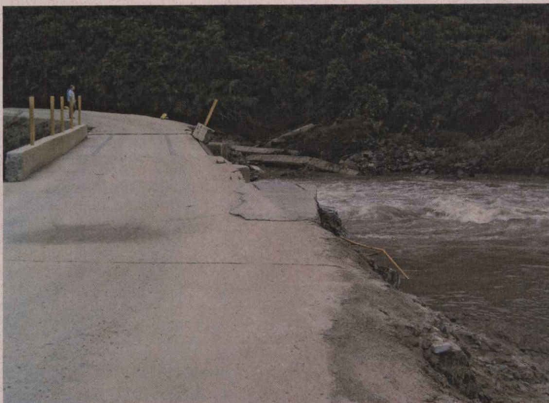
1. As fortes chuvas danificaram a ponte onde estão instaladas as réguas no ponto Arroio Candiota Jusante - ACJ.
