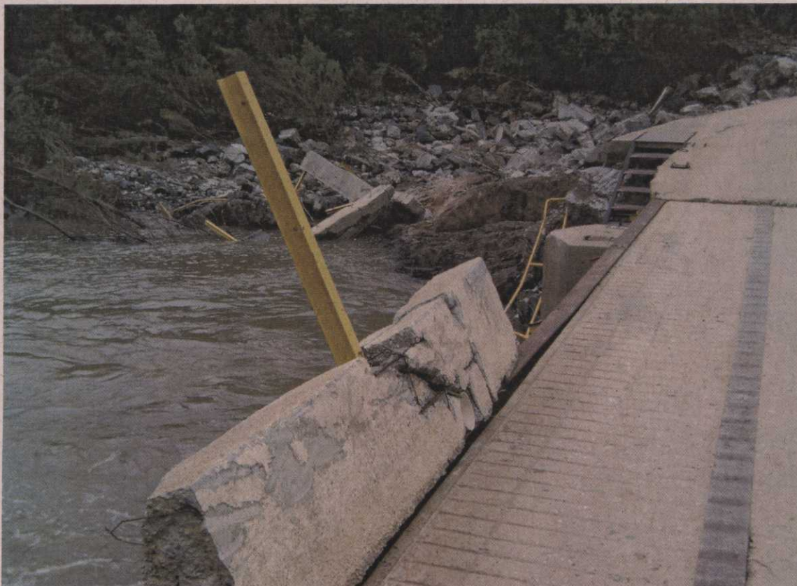
4. Detalhe dos estragos na ponte do ponto Arroio Candiota Jusante - ACJ.
