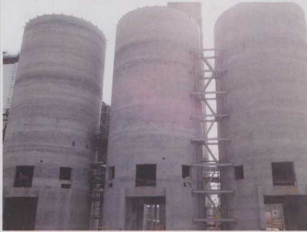
A.7. Silos para armazenamento temporário de cinzas e subprodutos do dessulfurizador
