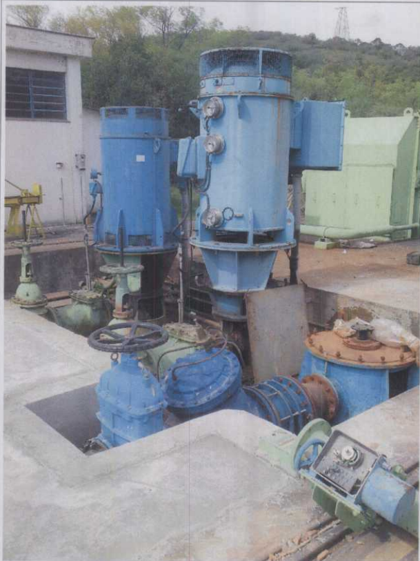
A.82. Bombas Centrífugas para captação de água no reservatório da Barragem I do Arroio Candiota. No canto inferior esquerdo as instalações da bomba da Fase C.
