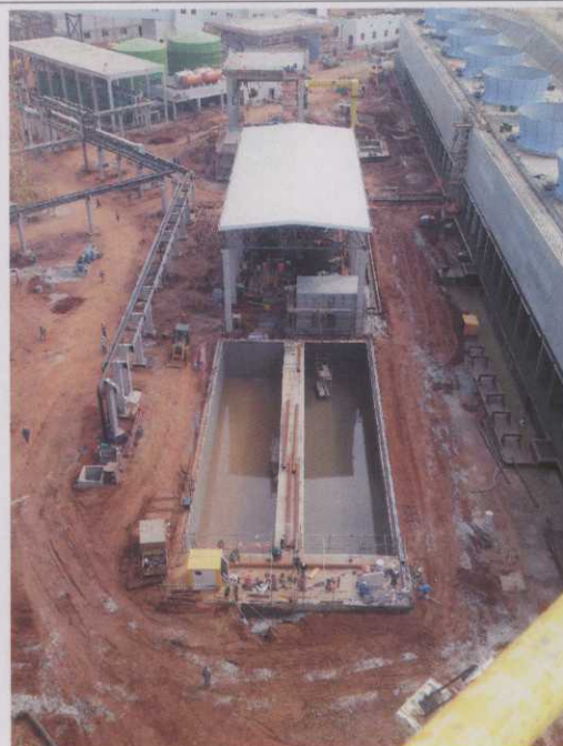
A.32. Reservatório de Efluentes.
