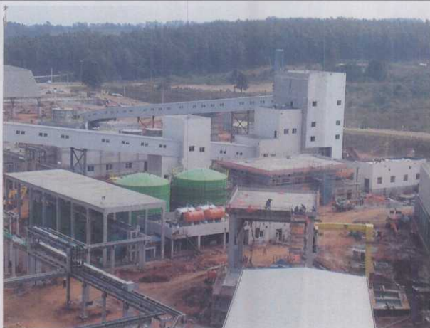
A.27. Sistema de Correias Transportadoras de Carvão do Pátio de Armazenamento ao Prédio da Caldeira
