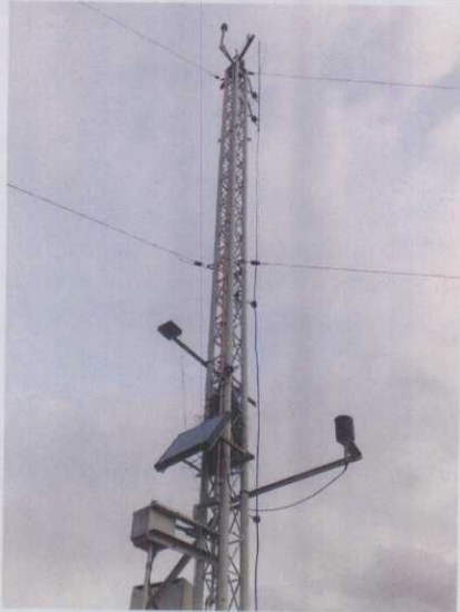
A.90. Torre de monitoramento de condições meteorológicas.
