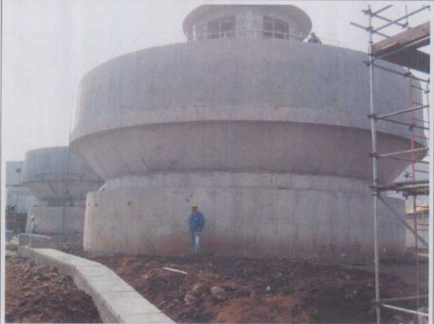
A.34. Tanques de Clarificação de Água.
