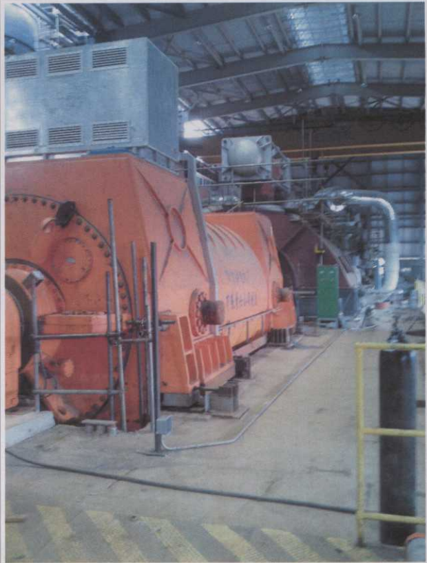
A.22. Gerador e Turbina.
