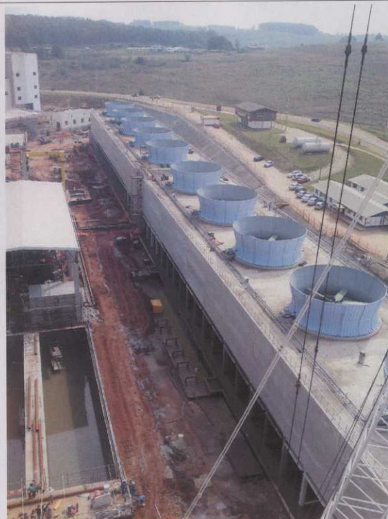
A.30. Torre de Resfriamento do Vapor
