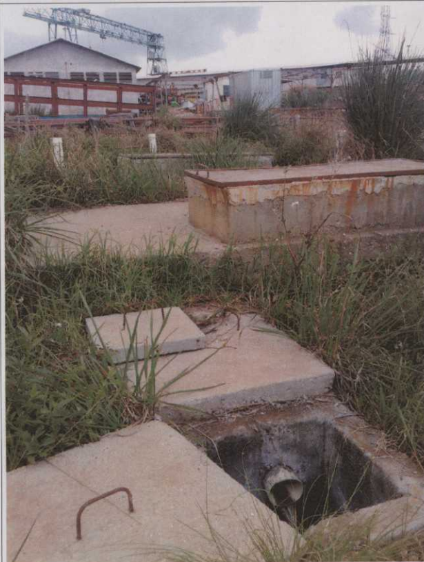
A.45. Caixa receptora de efluentes tratados na ETE temporária do Canteiro de Obras.
