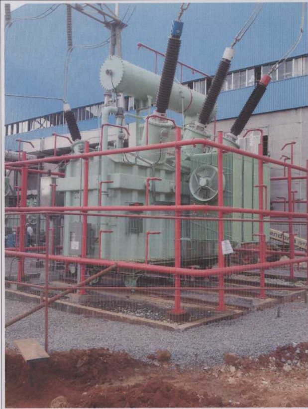
A.38. Transformador Trifásico.
