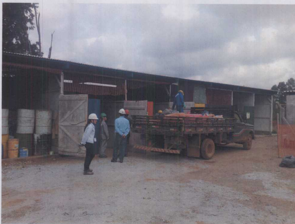
A.73. Central Temporária de Armazenamento de Resíduos Sólidos do Canteiro de Obras
