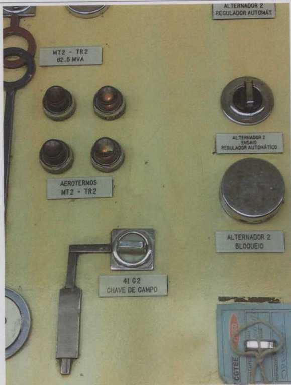
A.43. Painel da sala de controle da Fase A. Observa-se uma camada de particulados sobre o mesmo.
