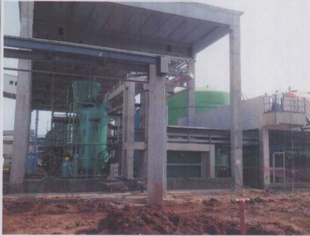
A.33. Unidade de Desmineralização de Água.
