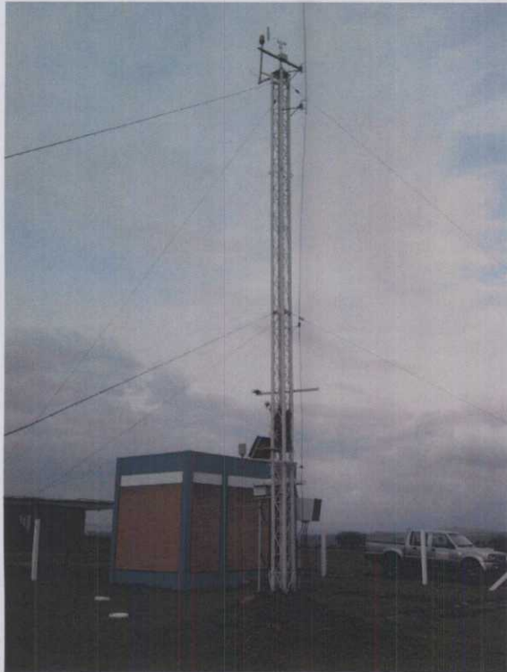
A.58. Estação de Monitoramento da Qualidade do Ar - Estação Aeroporto.
