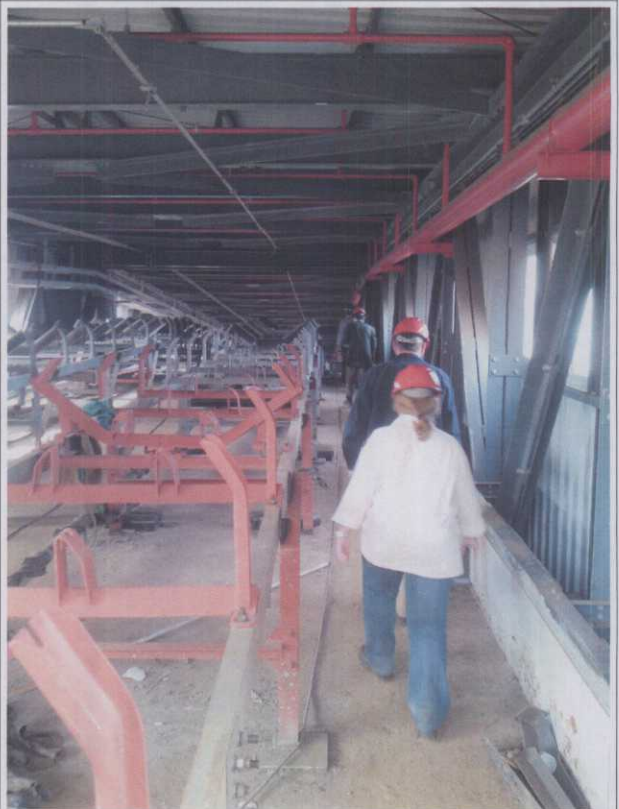
A.28. Interior do sistema de Correia de transporte de Carvão entre o Pátio de Armazenamento e a Caldeira.
