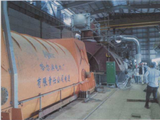
A.21. Gerador e Turbina
