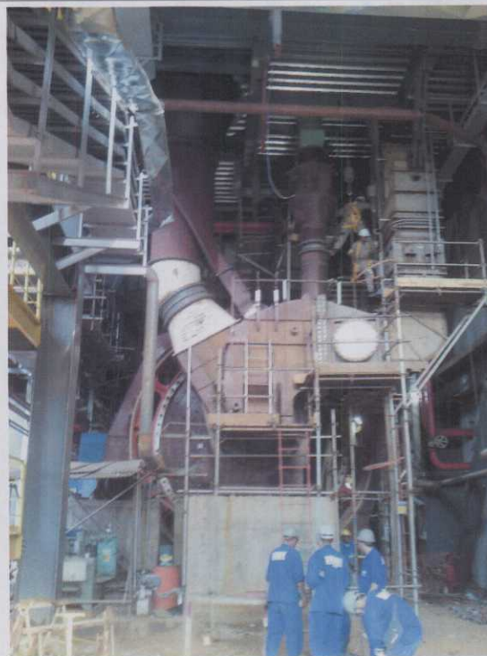
A.18. Ventilador de Ar Primário
