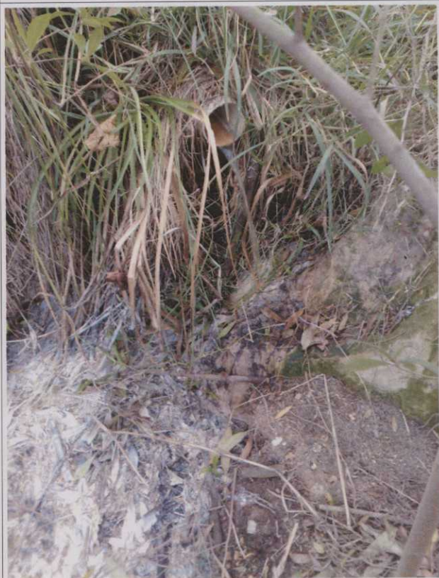
A.46. Duto emissário de efluentes tratados na ETE temporária do Canteiro de Obras.
