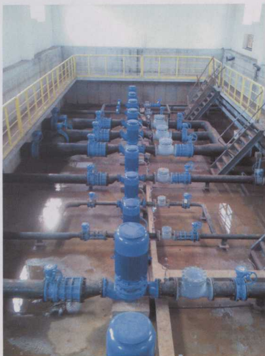
A.31. Conjunto de bombas para distribuição de água.
