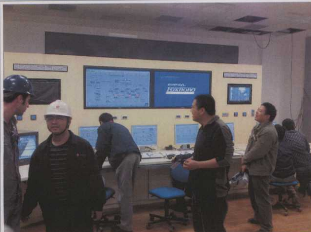
A.29. Sala de Controle.
