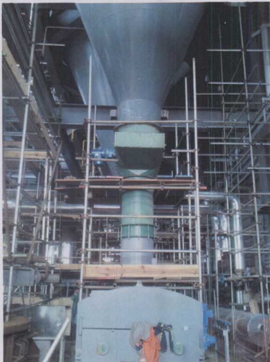
A.17. Funil de saída dos Silos de Carvão interconectado com as Mesas Alimentadoras da Caldeira.
