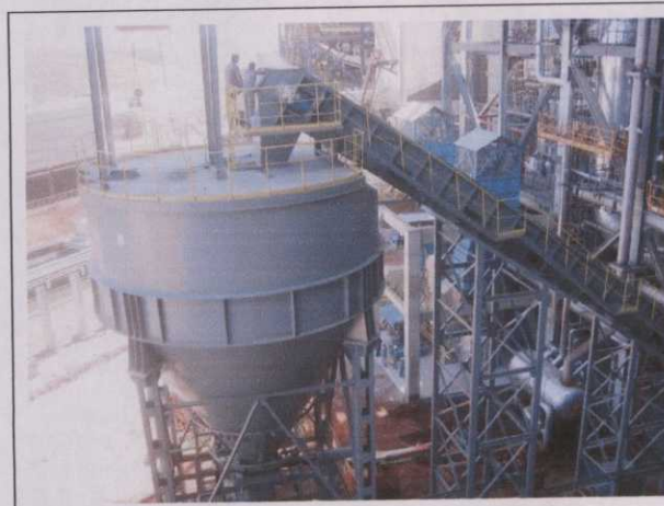
Foto 35 Silo de Cinza Pesada (vista lateral)
