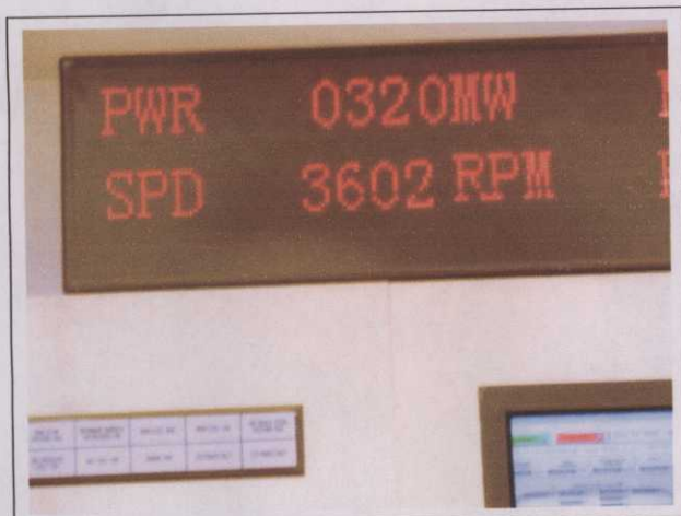
Foto 29 Painel da sala de comando principal
