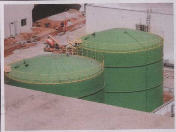
Foto 69 Tanques de água desmineralizada (tanques verdes)
