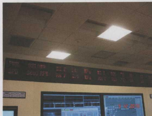
Figura 2 – Paineis da sala de controle central
