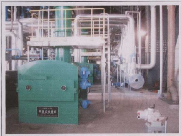
Foto 64 Coletor de vapor auxiliar (dir.)
