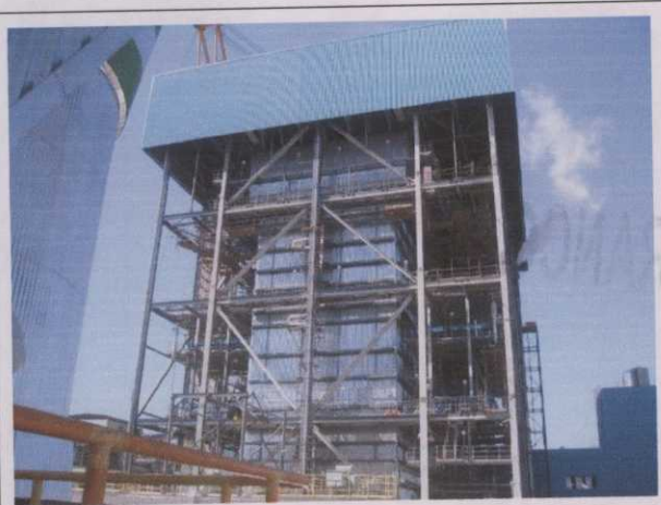
Foto 31 Caldeira - montagem concluída e em operação
