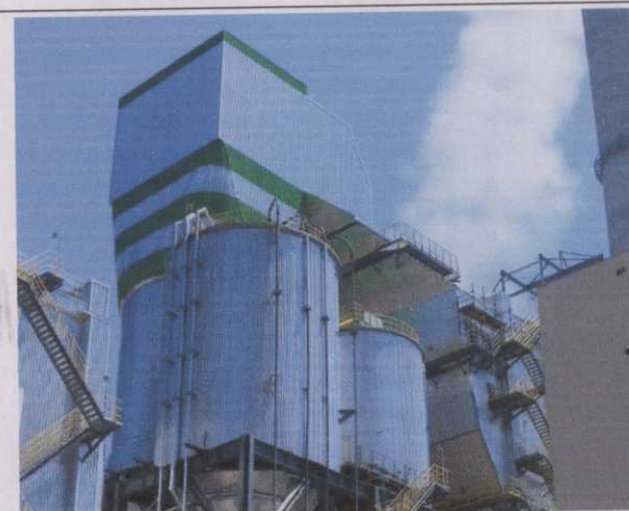
Foto 48 Dessulfurizador (1º plano) e ESP 2 (ao fundo)
