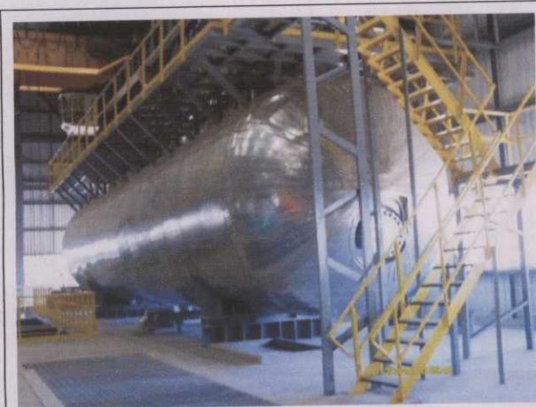
Foto 33 Desaerador montado e em operação
