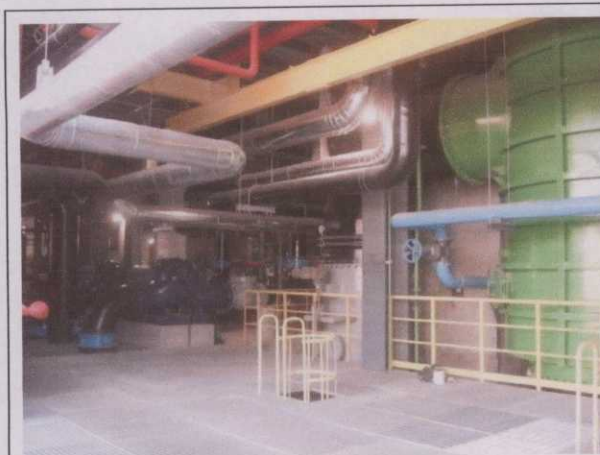
Foto 46 Tubulações Casa Máquinas, com isolamento térmico concluído
