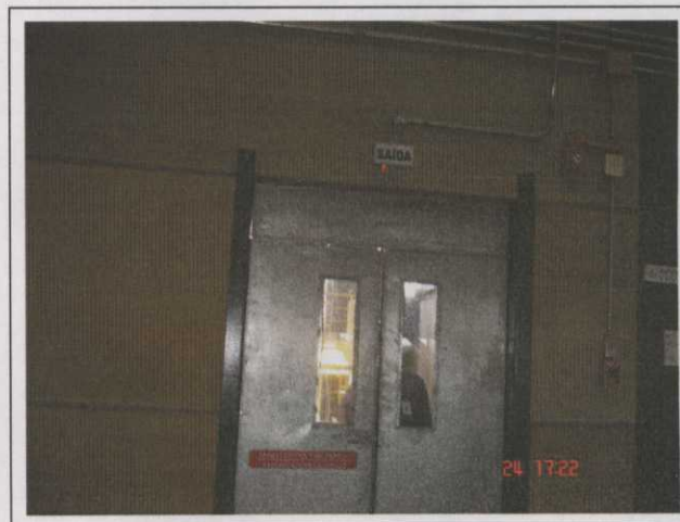
Foto 18 Prédio Central de Controle: Placa de sinalização de saída (iluminação de emergência) e porta corta fogo.
