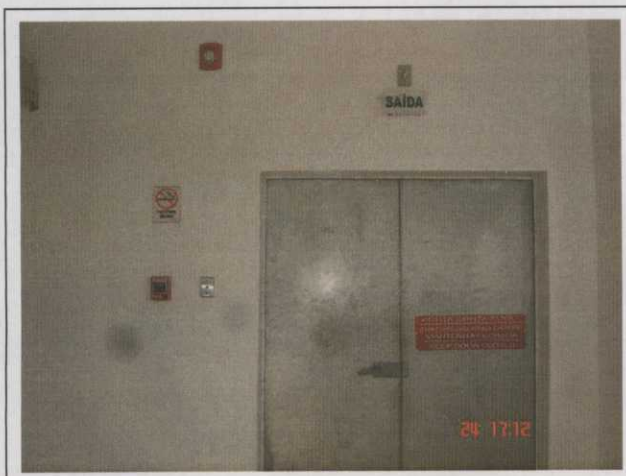
Foto 13 Prédio Central de Controle: Placa de sinalização de saída (iluminação de emergência) e porta corta fogo.
