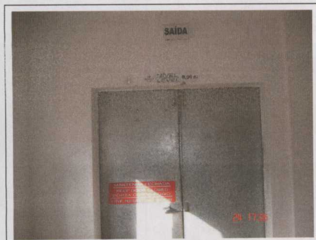
Foto 19 Prédio Central de Controle: Placa de sinalização de saída (iluminação de emergência) e porta corta fogo.
