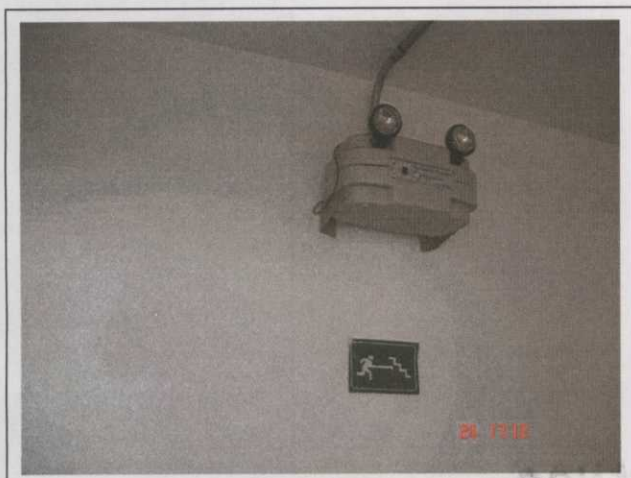
Foto 15 Prédio Central de Controle: Placa de sinalização de saída escada e iluminação de emergência.
