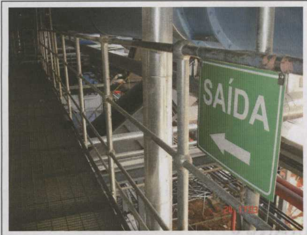
Foto 9 Caldeira:: Placa de sinalização de saída.
