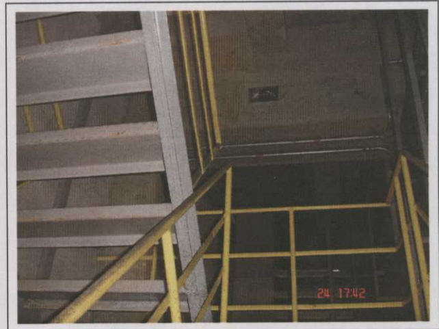
Foto 40 Sistema Carvão (britador): Placa de sinalização de saída e iluminação de emergência.
