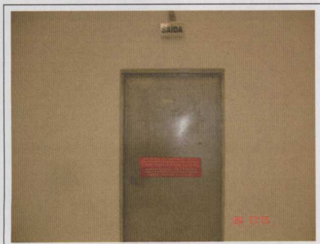
Foto 17 Prédio Central de Controle: Placa de sinalização de saída (iluminação de emergência) e porta corta fogo.
