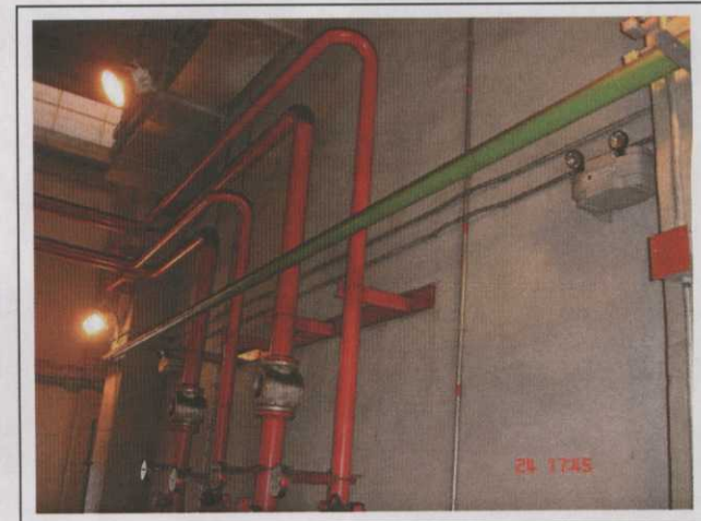
Foto 44 Sistema Carvão (britador): iluminação de emergência.
