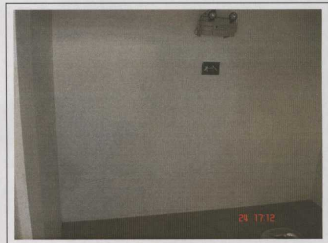
Foto 14 Prédio Central de Controle: Placa de sinalização de saída escada e iluminação de emergência.
