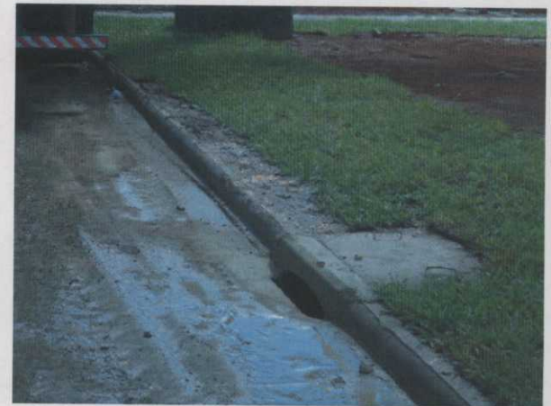
Foto 16 Drenagem superficial para escoamento das águas pluviais-boca de lobo
