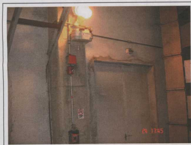
Foto 43 Sistema Carvão (britador): Placa de sinalização de saída e iluminação de emergência.
