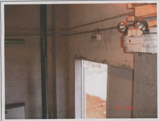
Foto 39 Sistema Carvão (britador): Placa de sinalização de saída e iluminação de emergência.
