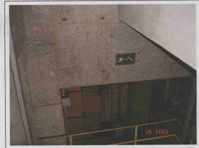
Foto 42 Sistema Carvão (britador): Placa de sinalização de saída escada.
