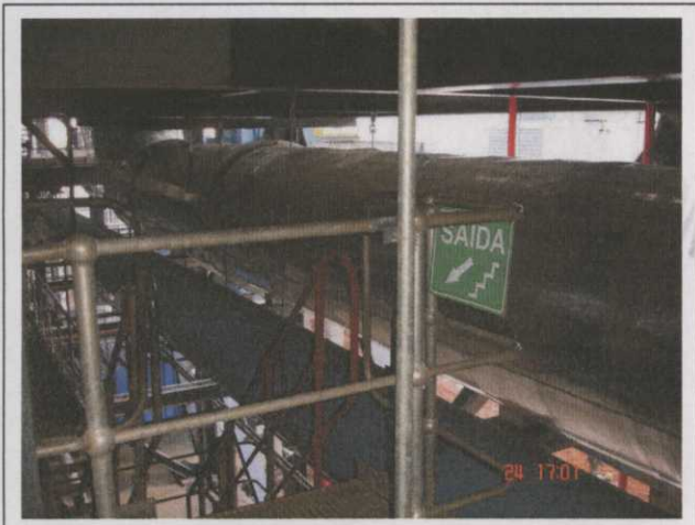
Foto 5 Caldeira:: Placa de sinalização de saída indicativo de descida de escada.
