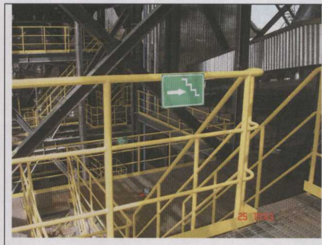
Foto 46 Precipitador Eletrostático: Placa de sinalização de saída escada.
