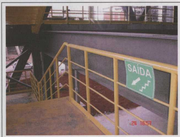
Foto 3 Casa de Máquinas: Placa de sinalização de saída indicativo de descida de escada.
