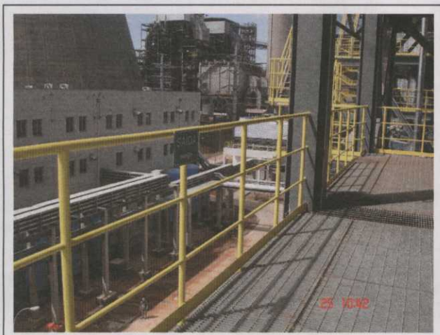
Foto 45 Precipitador Eletrostático: Placa de sinalização de saída.
