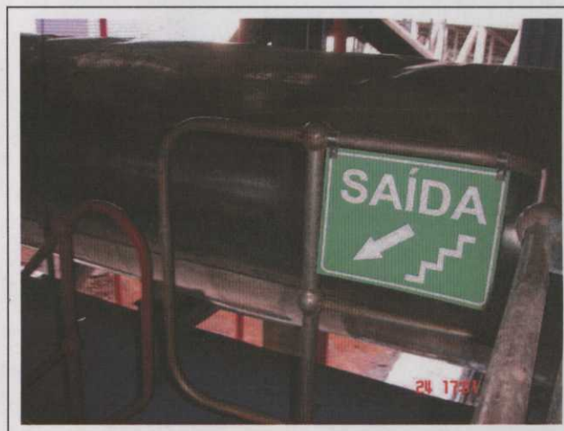
Foto 4 Caldeira: Placa de sinalização de saída indicativo de descida de escada.
