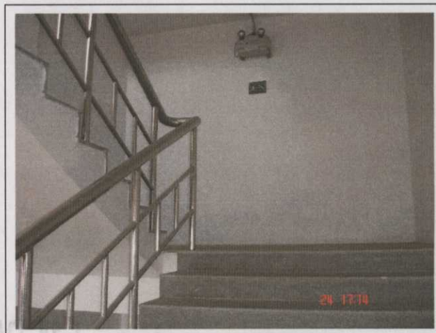
Foto 16 Prédio Central de Controle: Placa de sinalização de saída escada e iluminação de emergência.
