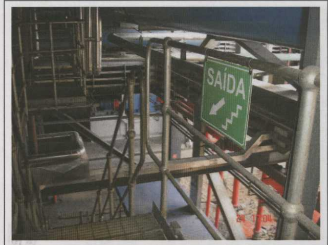
Foto 10 Caldeira:: Placa de sinalização de saída indicativo de descida de escada
