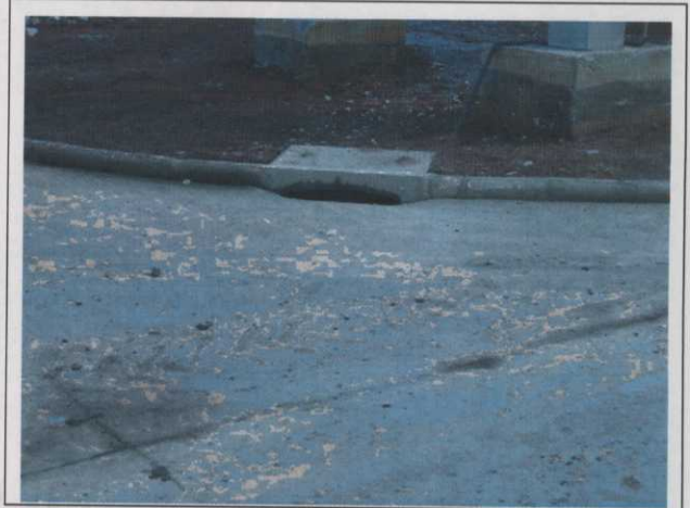
Foto 14 Drenagem superficial para escoamento das águas pluviais-boca de lobo
