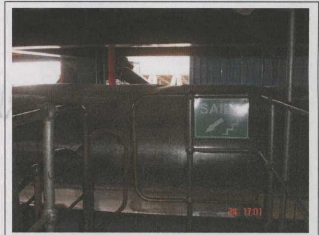
Foto 6 Caldeira:: Placa de sinalização de saída indicativo de descida de escada.
