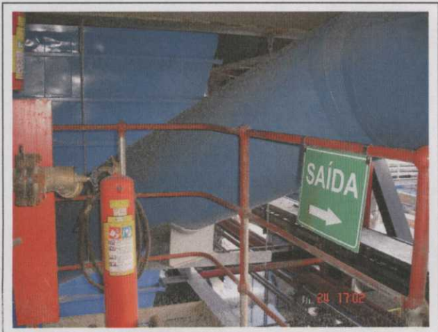
Foto 7 Caldeira:: Placa de sinalização de saída.
