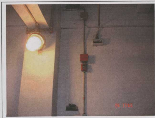
Foto 41 Sistema Carvão (britador): Placa de sinalização de saída e iluminação de emergência..
