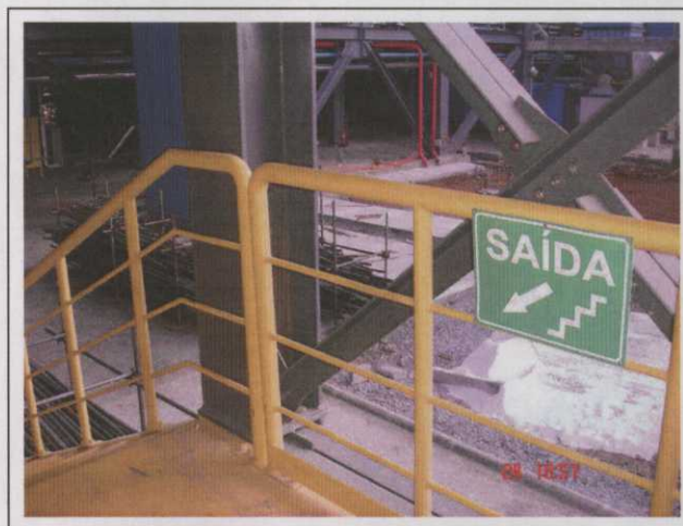
Foto 2 Casa de Máquinas: Placa de sinalização de saída indicativo de descida de escada.
