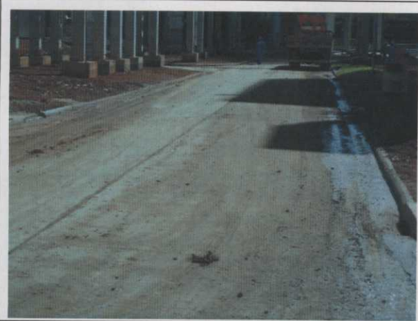
Foto 15 Drenagem superficial para escoamento das águas pluviais-boca de lobo
