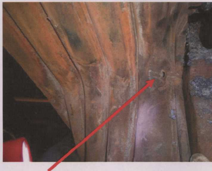
Furo junto ao queimador, 1º nível do canto 1 da caldeira
