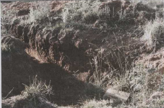
33 - Ponto de rompimento da adutora.
