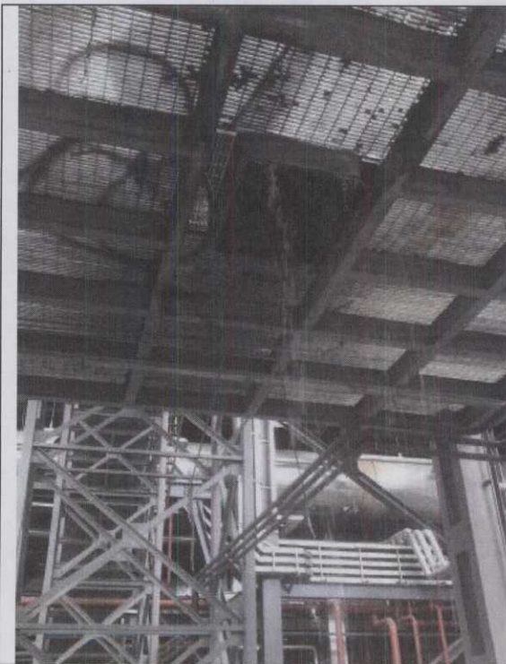
81 - Vazamentos de água provenientes do processo de coleta de cinzas de fundo
