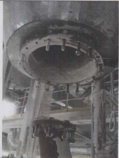
48 - Vazamento das cinzas
