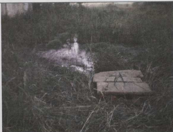
18 - Fossa séptica que ainda não foi desativada
