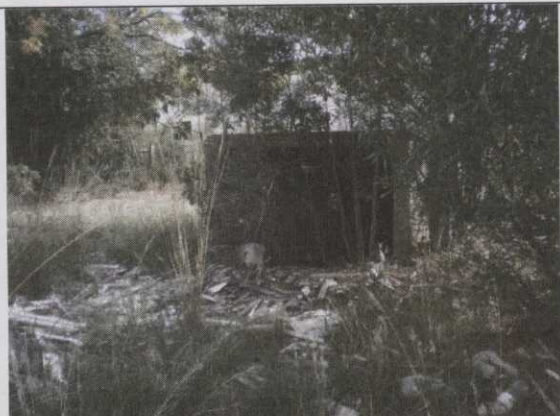
17 - Passagem da correia transportadora de carvão para os silos
