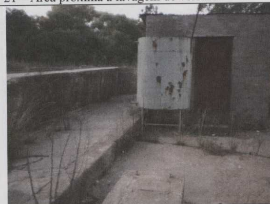
23 - Tanque de filtro de diesel
