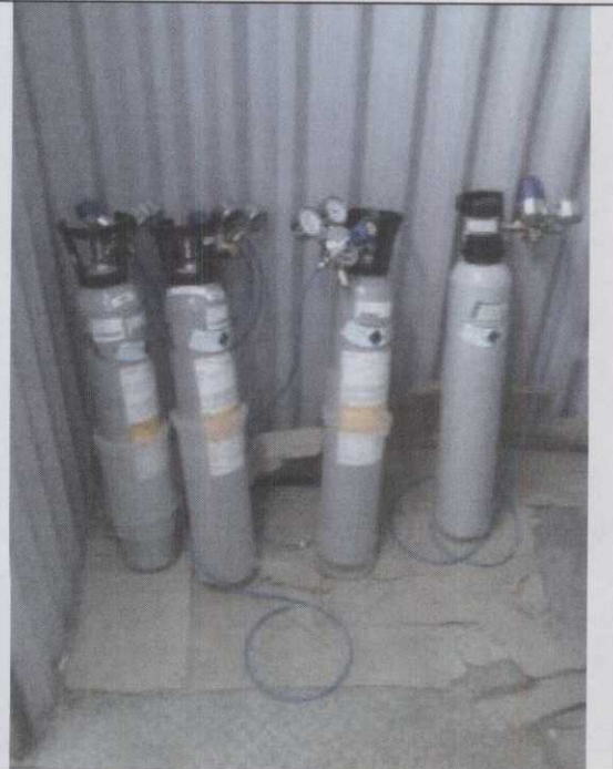
71 - Gases de calibração ao sistema de monitoramento
