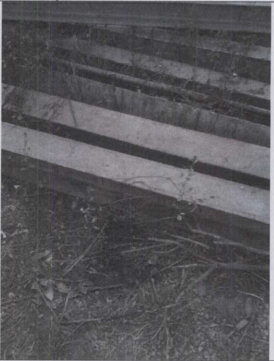
128 - Manchas de óleo
