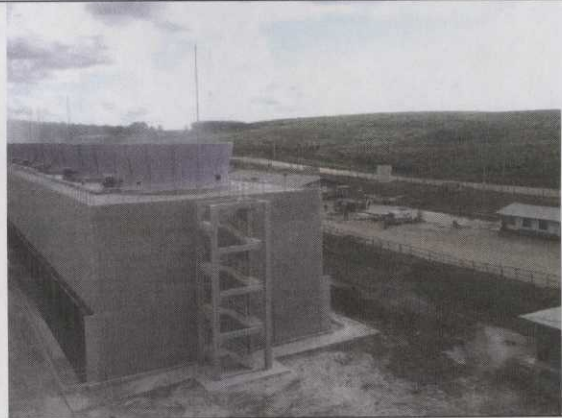
54 - Vazamento das cinzas
