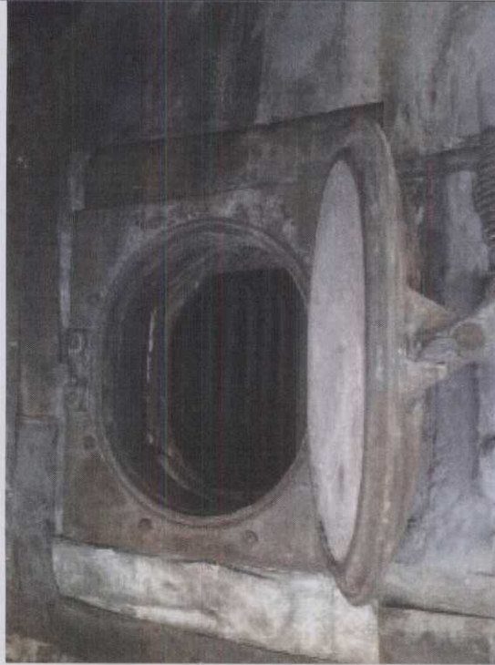
174 – Entrada da caldeira
