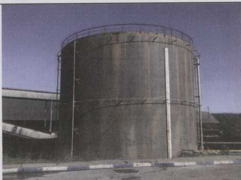
169 – Área de tancagem de 5 000 m 3 de óleo combustível
