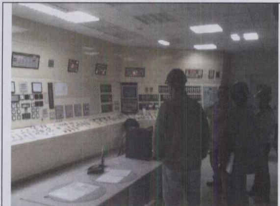
148 - Sala de controle da Fase A
