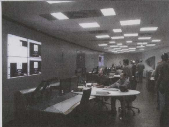
151 - Sala de controle da Fase B
