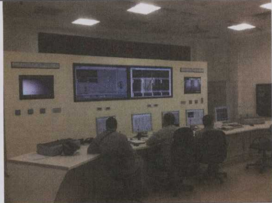
83 - Sala de Comando da Fase C
