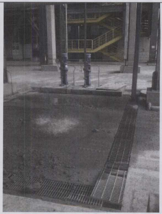
82 - Vazamentos de água provenientes do processo de coleta de cinzas de fundo
