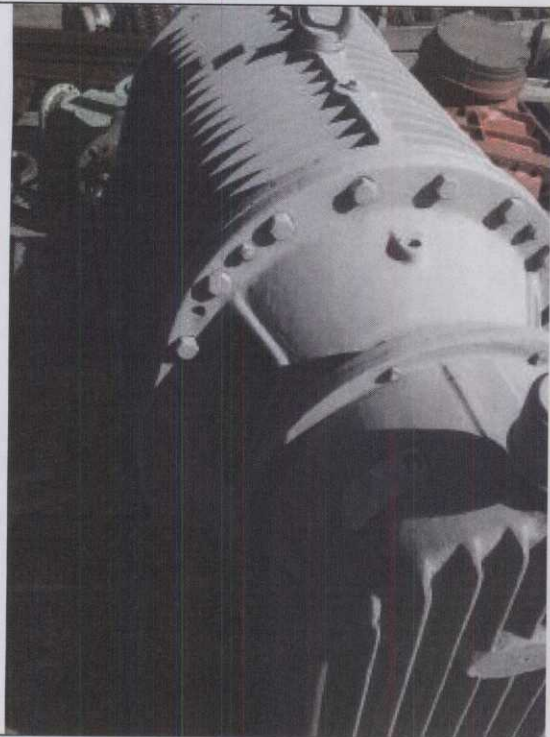
211 - Capacitores e motores
