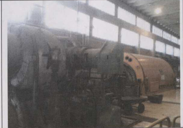
139 A 145 - Sala dos geradores e turbinas das Fases A e B
