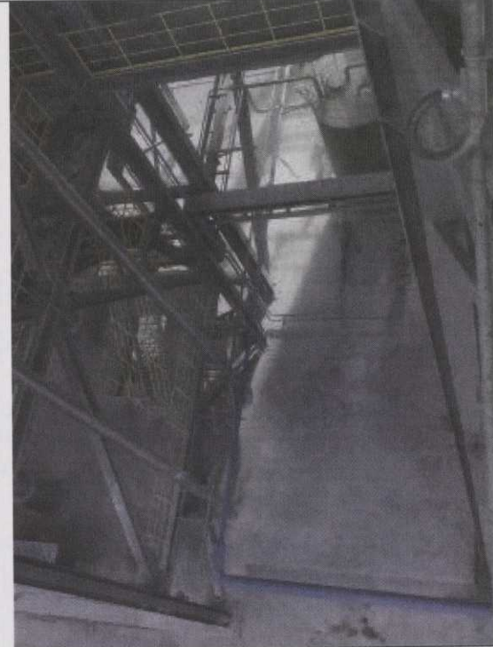
56 - Vazamento das cinzas
