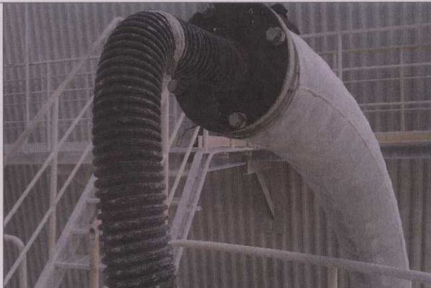
Figura 14: Sucção de cal para fora do silo
