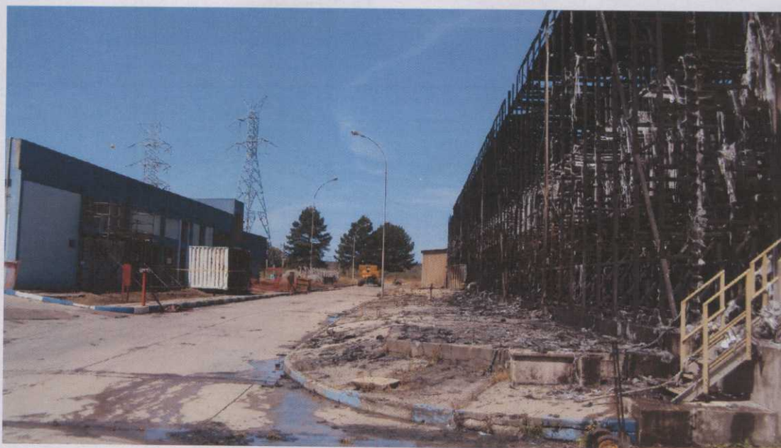
Foto 2: Visão lateral-frontal da torre queimada, com resíduos ao chão.
