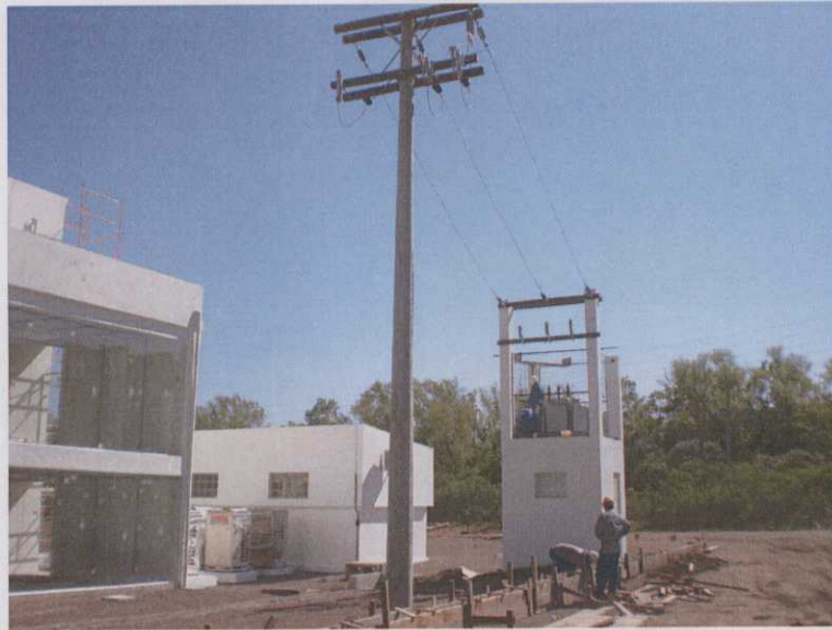
Foto 01 – Vista Externa – Subestação
