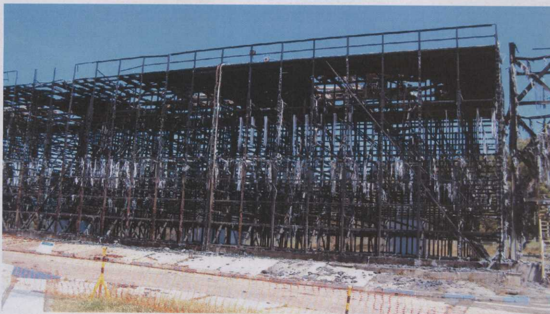
Foto 1: Visão frontal de parte da torre queimada.
