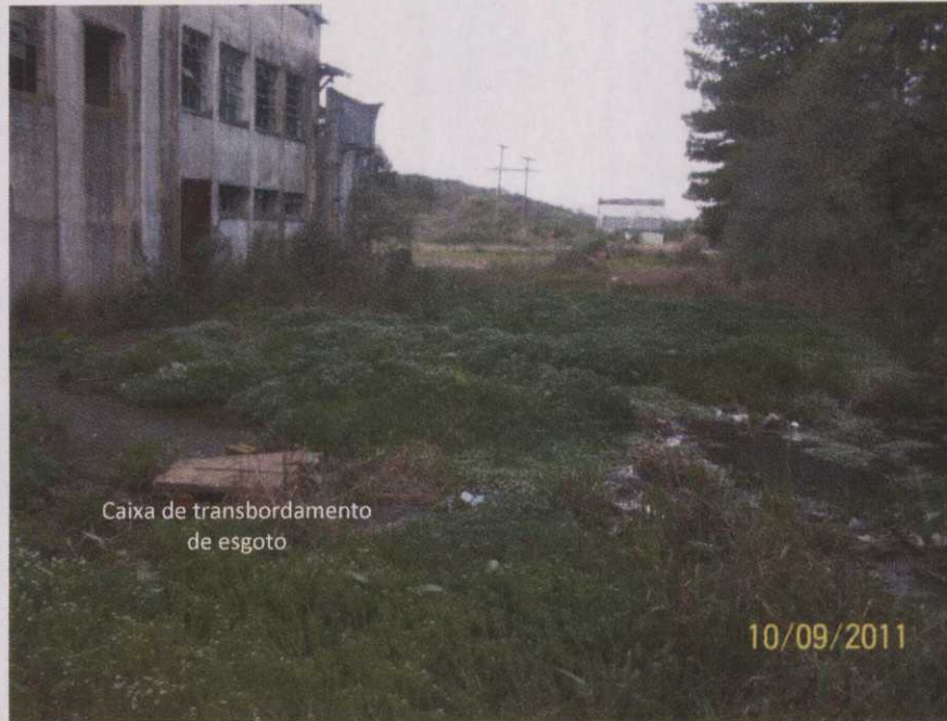
Figura 30. Aspecto da área afetada pelo transbordamento de esgoto cloacal, junto a parede sudoeste da edificação da antiga Usina.
