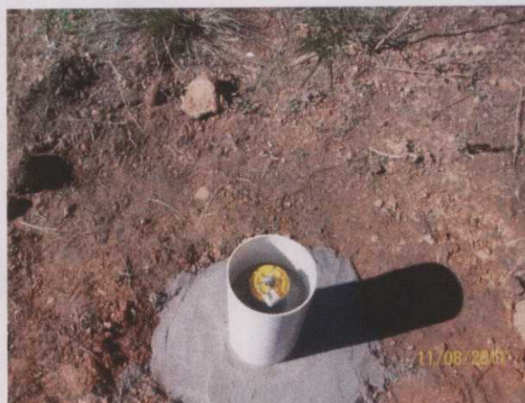
Figura 13 Vista do poço PMC2
