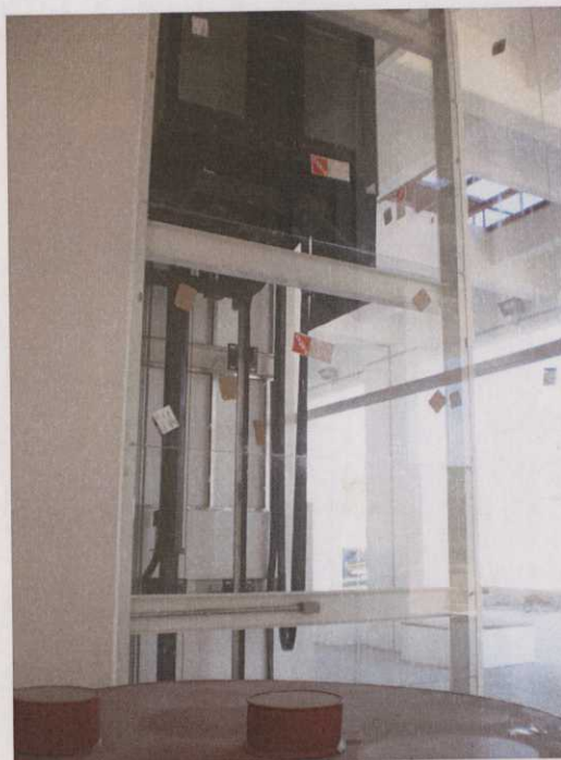
Foto 11 – Vista Interna Elevador Panorâmico nível 0,00 m
