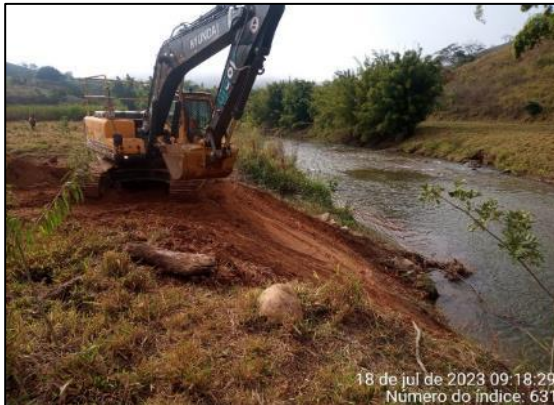
Local a ser instalado.
