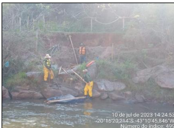
Local a ser instalado.
