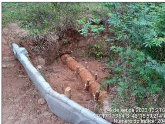
Biorretentor de fibra de coco.
