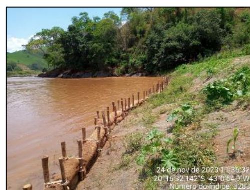
Bioretentores de sedimentos.
