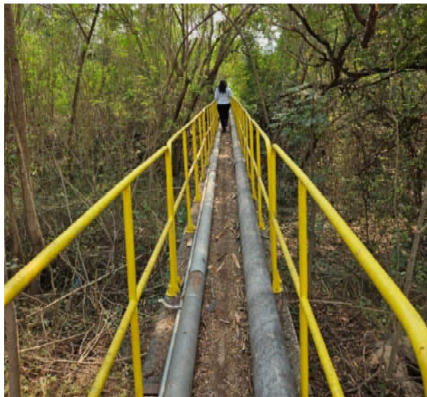
Figura 4 – Passarela de suporte da linha de recalque Fonte: HIDROBR (2024)
