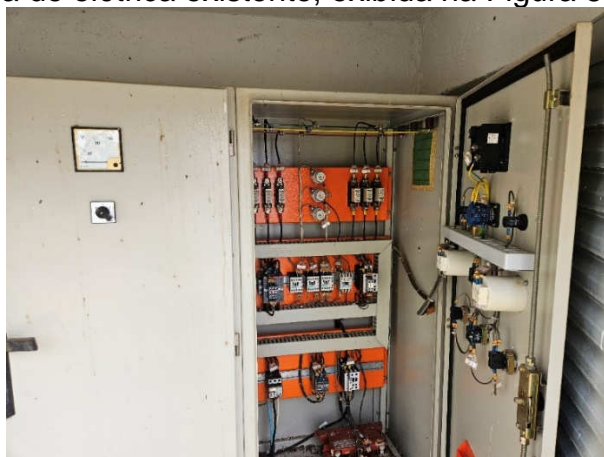
Figura 5 – Painel elétrico Fonte: HIDROBR (2024)
