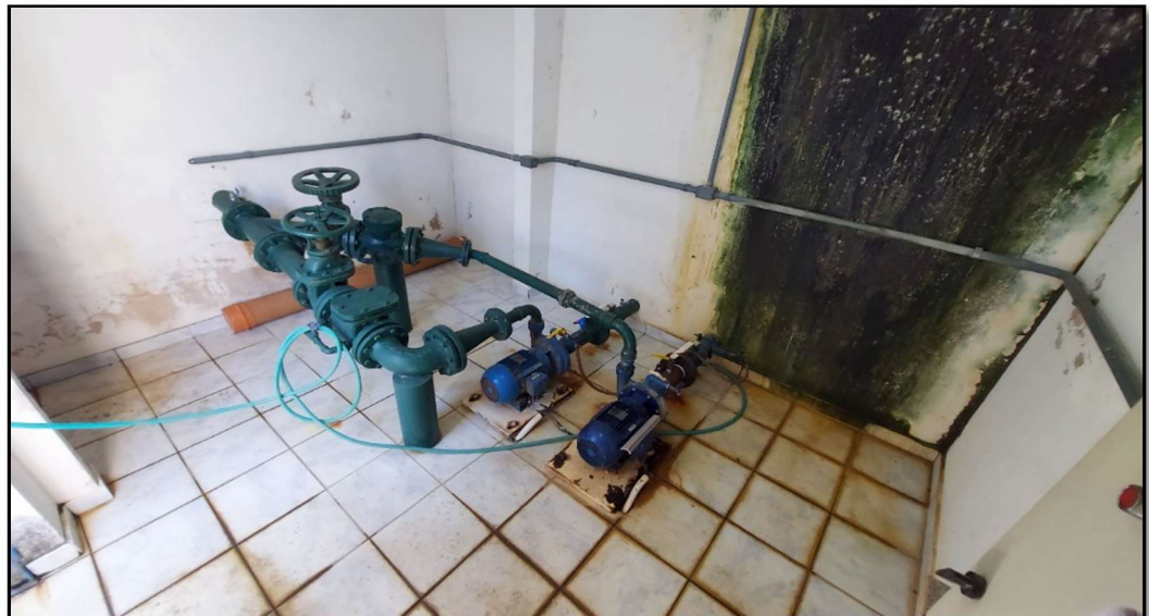
Figura 79 – Elevatória de Água Tratada – Barrilete
