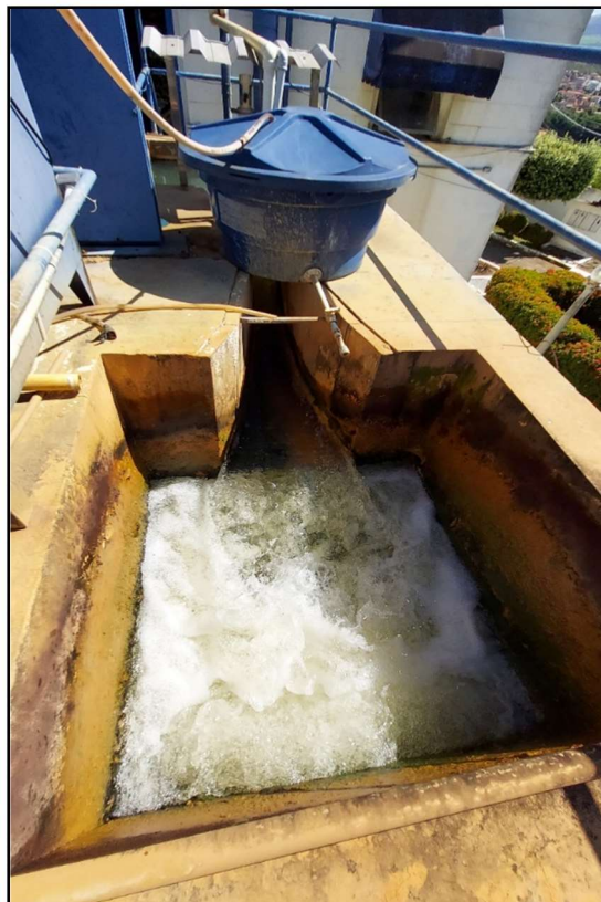
Figura 36 – Ponto de Dosagem da Cal Hidratada e do Tanfloc
