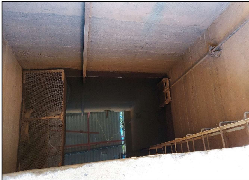
Figura 13 – Interior da Caixa de Captação do Nível Mais Raso
