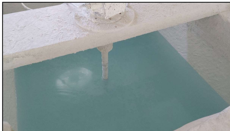
Figura 59 – Vista do Tanque de Preparo de Cal
