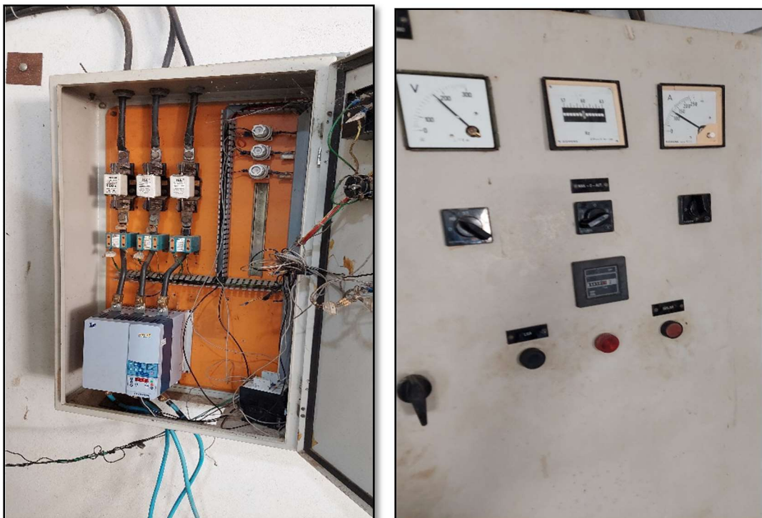
Figura 24 – Quadros Elétricos do Motor de 40 cv
