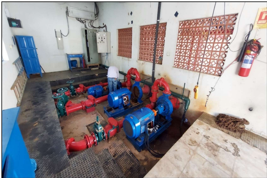
Figura 17 – Vista Geral da Casa de Bombas
