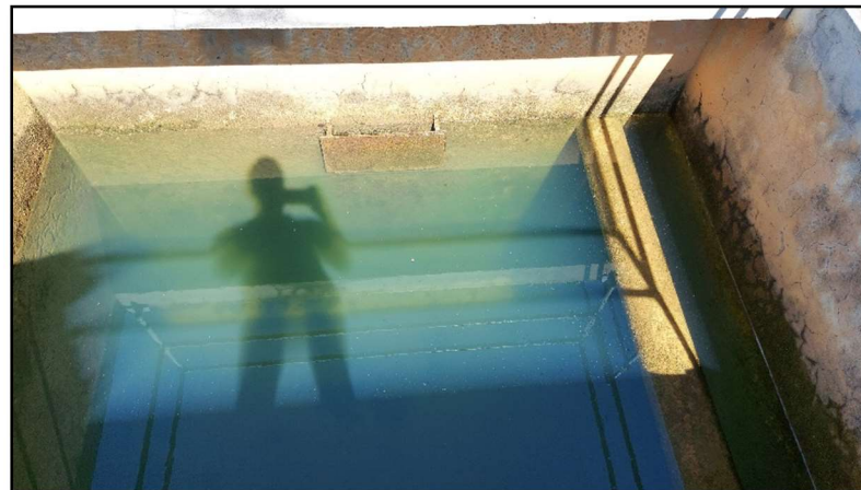
Figura 50 – Interior do Filtro Novo
