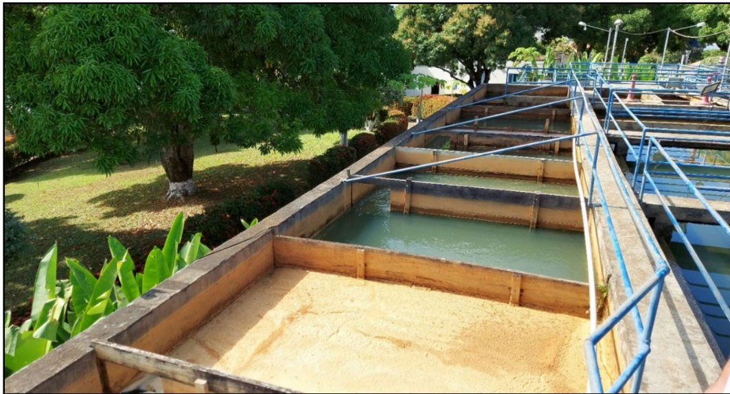
Figura 37 – Flocculador Hidráulico – Vista Frontal
