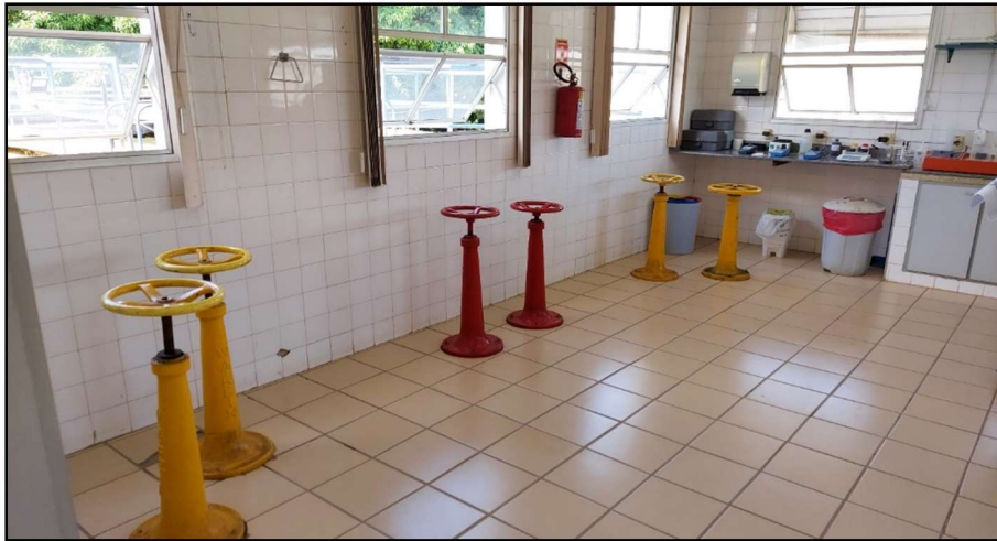
Figura 47 – Volantes de Operação dos Filtros Antigos
