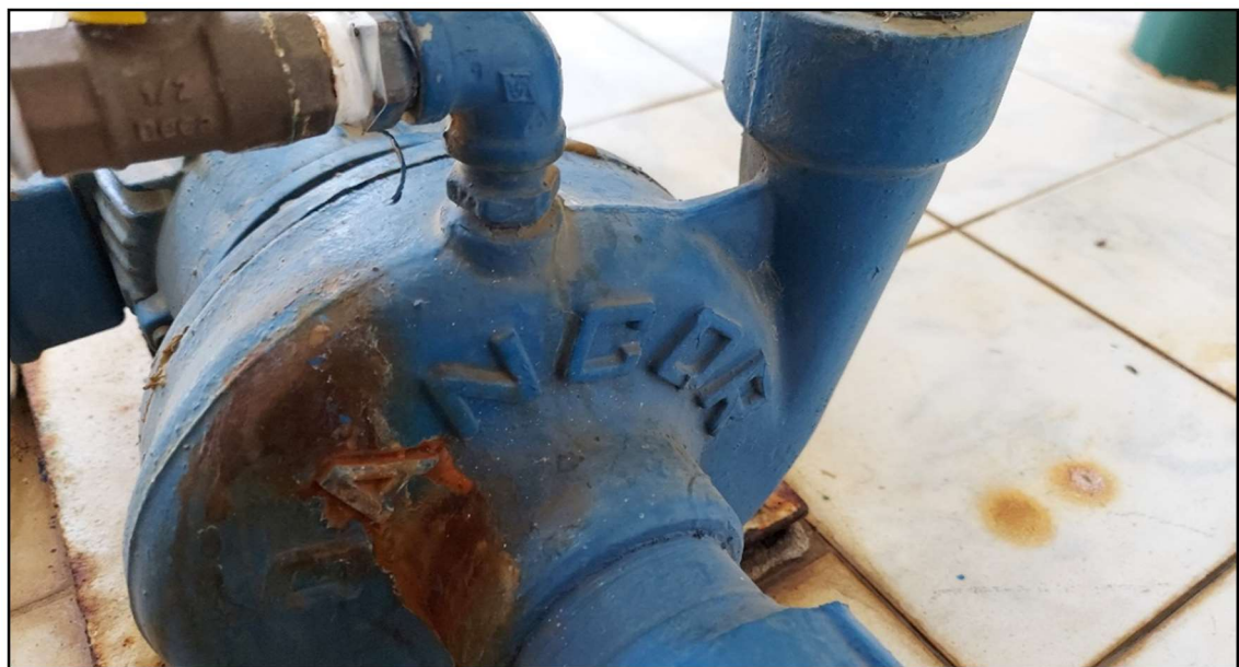
Figura 81 – Detalhe do Conjunto Motobomba
