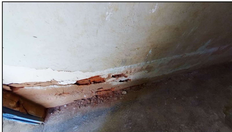
Figura 67 – Almoxarifado – Trincas e Infiltrações
