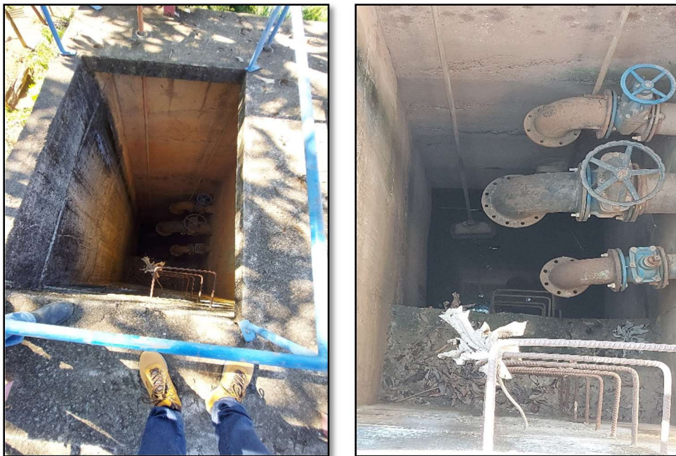
Figura 15 – Caixa de Recepção da Captação Emergencial do Rio Guandu
