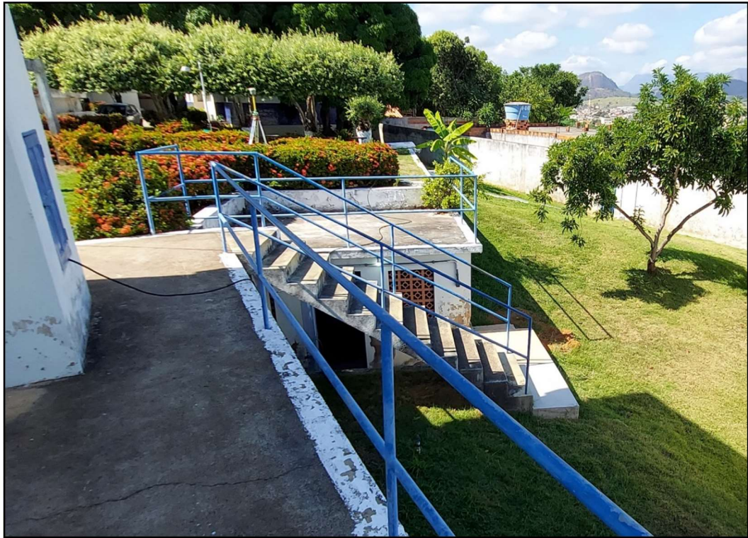
Figura 78 – Vista Exterior da Elevatória de Água Tratada
