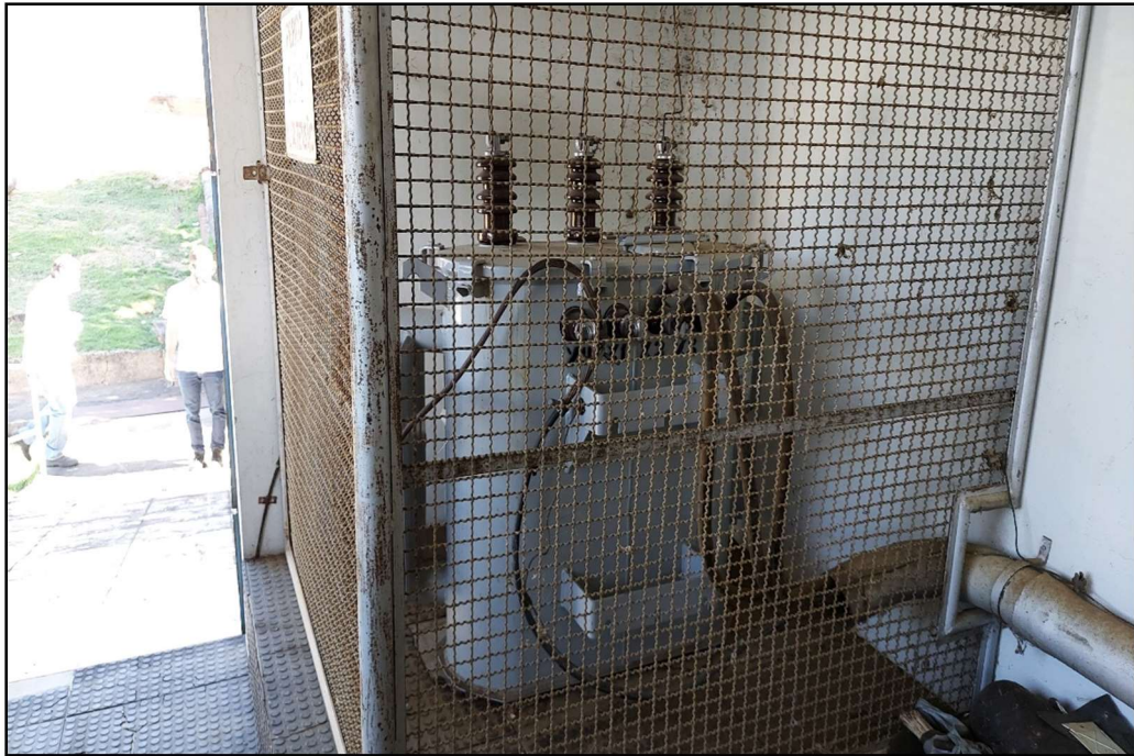
Figura 29 – Transformador de 150 kVA Protegido por Grade
