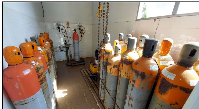
Figura 64 – Cômodo do Sistema de Gás Cloro
