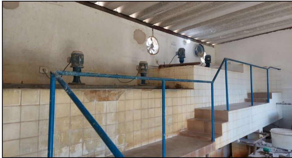
Figura 54 – Vista dos Tanques de Preparo de Soluções e Suspensão
