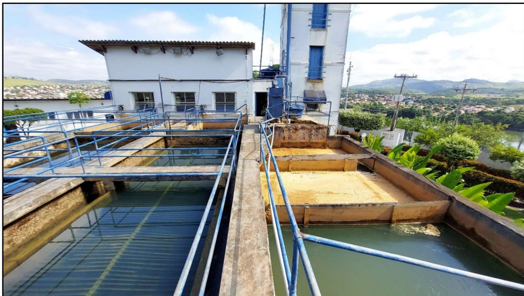
Figura 38 – Flocculador Hidráulico – Vista Posterior
