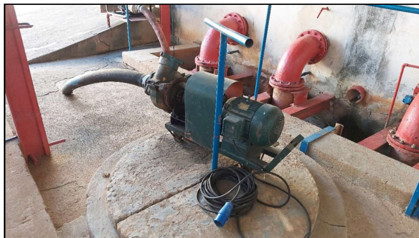
Figura 14 – Poço de Manobra da Captação Mais Profunda
