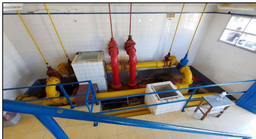
Figura 46 – Barrilete de Manobras dos Filtros Antigos
