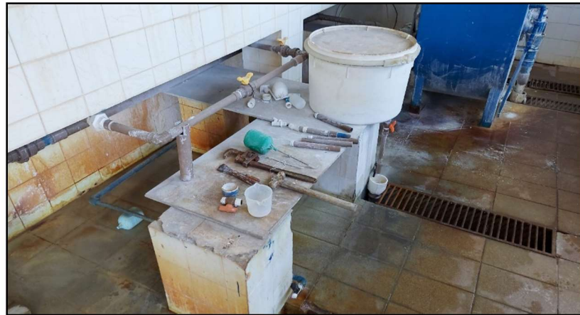
Figura 57 – Detalhe do Tanque de Nível Constante para Dosagem do Flúor
